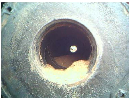
Figura 5-6 – Duto de sucção de ar e serragem.
