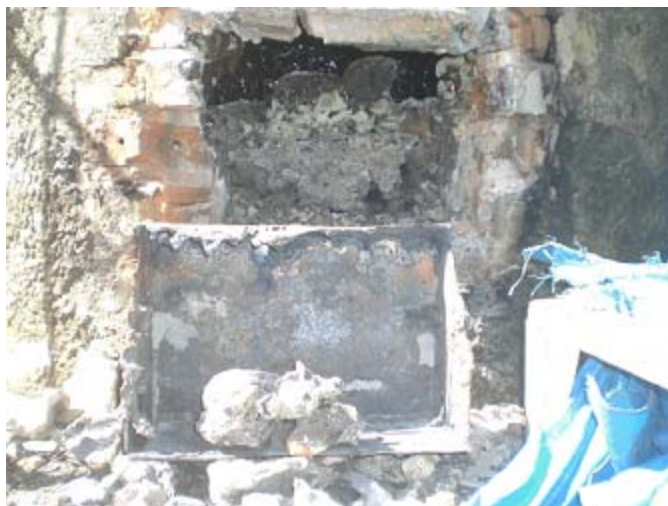
Figura 6-9 – Janela de inspeção inferior destruída após uma queima.
