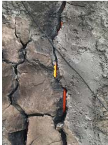
Figura 6-7 – Rachadura na parede da câmara durante a queima.
