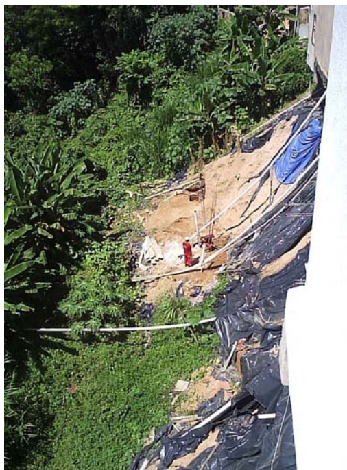
Figura 23: Degradação das áreas verdes atrás do Conjunto Colinas de Pituaçu (abr. 2007)
