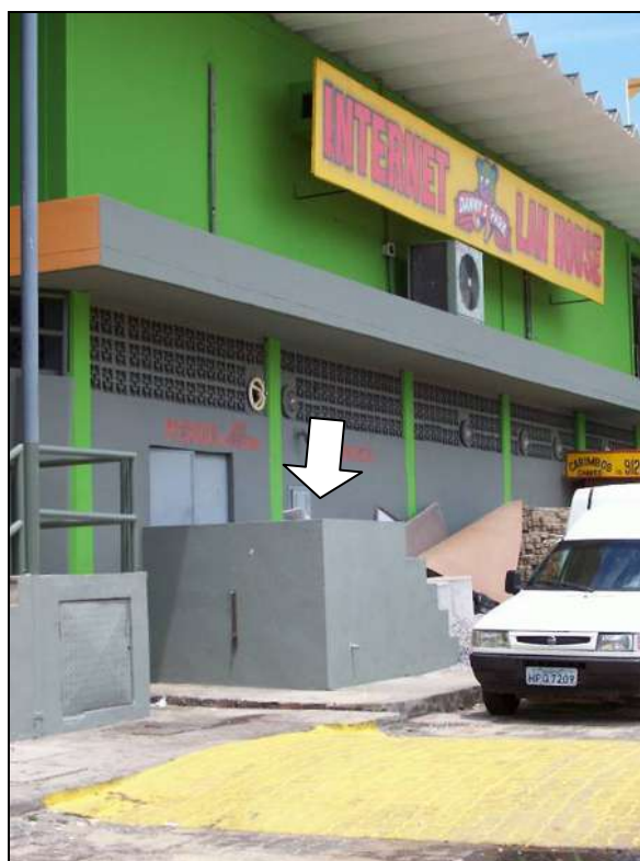
Figura 081 – Ponto 15 – Obstáculo construtivo para evitar que a água tenha contato com a subestação de energia do shopping .
