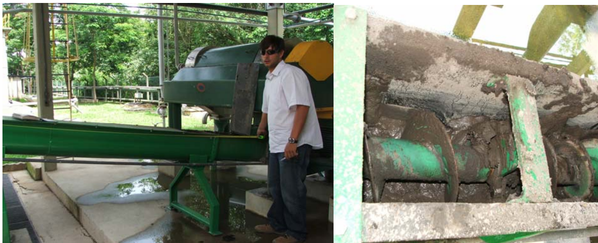
Figura 21 – Imagens da rosca de transporte. Respectivamente cobertura em aço e parte interna com a rosca transportando o lodo.
