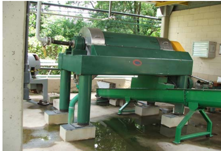
Figura 17 – Centrífuga utilizada para o desaguamento.
