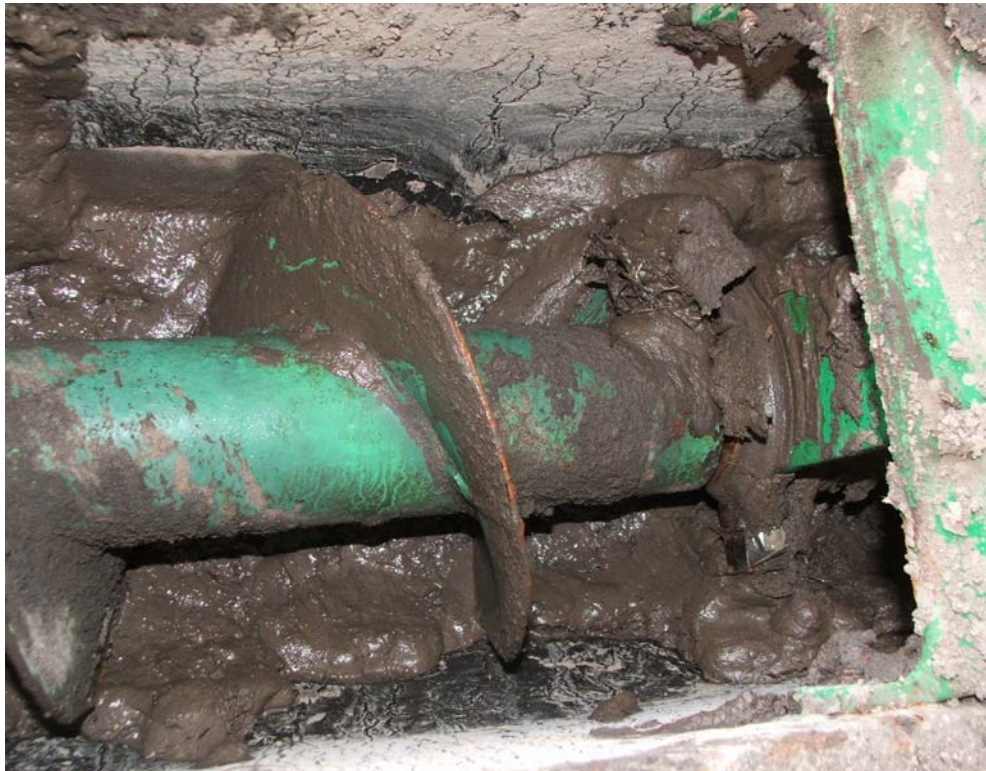
Figura 23 – Espessura do lodo ao fundo da rosca de transporte.
