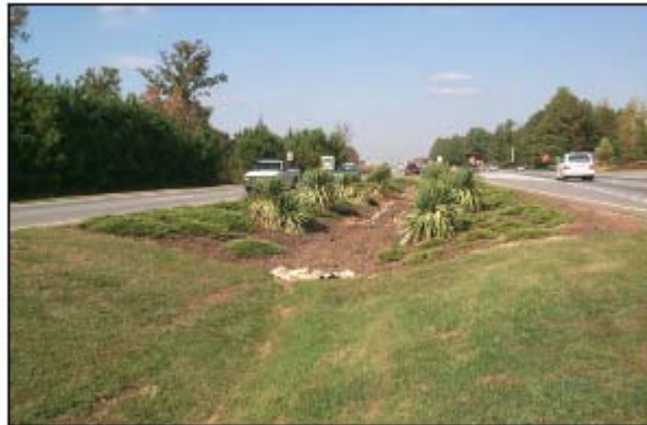
Figura 3.33 - Valo de Infiltração (AMEC, 2001).
