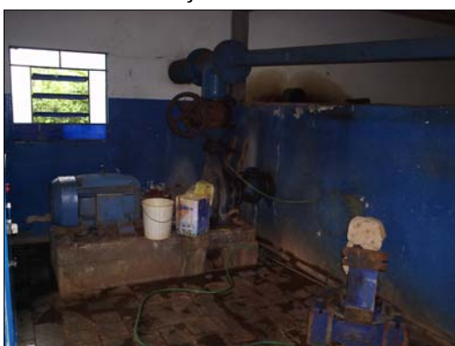
Figura 4.5 – Interior da estação elevatória do Horto Florestal
