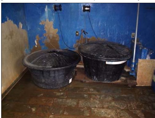
Figura 4.6 – Equipamentos para a cloração
