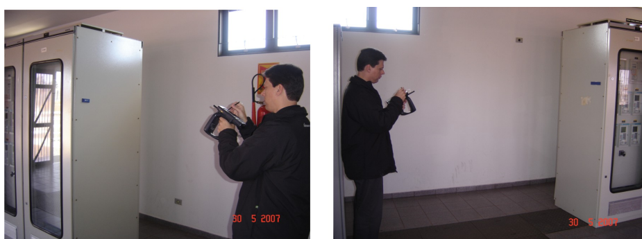
Figura 5.2: Casa de Comando (Subestação Modelo)
