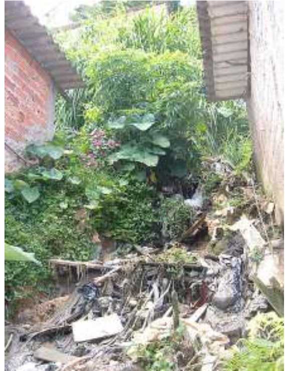
Foto 2: Vista de cota superior, lixo e entulho despejados na encosta.
