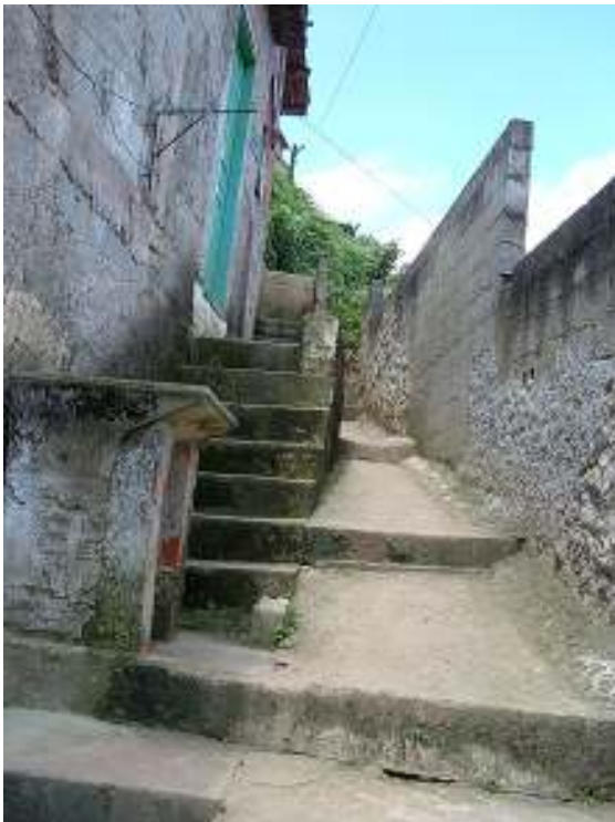
Foto 3: vista de escadaria na parte posterior da Ocupação. Muros de arrimo improvisados.
