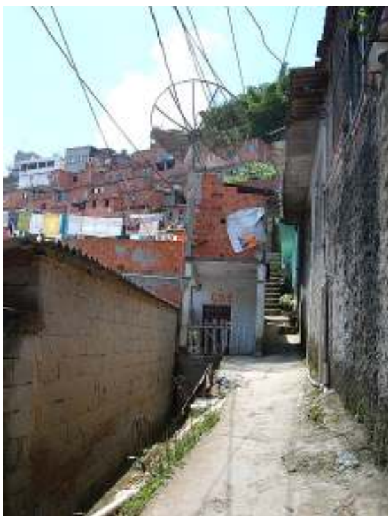
Foto 5: Vista de viela na parte posterior. Ligações clandestinas de energia.
