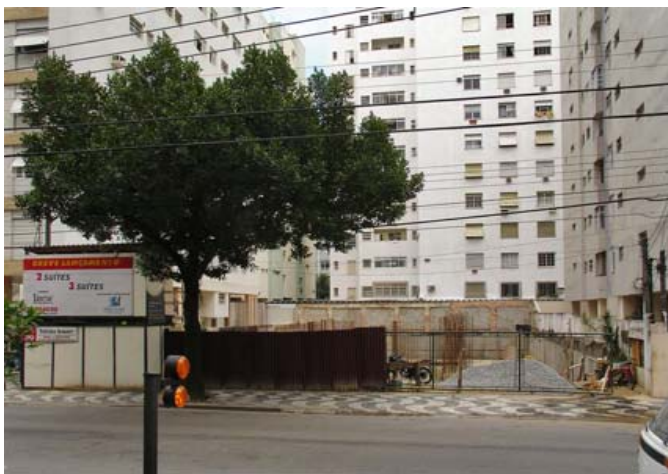
Figura 55 – Rua Galeão Carvalhal e o terreno onde se encontrava o palacete mais bonito da cidade, segundo descrição da cronista Lydia Federici. O estágio pouco avançado das obras da nova construção levam a crer que a demolição da casa é recente. Fotografia de M. Monte Mór, em setembro de 2007.
