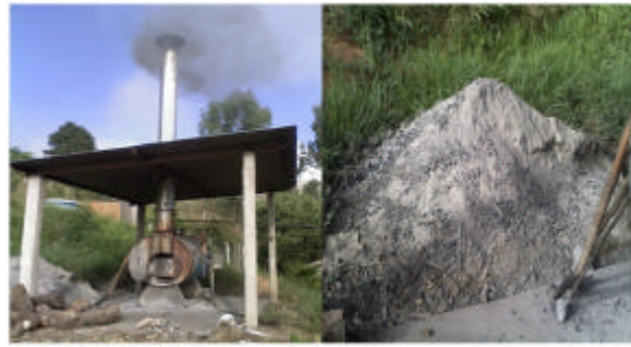
Figura 2 – Caldeira do laticínio e depósito de cinzas.
