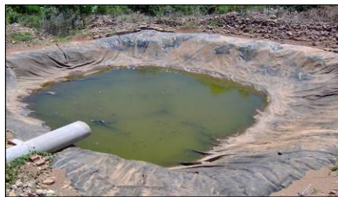
Figura 19- Tanque de percolado.
