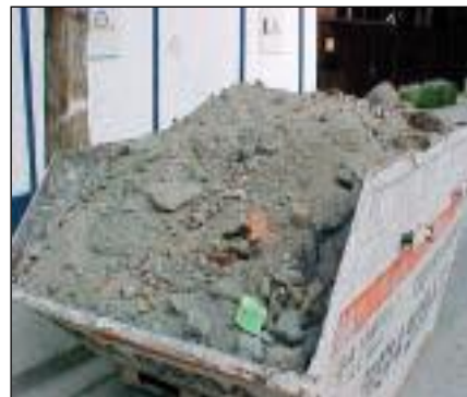
Figura 05- Caçambas estacionárias. Fonte: Pinto, 2005.
