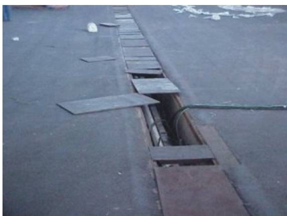
imagem 5-2 As canaletas de serviço
