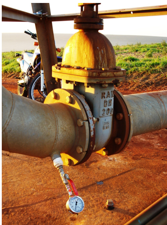
Figura 18. Verificação da pressão no tubo de subida do pivô central.
