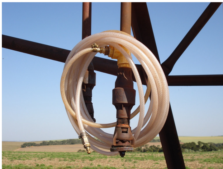
Figura 19. Verificação da pressão na extremidade do pivô central.
