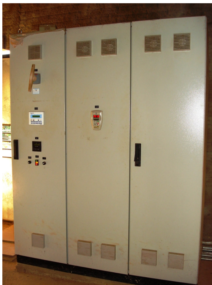
Figura 9. Quadro de comando do inversor de frequência.
