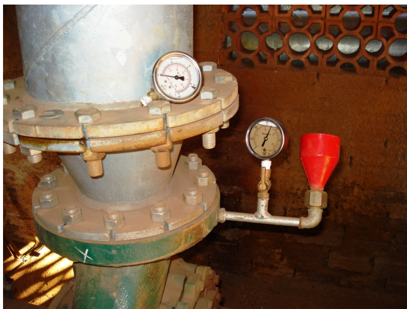
Figura 17. Verificação da pressão na saída do conjunto motobomba.
