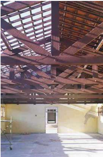
Ilustração 71 – Foto da restauração do telhado do refeitório da Colônia Azevedo Soares (foto do Autor – 1998)
