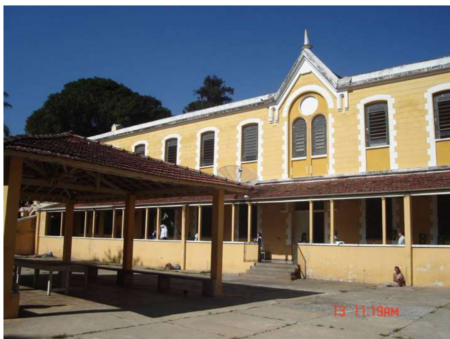
Ilustração 110 – foto do pátio com vista para a fachada interna do pavilhão – verificar a perda da estrutura metálica da galeria (foto do autor – 2006).
