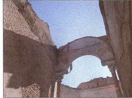
VISTA DA ABÓBODA DE BERÇO EM ESTUQUE APÓS INCÊNDIO (foto do próprio autor)
