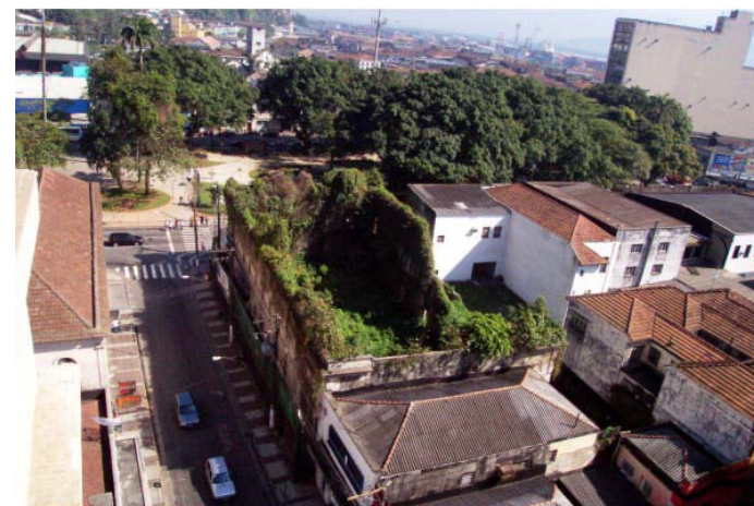
Figura 39 e 40: Fotos do Teatro Guarani arruinado em 2004, quando foi desapropriado pela prefeitura. Foto de Francisco Arrais (SECOM - Secretaria de Comunicação). Fonte: Memorial Descritivo gentilmente cedido pela SEPLAN.
