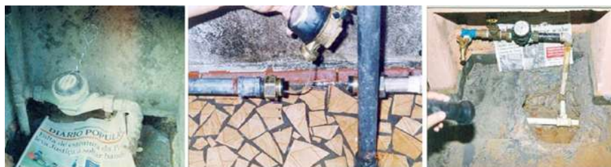
Fig. 36 - Tipos de fraude em hidrômetros: (1) cúpula perfurada, (2) turbina travada, (3) by pass. Fonte: SABESP-OLIVEIRA (2006).
