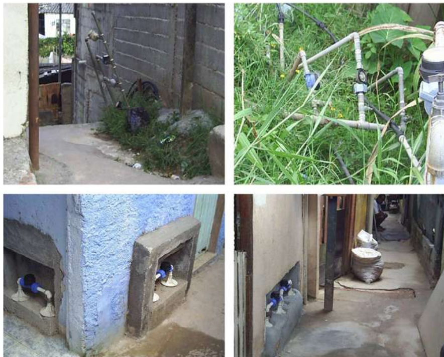
Fig. 39 - Acima, duas imagens de cavaletes de ligação tipo favela e de economias irregulares; abaixo, situação de cavalete de ligação e economia cadastrada. Fonte: SABESP-LORENZI (2006).
