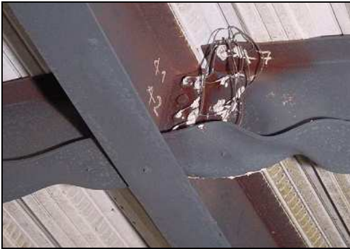
(a) viga danificada – REAL (2004)
