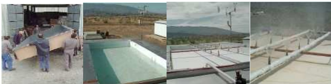
Fig. 50: Etapas da instalação experimental do tanque d'água com sistema de aspersão de água, em Almeria, Espanha. (Fonte: YANNAS; ERELL; MOLINA, 2006)
