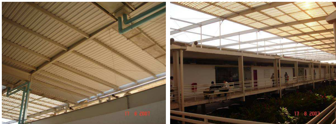
Fig. 135: Vistas internas da cobertura metálica do Fórum de Cuiabá. (Foto: Büttner, S.)
