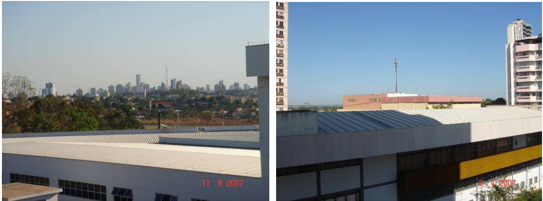
Fig. 130 e Fig. 131: Assembléia Legislativa e Moitará Sebrae Center, respectivamente: telhas metálicas. (Foto: Büttner, S.)
