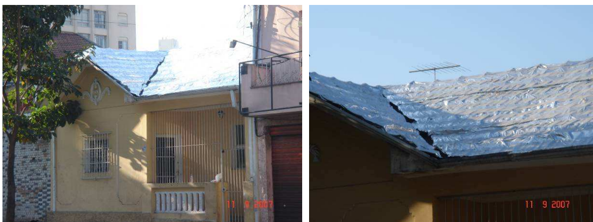
Fig. 36 (esq.) e Fig. 37 (dir.): Residência em Pinheiros -SP: Exemplo de aplicação equivocada da barreira radiante, que deve ser instalada do lado interno da cobertura. (Foto: Büttner, S.)
