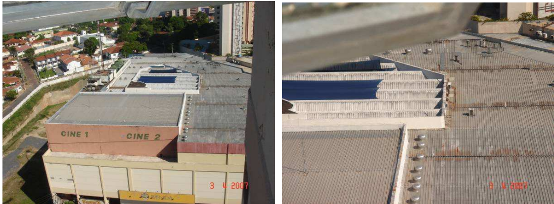
Fig. 137: Shopping Goiabeiras: Cobertura metálica sem isolante e alto consumo de energia elétrica com o sistema de ar condicionado. (Foto: Büttner, S.)
