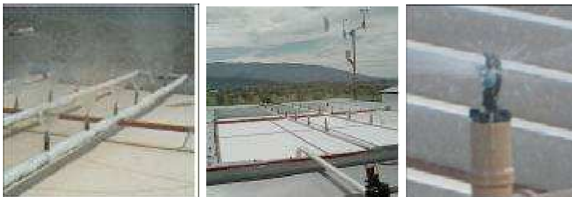
Fig. 196: Sistema de dutos e aspersores instalados na cobertura, com detalhe do sprinkler
