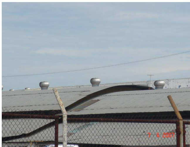
Fig. 115: Cobertura metálica convencional, com exaustores, no Shopping popular – camelódromo, localizado na av. Carmindo de Campos. (Foto: Büttner, S.)
