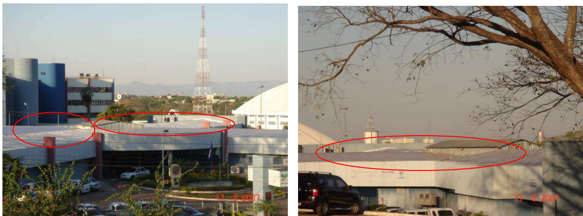
Fig. 124: Secretaria de Fazenda do Estado de Mato Grosso, exemplo de aplicação incorreta da barreira radiante.
