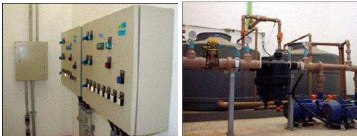
Fig. 197: Painel de comando e vista do Reservatório, bomba, filtro e registros
