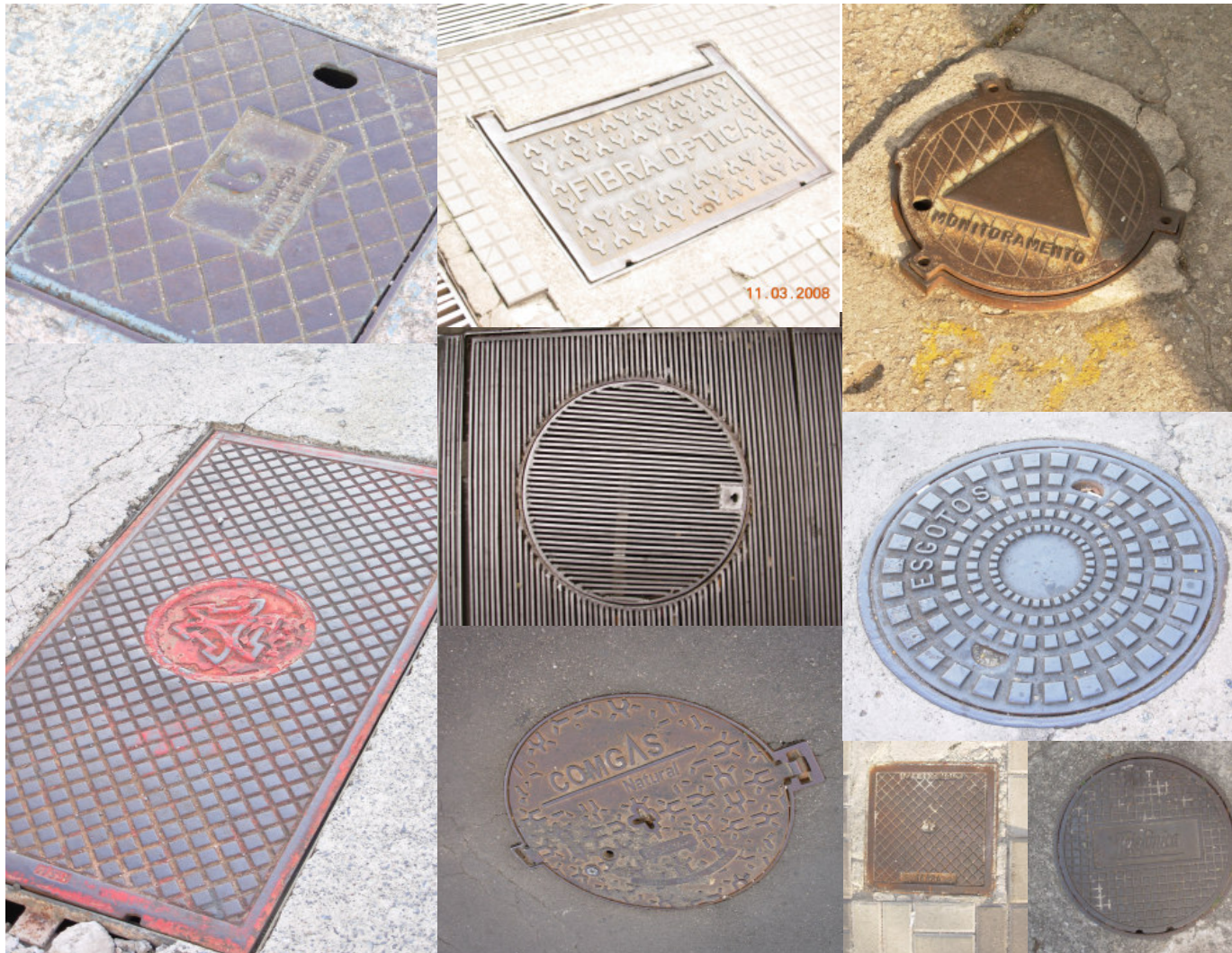
imagem 20. Um pequeno mosaico com as tampas dos serviços de infra-estrutura instalados sob as calçadas de SP: telefonia, rede de dados, rede de esgoto, respiro de túneis, água, captação pluvial, monitoramento de lençol freático, entre outros.
