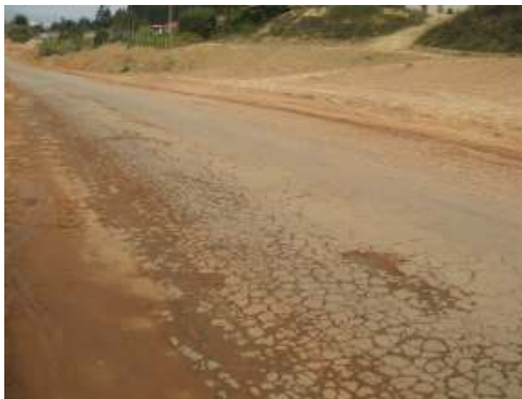
Figura 2.1- Pavimento deteriorado com trincas em blocos (BR 459- trecho Pouso Alegre- MG- Congonhal- MG).
