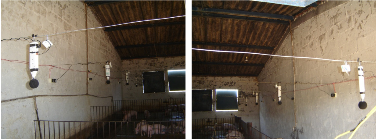
Figura 9 - Fotos da instalação dos 10 decibelímetros ( layout 1 ) no interior da sala de creche de suínos. Fotos da direita e da esquerda representam, respectivamente, o lado direito e esquerdo da instalação
