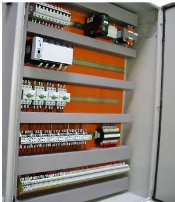
FIGURA 8 – Painel elétrico de uma prensa com CLP (Comando Lógico Programável)
