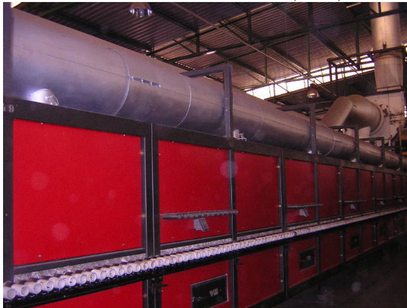
Foto 16 – Vista lateral do forno (120 m)
