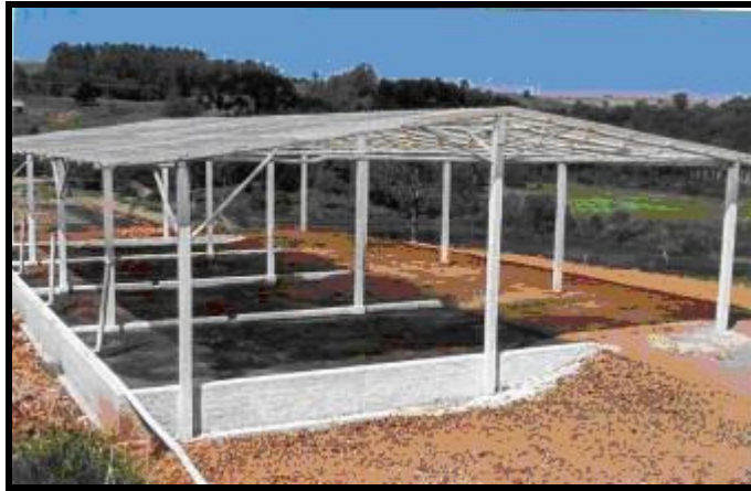
Figura 7. Vista geral do sistema de tratamento de dejetos.
