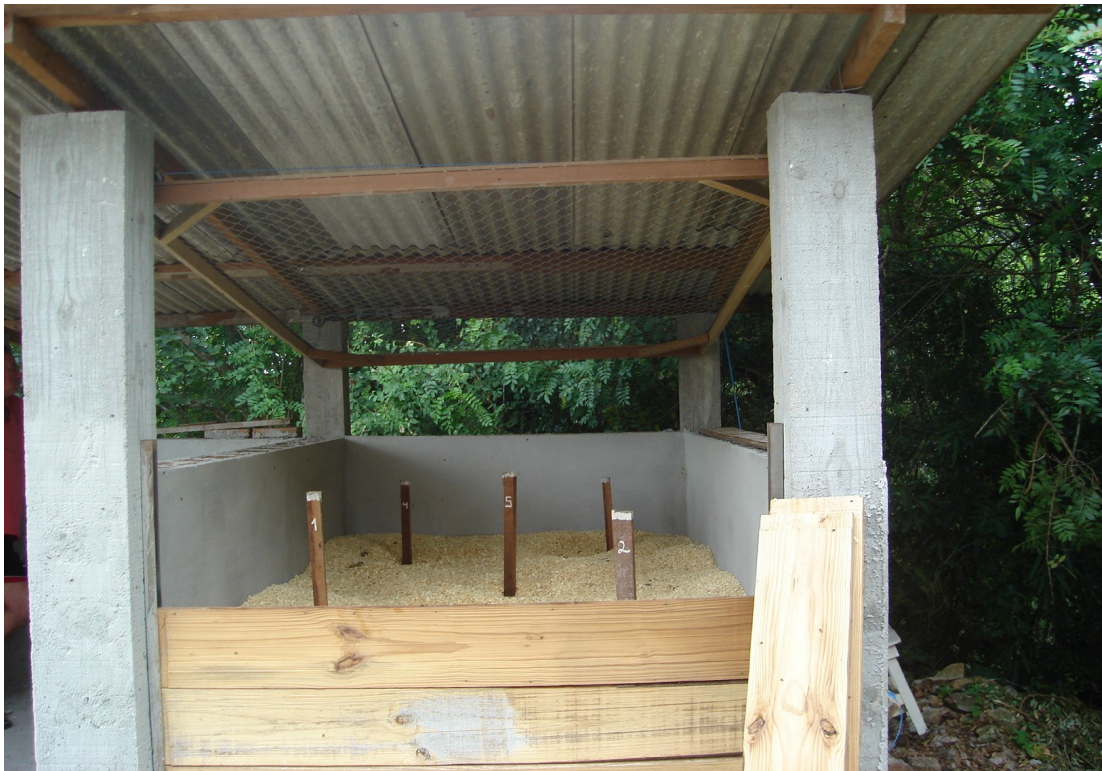
Figura 2 – Estrutura telada utilizada como proteção e portas móveis.
