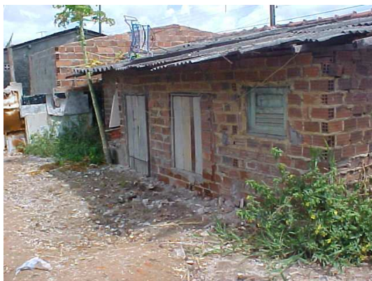
Figura 48: Casa com cota baixa devido a recalques. Foto: Sesan-PCR, 2003.
