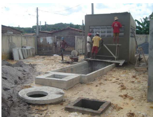
Figura 41: Estação Elevatória de Esgotos de Jardim Uchôa em construção. Foto da autora, 2007.
