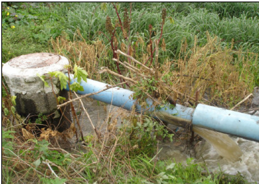
Figura 12. Foto da tubulação extravasora da elevatória da ETE de Mangabeira lançando esgoto de origens diversas próximo ao leito do Rio Cabelo.
