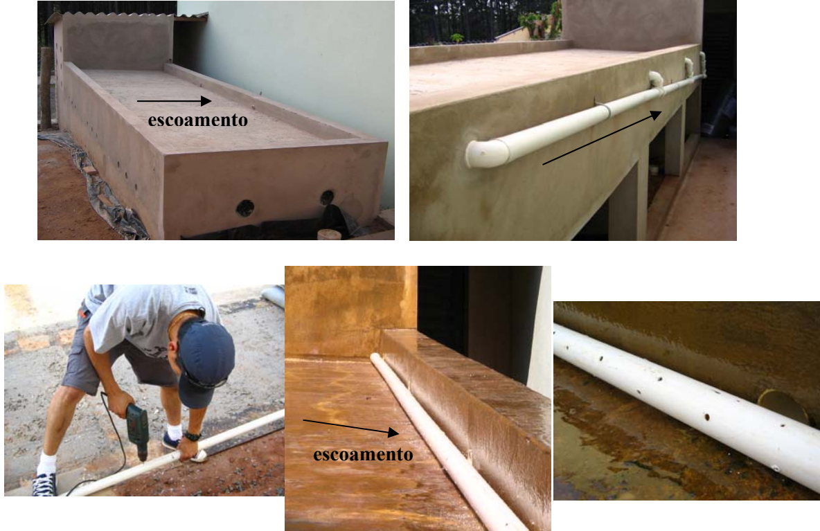
Figura 4.8 - Posicionamento do dreno, furação e sentido do escoamento sobre o teto verde.
