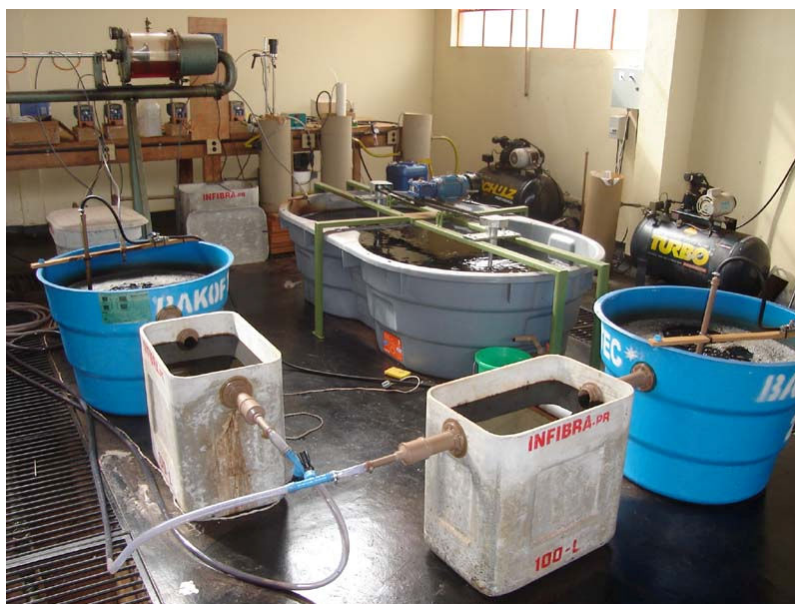
Figura 4.3 – Vista geral dos sistemas de tratamento.
