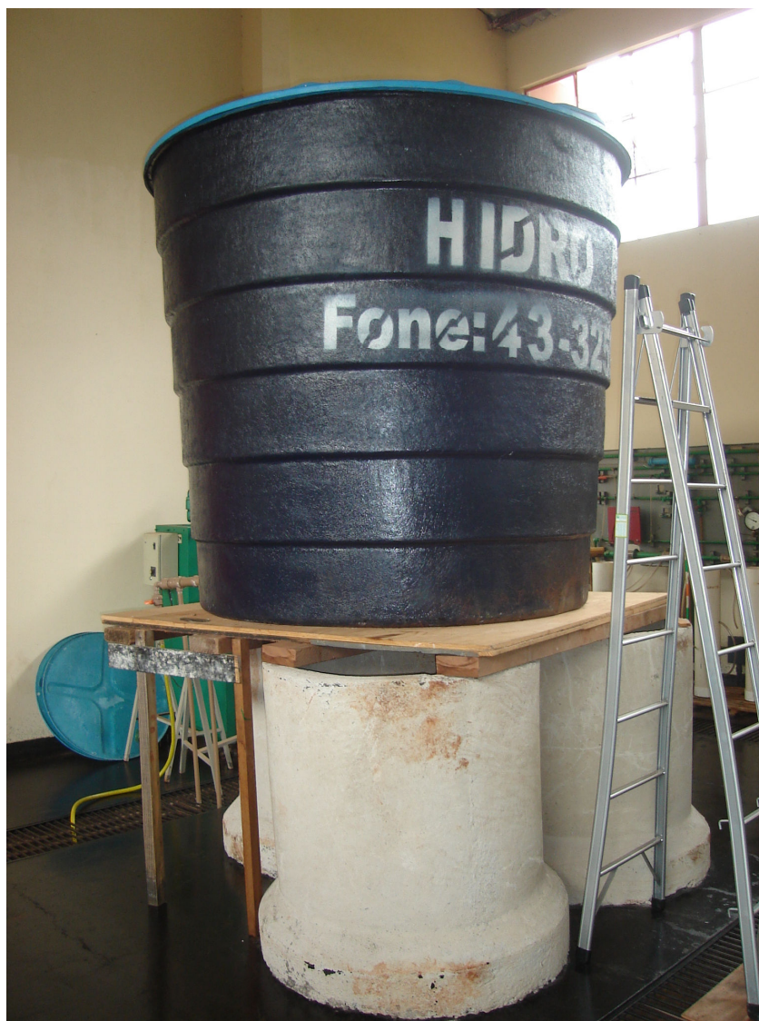
Tanque de acumulação de lixiviado bruto.
