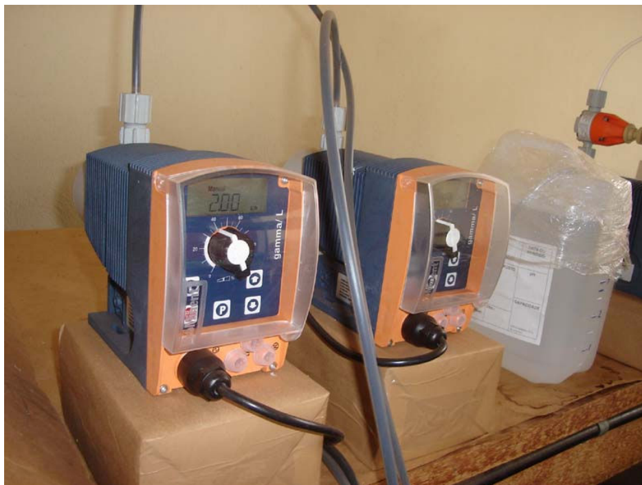
Figura 4.4 – Bombas dosadoras utilizadas para a alimentação dos sistemas.
