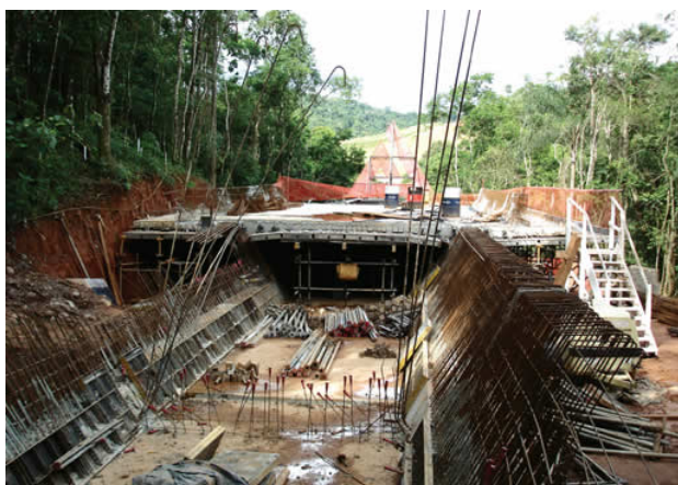
Figura 27: Construção de ponte “empurrada” de acesso ao Gênesis II Fonte: Revista Técnica, edição 113, p 38- 43, agosto de 2006
