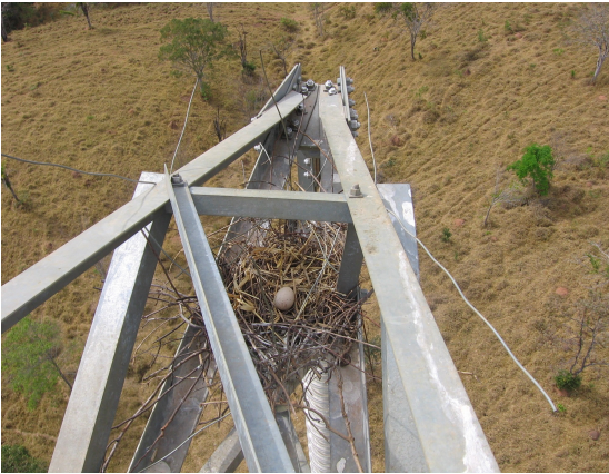
Ninho construído sobre sistema de proteção
