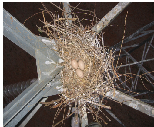
Ninho com ovos próximo ao isolador central
