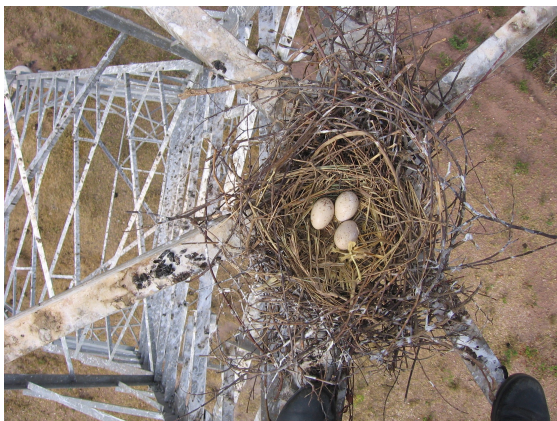
Contaminação da estrutura com fezes
