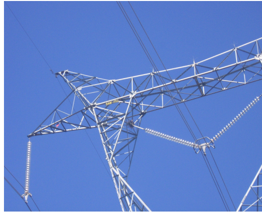
Ninho na viga vertical esquerda
