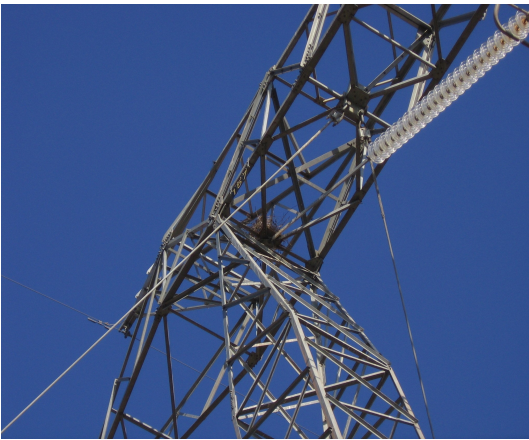
Ninho (esquerda) da viga horizontal
