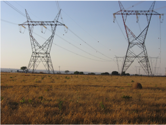
Torres do tipo RB30 (esquerda) e SP (direita) e SB (ao fundo)
