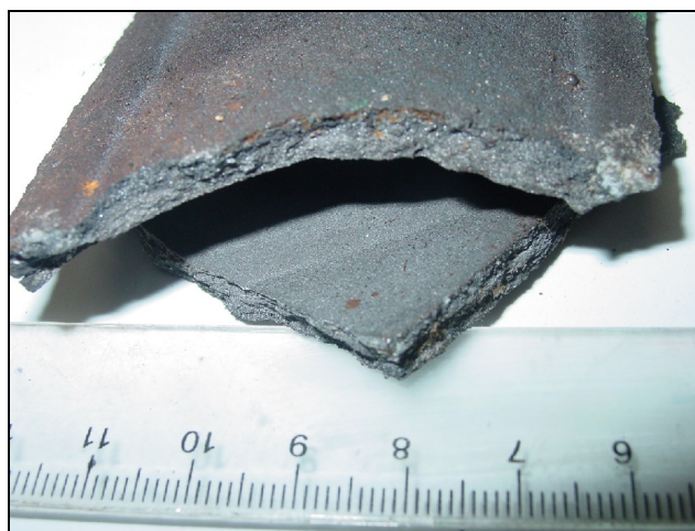
Figura 4.88- Revestimento despreendido do tubo durante a pressurização.
