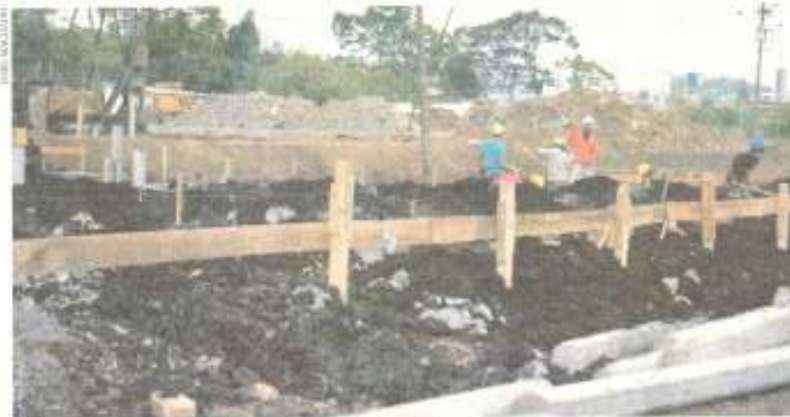
EXPANSÃO Operários trabalham nas obras de fundação dos novos condomínios a serem erguidos no Cecap.
