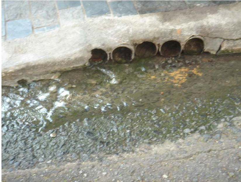
Figura 41 : Descarga de água de lençol freático na rede de drenagem Foto do autor
