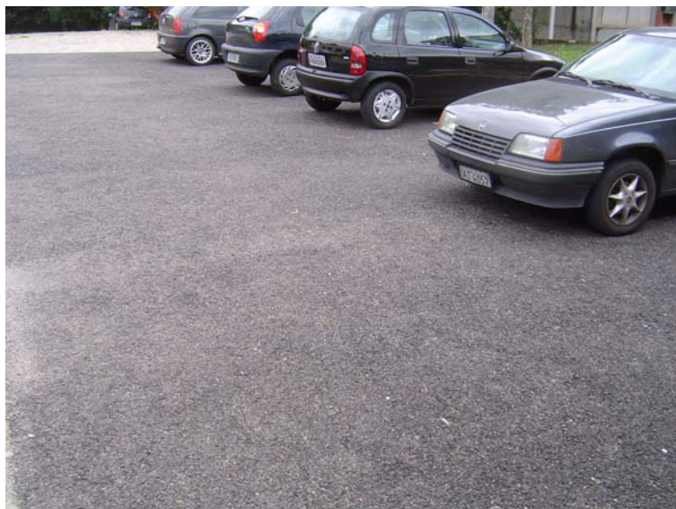
Figura 14 : Pavimento asfáltico permeável Modelo experimental –área estacionamento - Local: I.P.H. Instituto de Pesquisas Hidráulicas Porto Alegre – R.S. Foto do autor / 2003
