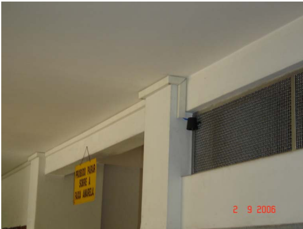
Foto 5.9.1 - Aspecto visual deficiente das instalações elétricas aparentes.
