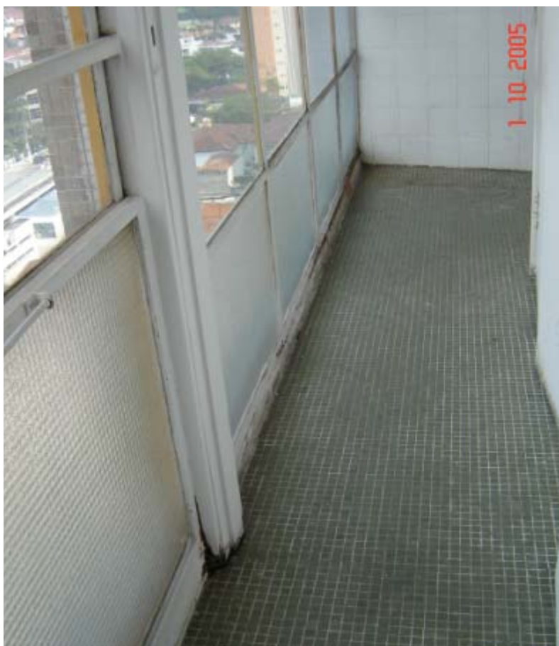
Foto 5.7.4. – Degradação da pintura de esmalte sintético da caixilharia de chapa dobrada.
