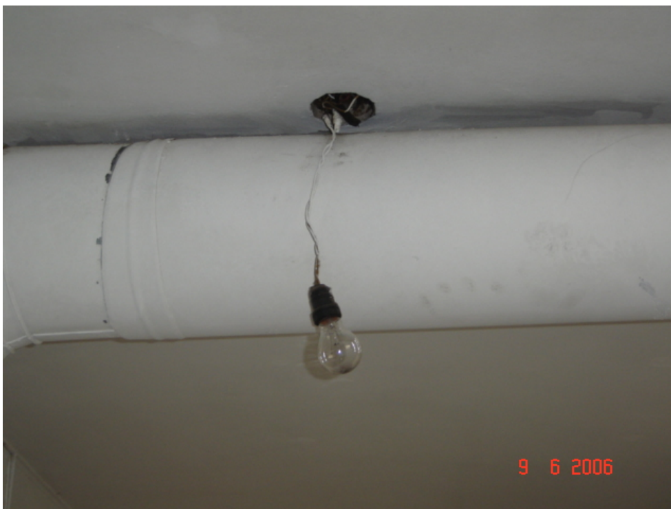
Foto 5.9.3 - Aspecto visual deficiente das instalações elétricas aparentes.
