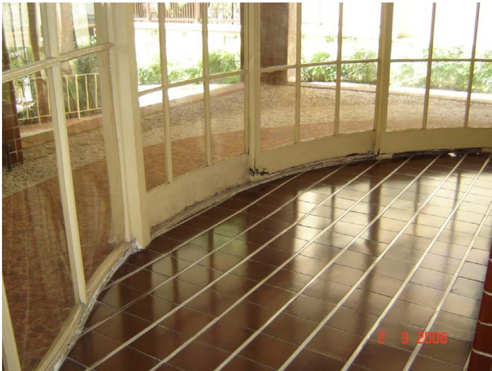
Foto 5.7.4 – Degradação da caixilharia de chapa de ferro dobrada em contato com o piso.
