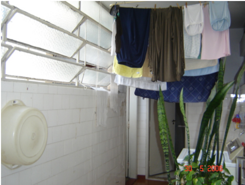
Foto 5.7.7 – Dificuldade de movimentação da caixilharia.
