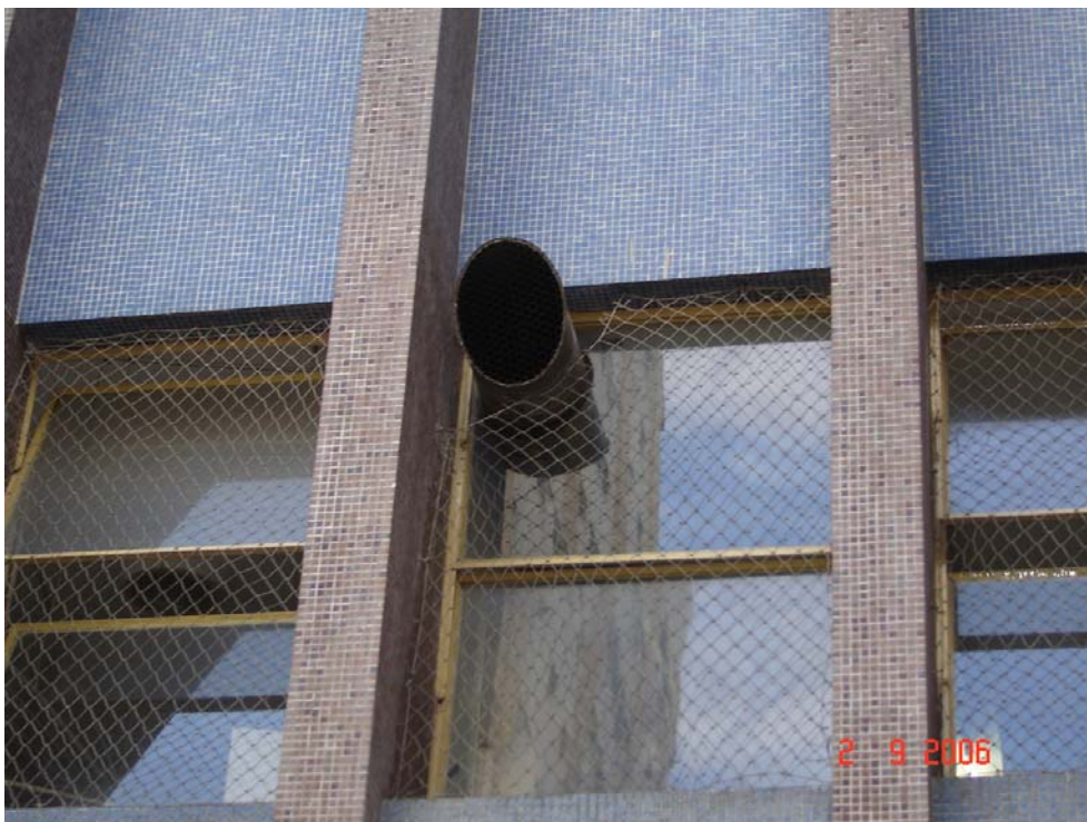
Foto 5.10.3 - Aspecto visual deficiente das instalações para exaustão da cozinha.
