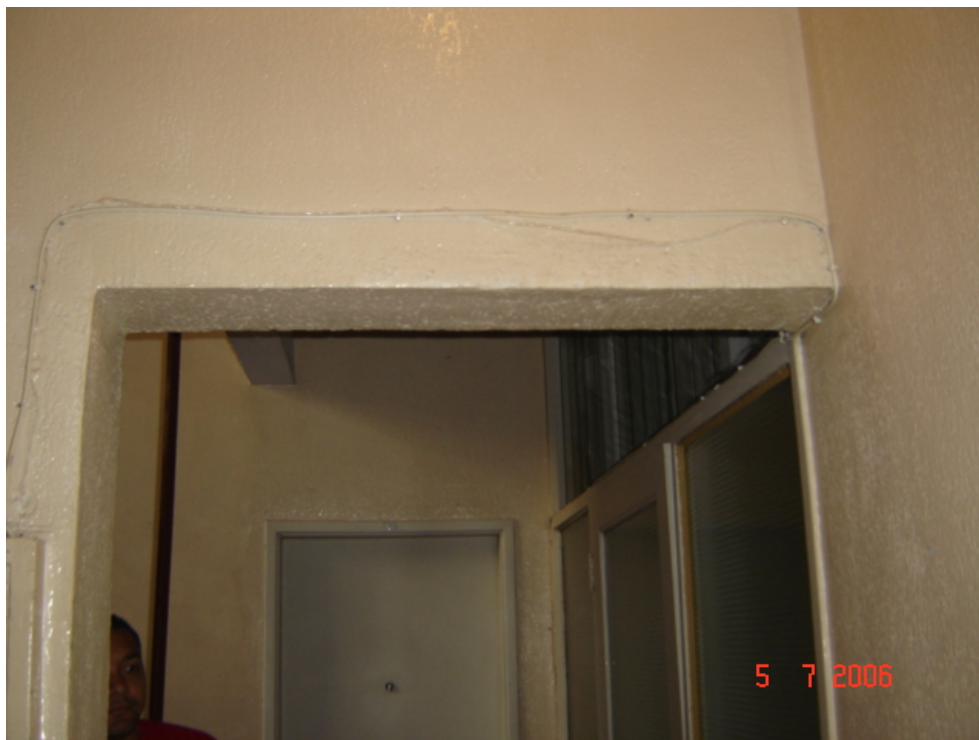
Foto 5.9.1 - Aspecto visual deficiente das instalações elétricas aparentes.
