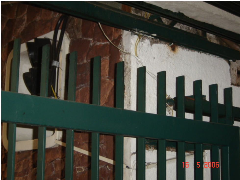
Foto 5.9.4 - Aspecto visual deficiente das instalações elétricas aparentes.
