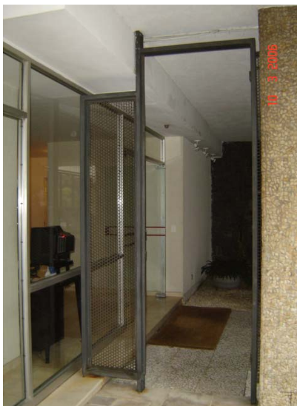
Foto 5.7.1 - Instalação de grade de proteção contra roubo de material incompatível com a caixilharia existente.
