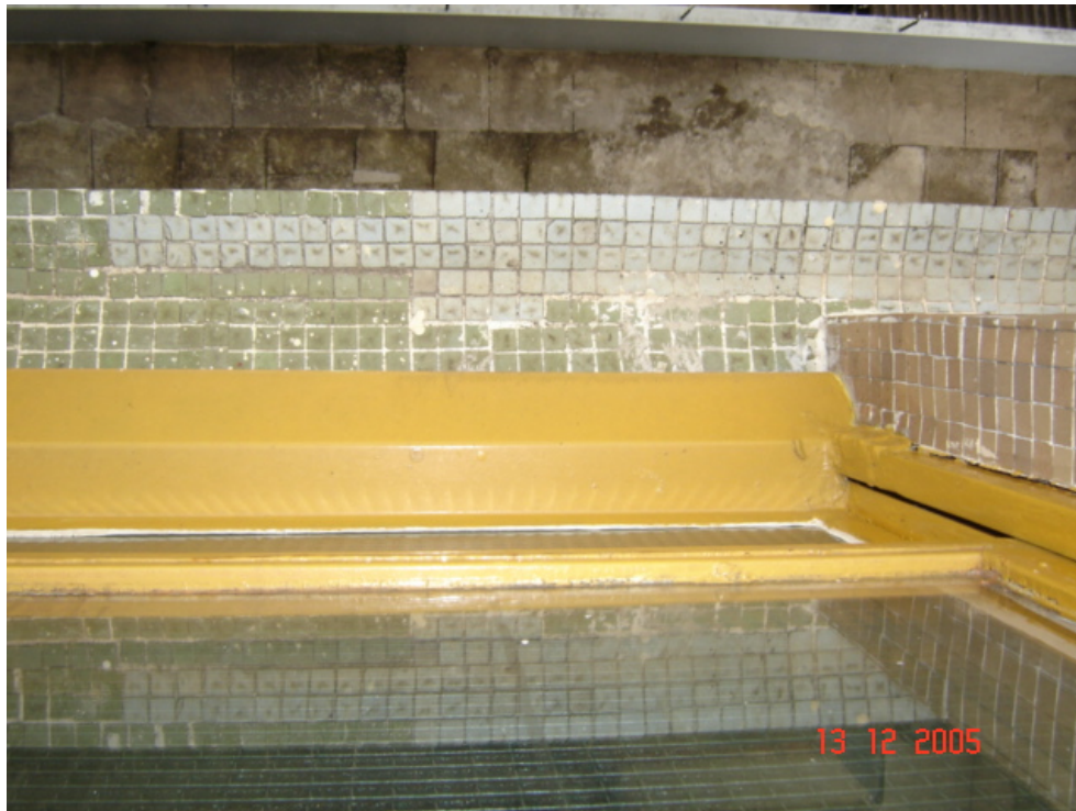
Foto 5.8.1. – Restauração deficiente dos revestimentos com pastilha cerâmica.
