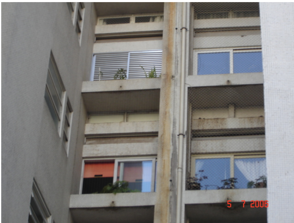
Foto 5.7.2 – Substituição de caixilharia por outra de material e desenho fora da especificação original do projeto.
