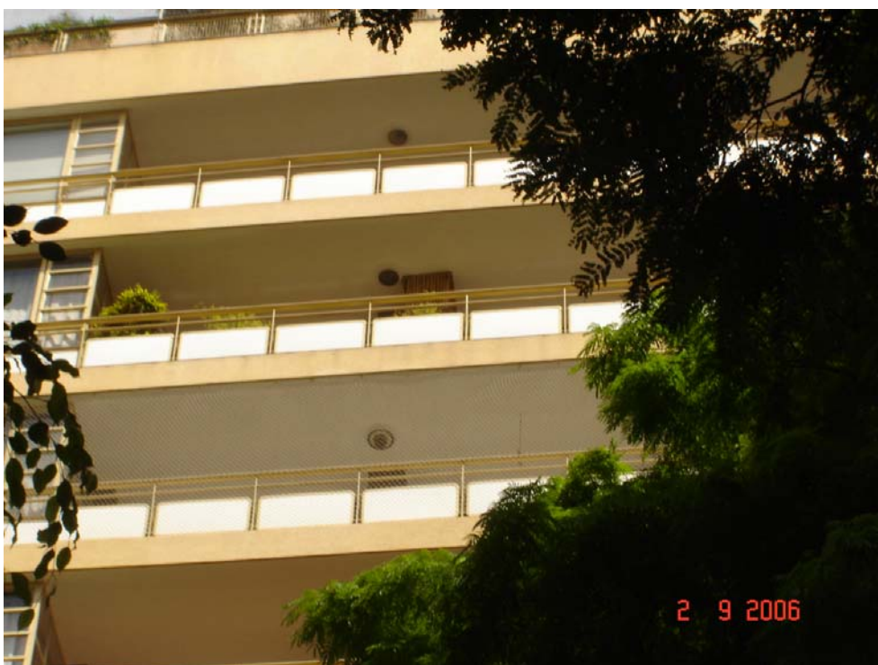
Foto 5.9.9 - Aspecto visual deficiente com a modificação parcial das luminárias.
