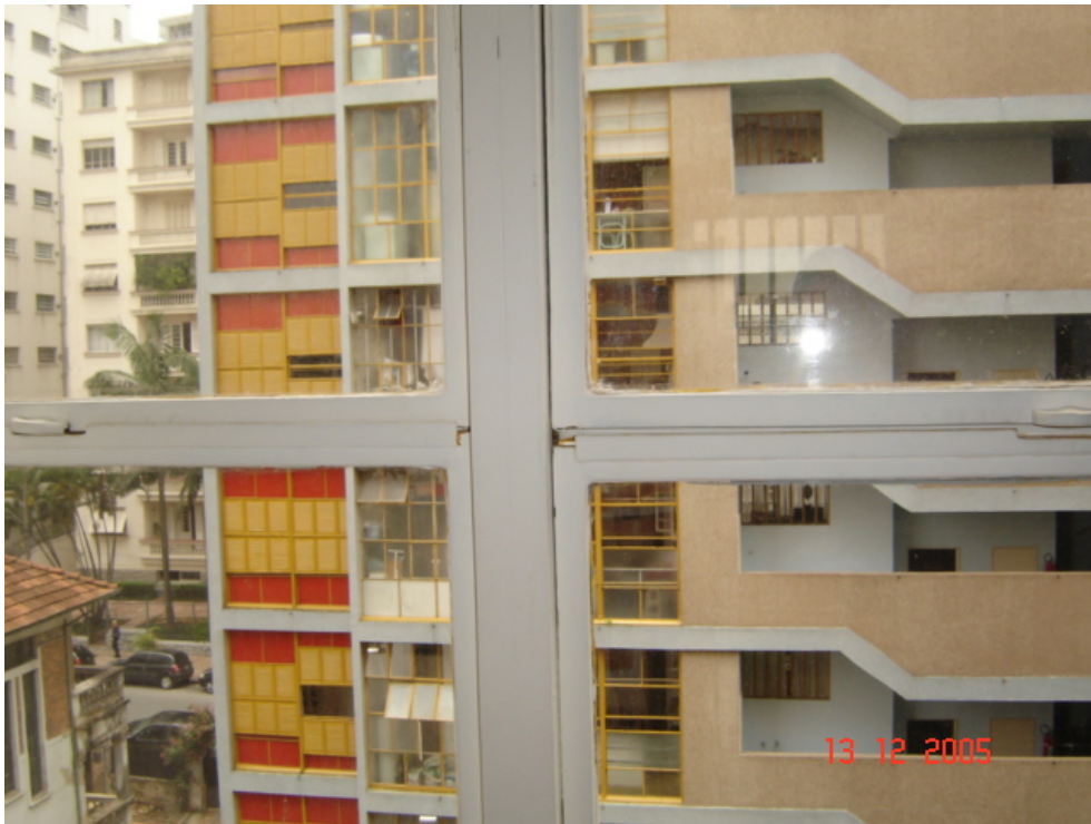
Foto 5.7.3. – Deficiência acústica de todo o sistema de vãos.
