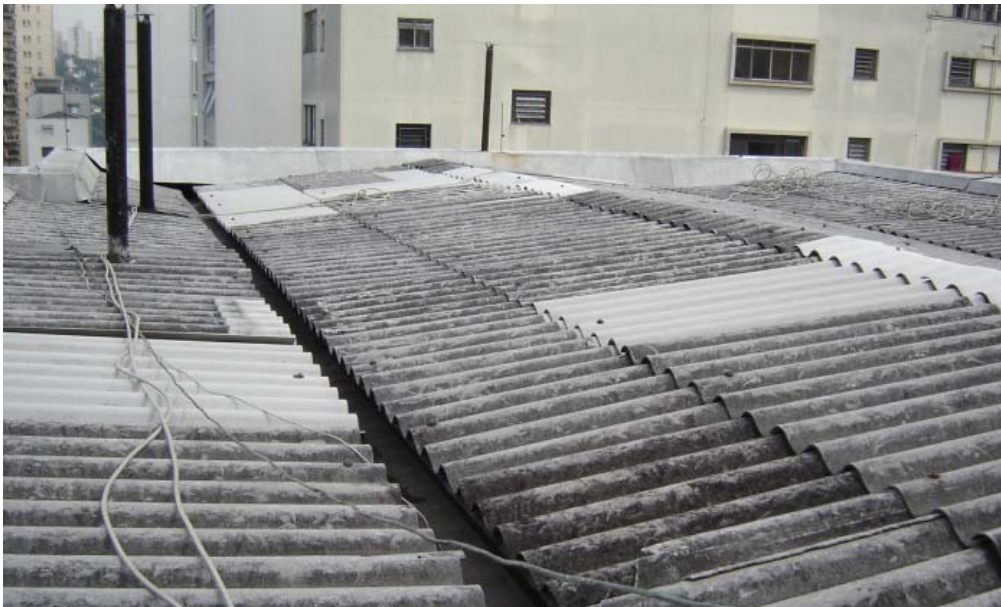
Foto 5.4.1. – Declividade inadequada da calha central em função do comprimento da mesma.
