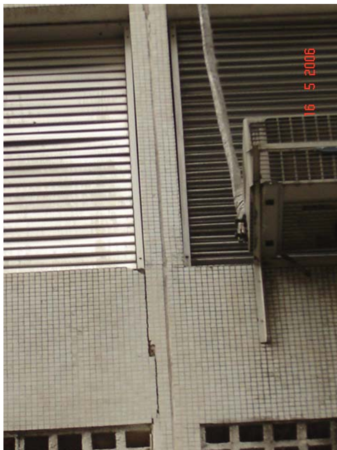
Foto 5.5.2 – Trinca nas paredes externas.
