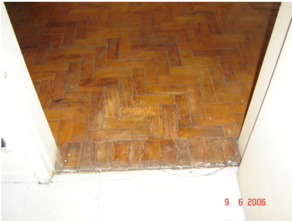
Foto 5.6.2 – Degradação do piso com tacos de madeira.
