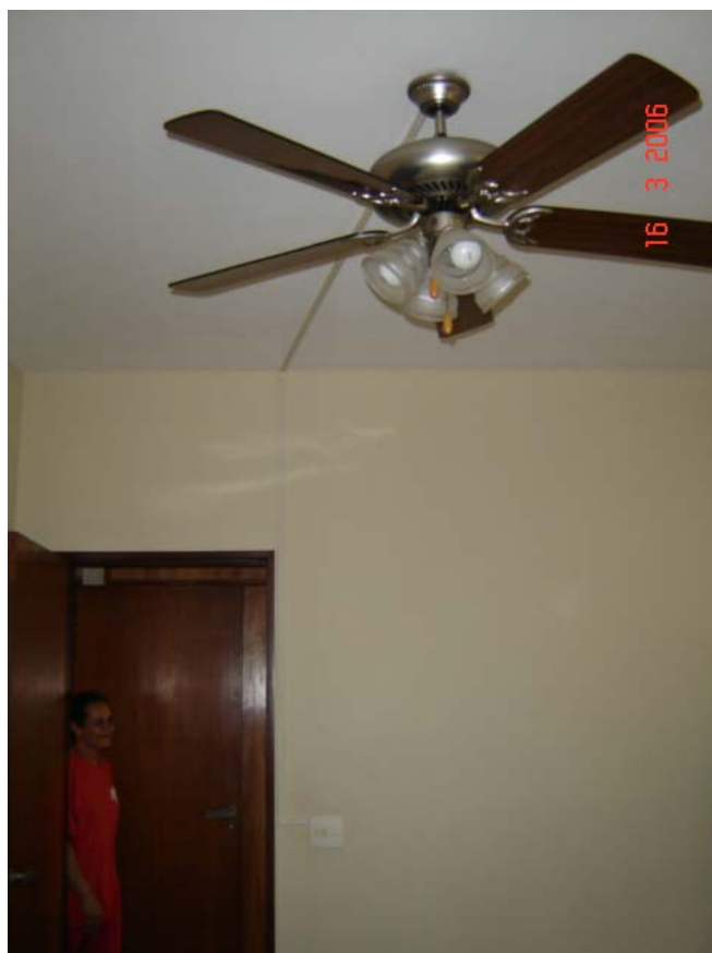
Foto 5.9.5 - Introdução de luminária/ventilador no teto dos dormitórios por meio de instalações elétricas aparentes.
