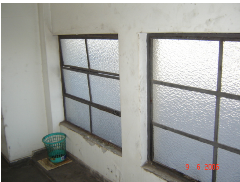
Foto 5.5.4 – Ausência de reconstrução dos peitoris das janelas da casa de máquinas dos elevadores.
