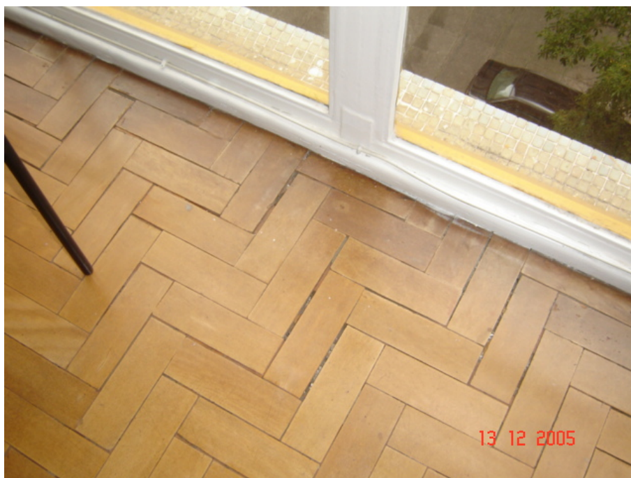
Foto 5.6.1. – Degradação dos tacos de madeira das salas e dormitórios junto a caixilharia.
