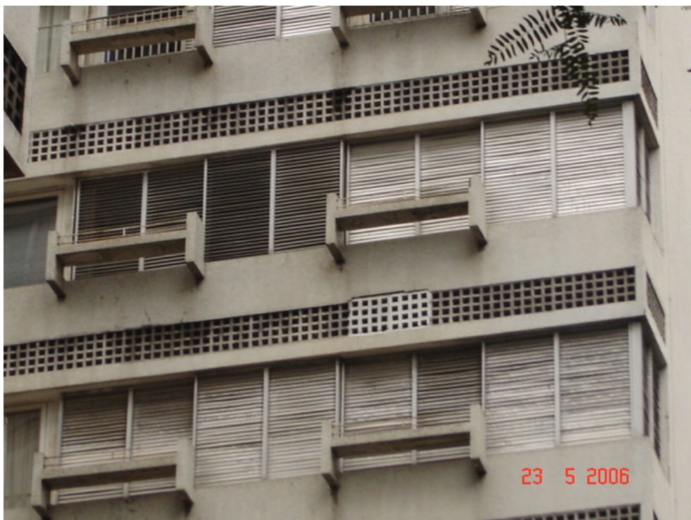
Foto 5.5.11 – Reposição inadequada do elemento vazado de concreto.
