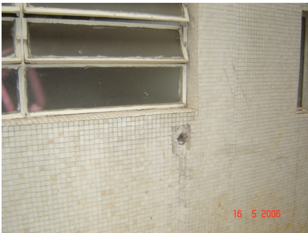
Foto 5.5.8 – Ausência de reconstrução da alvenaria.
