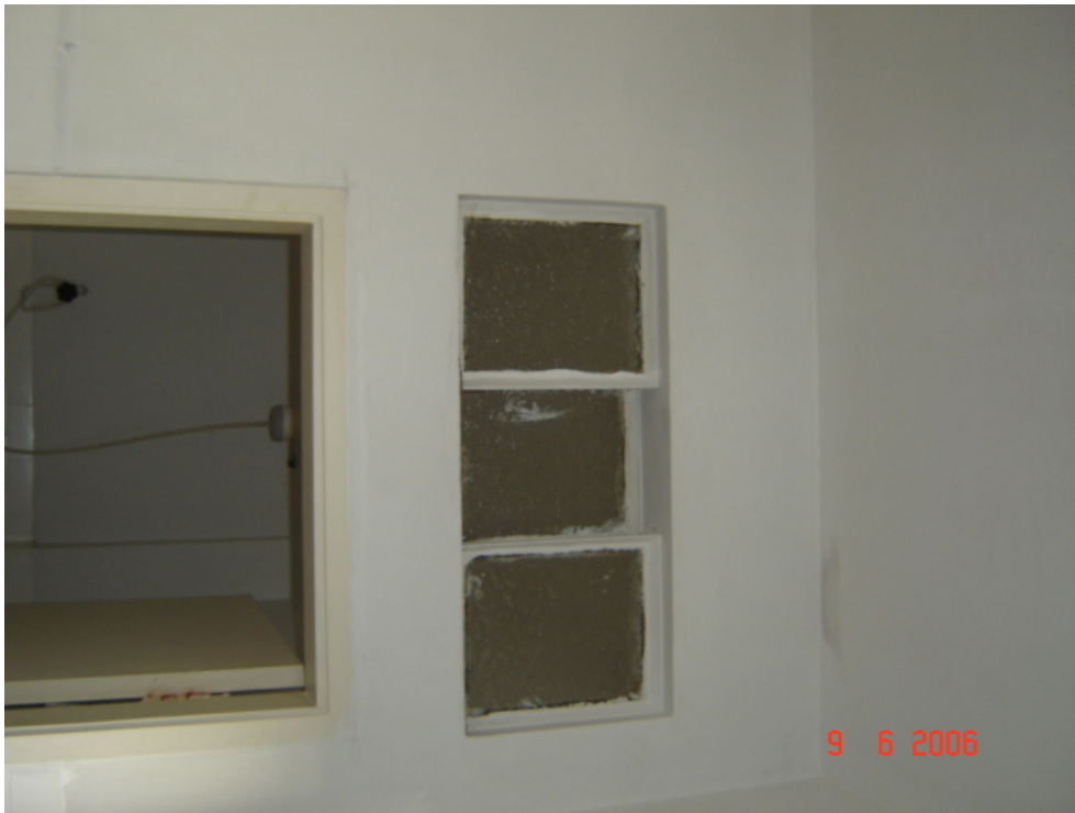
Foto 5.7.8 – Restauração inadequada da pintura da caixilharia.
