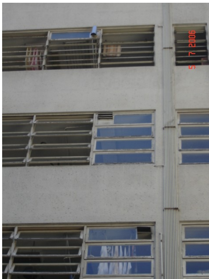
Foto 5.9.4 - Aspecto visual deficiente das instalações para exaustão da cozinha.
