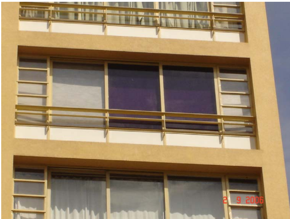
Foto 5.7.9 – Comprometimento estético pela instalação de filme escuro sobre vidros.
