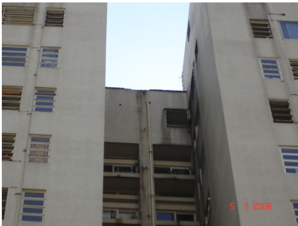
Foto 5.10.1 - Instalação aparente de sistema de drenagem da cobertura.
