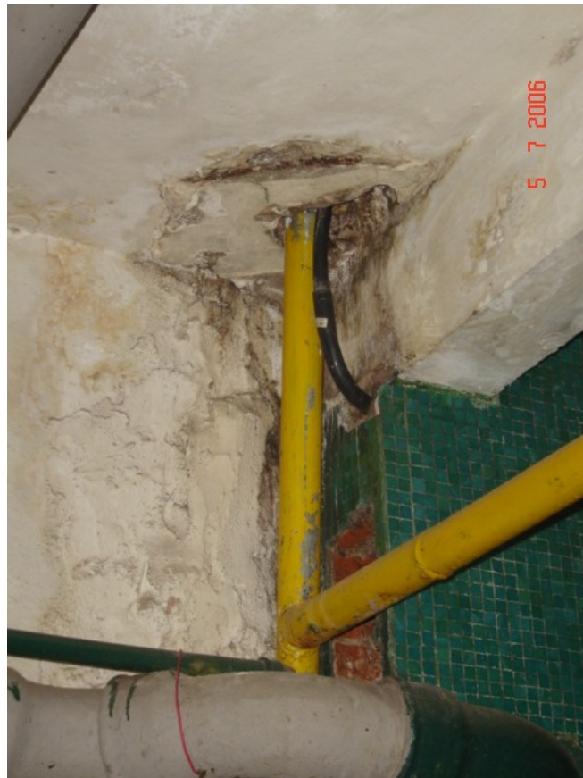
Foto 5.9.5 - Aspecto visual deficiente da instalação elétrica.
