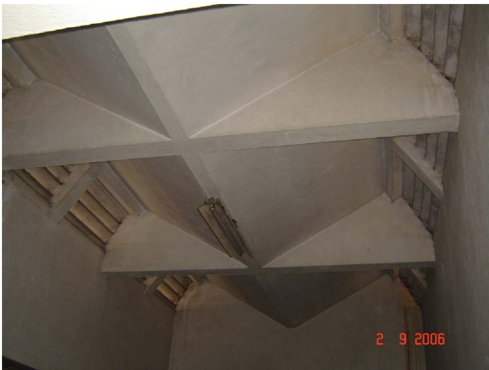
Foto 5.8.5 – Degradação da pintura Látex tipo PVA da cobertura tipo sheed.
