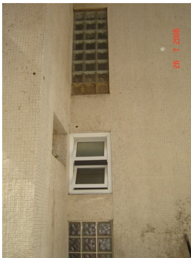
Foto 5.7.3 Substituição de caixilharia por outra de material fora da especificação original do projeto.
