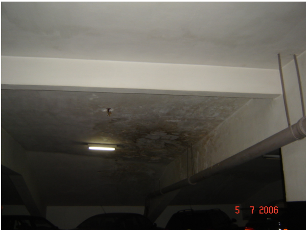
Foto 5.6.5 – Laje da garagem localizada no subsolo com infiltração generalizada.
