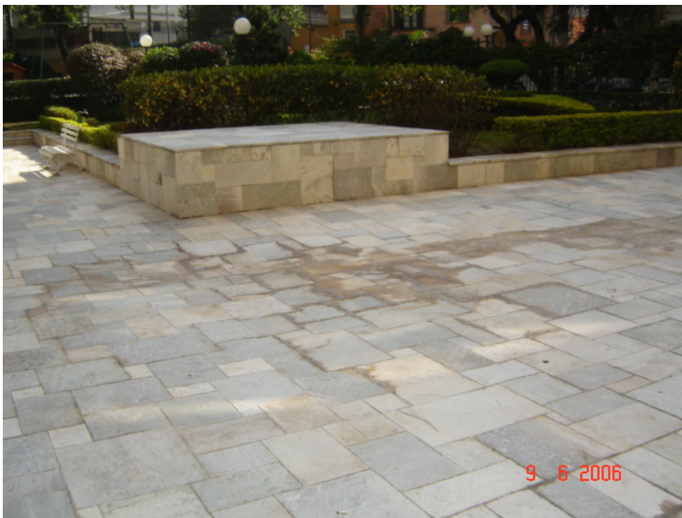
Foto 5.10.3 - Deficiência de ralos de drenagem do piso pavimentado com pedras da praça frontal ao edifício.
