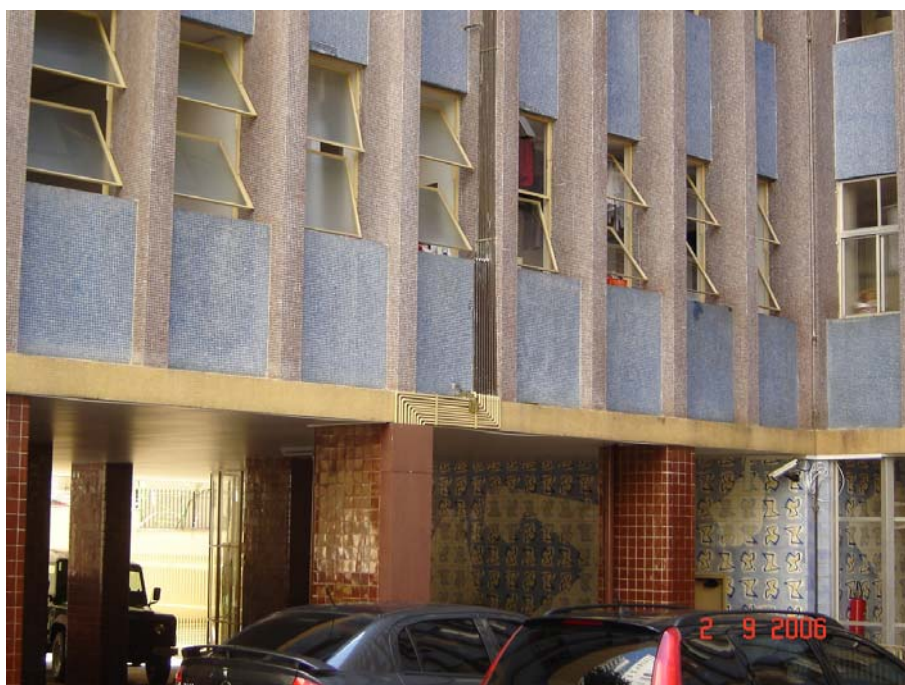
Foto 5.8.9 – Degradação do pilar revestido com cerâmica esmaltada em decorrência de fixação de chapa metálica.
