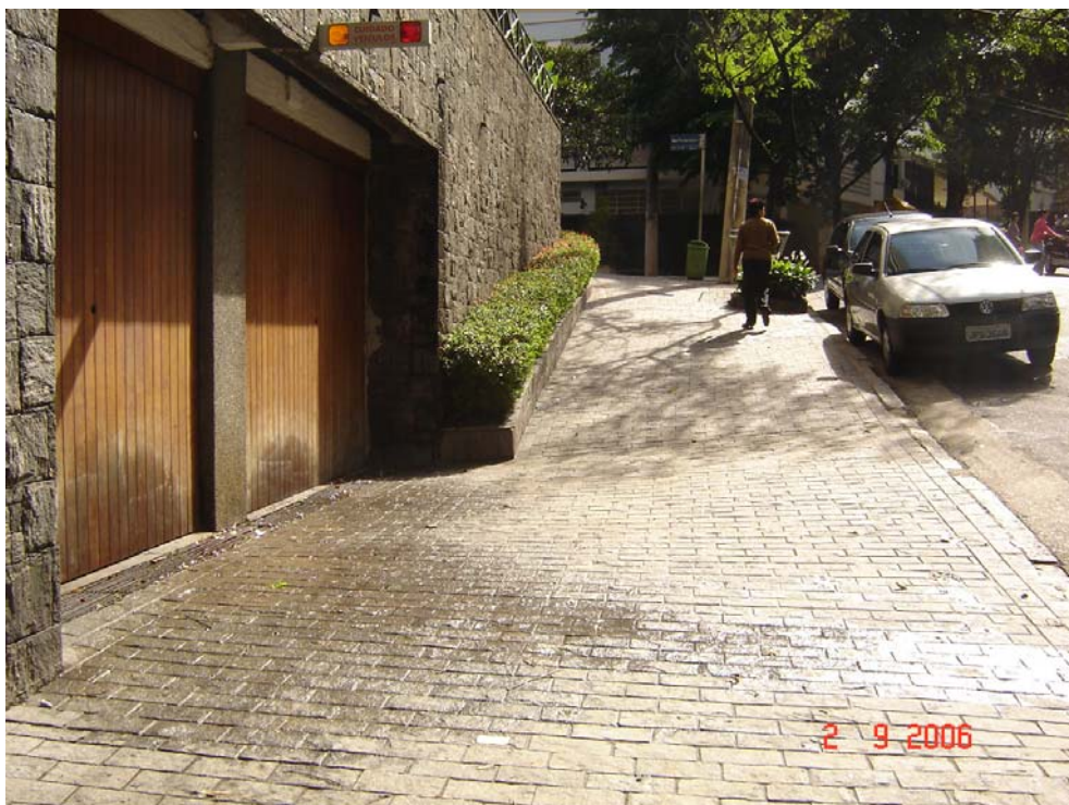
Foto 5.1.3 - Declividade acentuada da calçada externa de pedestres para acomodação do acesso de automóveis para a garagem localizada no sub solo.
