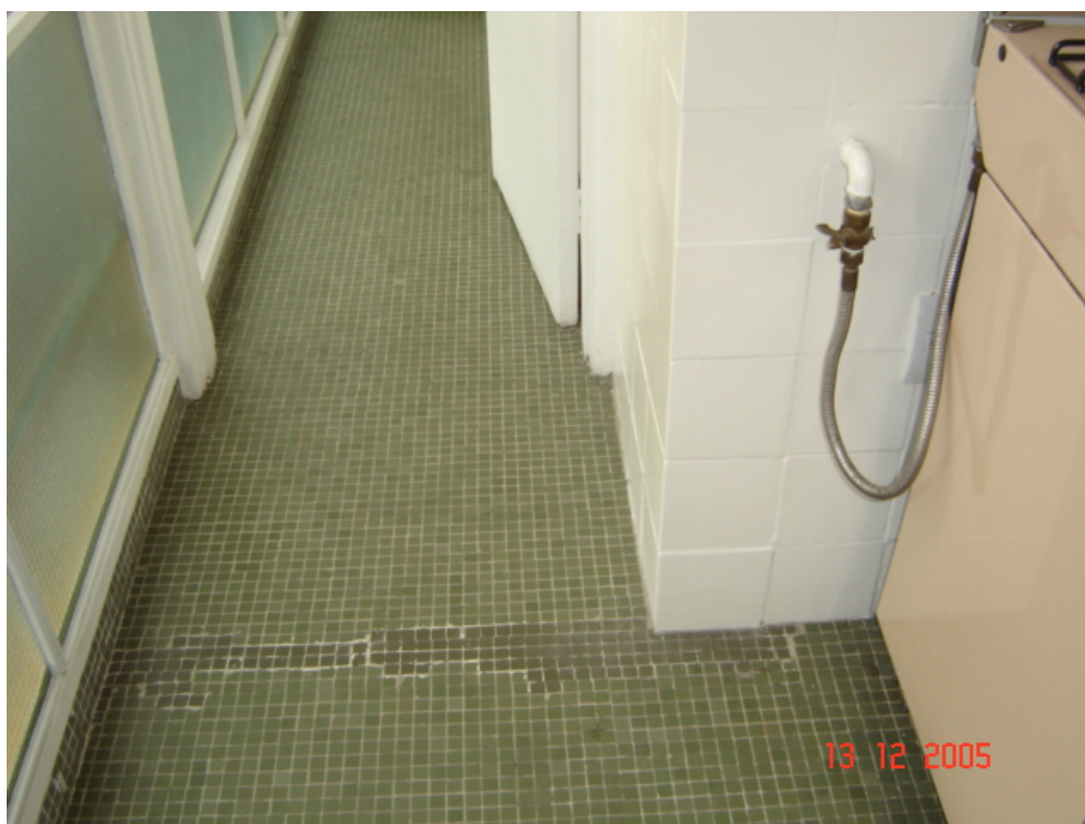
Foto 5.6.7. – Aspecto visual deficiente do piso tipo pastilha cerâmica decorrente de restauro.
