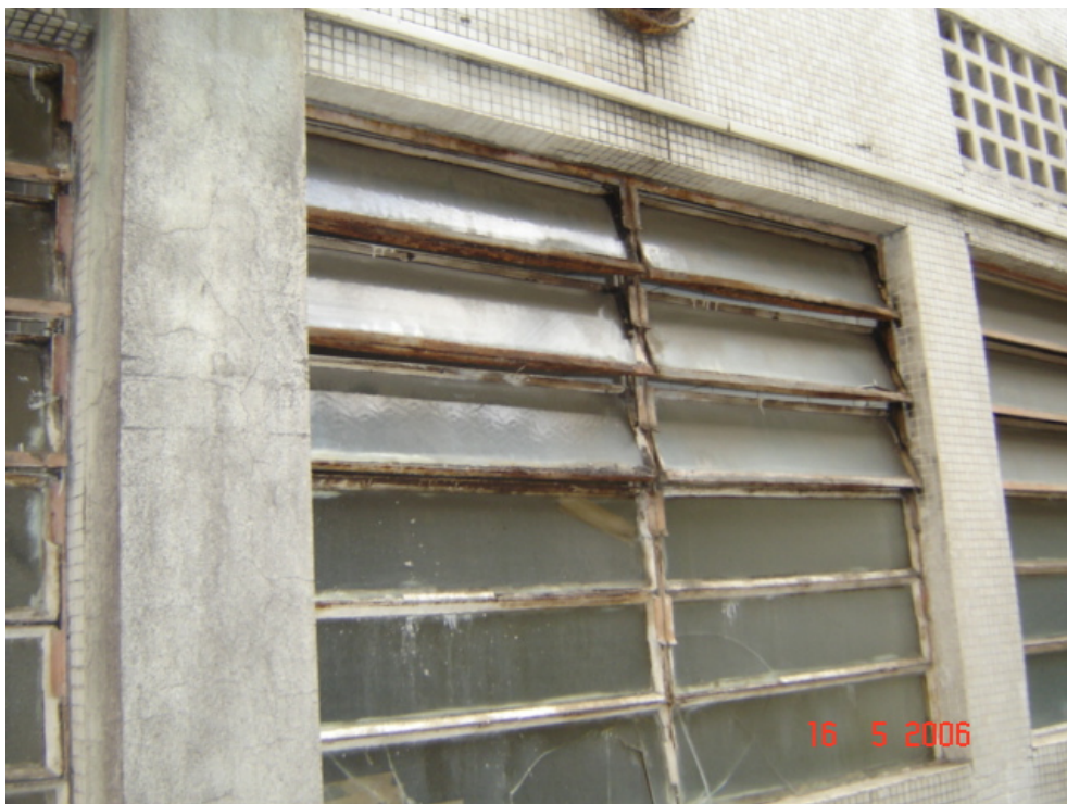
Foto 5.7.3 – Degradação da caixilharia de chapa de ferro dobrada.
