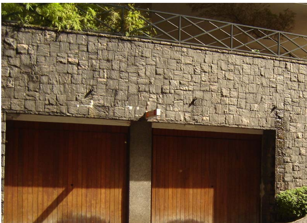
Foto 5.5.1 - Manchas na parede de pedra, provenientes das floreiras que se encontram atrás da mesma.
