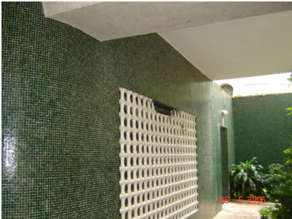
Foto 5.5.10 – Falta de reposição de elemento vazado de cerâmica.
