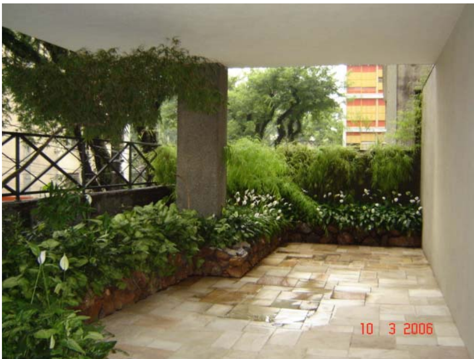
Foto 5.10.1 - Deficiência de ralos de drenagem para lavagem do piso.
