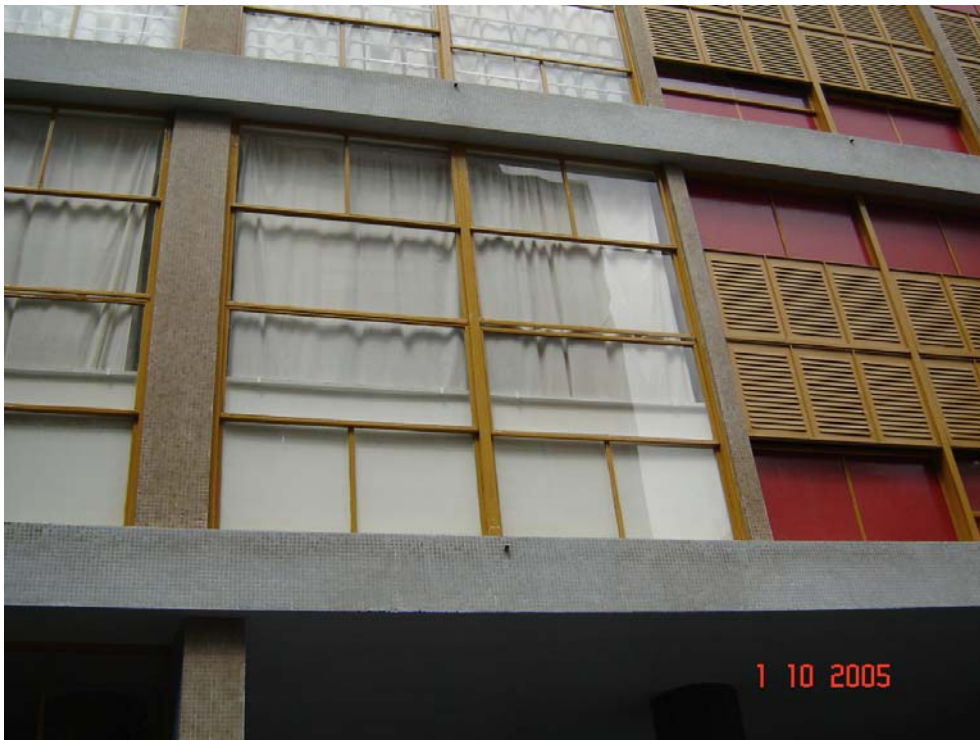
Foto 5.7.5. – Deficiência térmica de todo o sistema de vãos.
