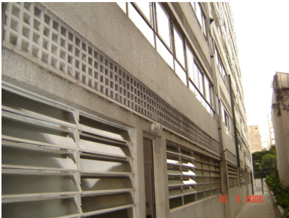
Foto 5.7.5 – Dificuldade de movimentação da caixilharia.
