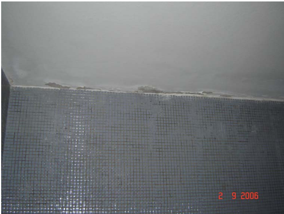
Foto 5.8.2 – Degradação da pintura Látex tipo PVA dos tetos do hall social e de serviço.
