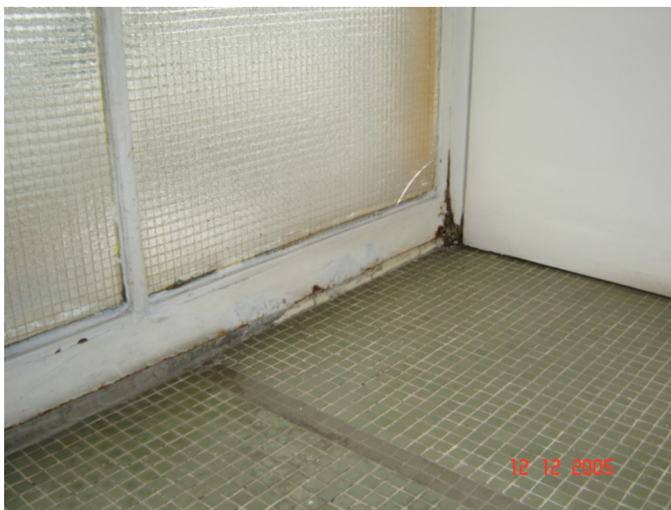
Foto 5.7.1. – Oxidação e corrosão da caixilharia de chapa de aço galvanizado.
