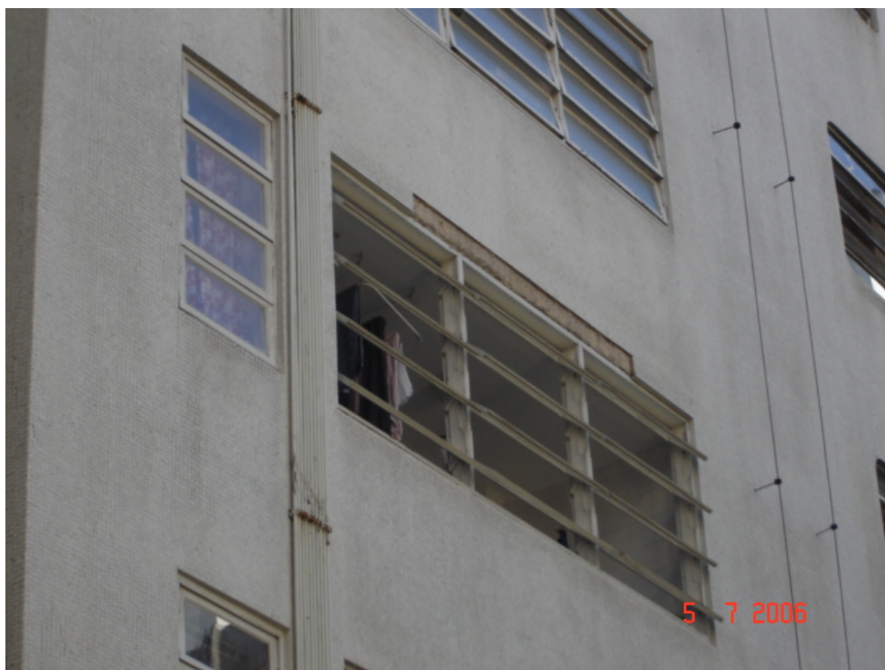
Foto 5.8.4 – Carência de reposição de pastilha cerâmica sobre a janela.
