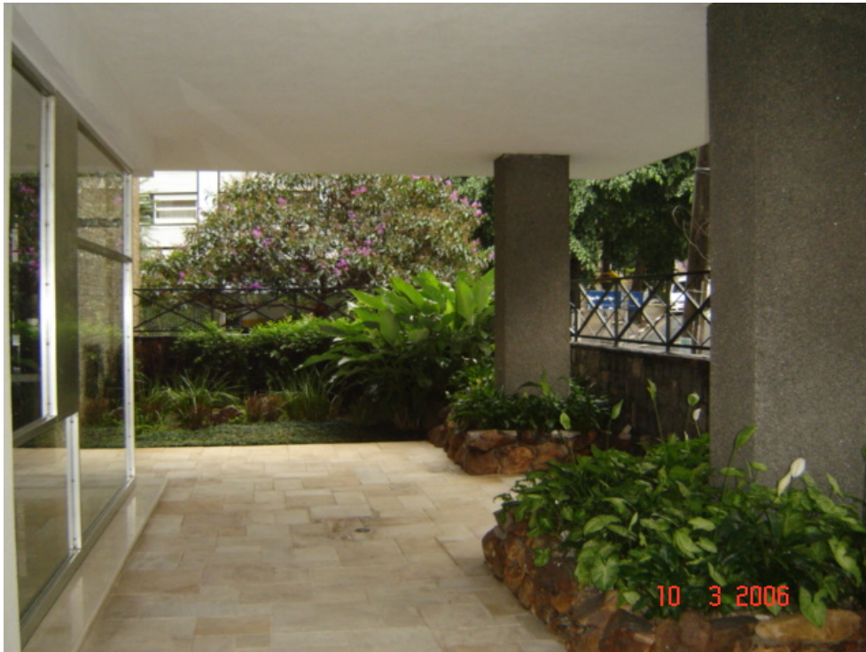
Foto 5.1.1 - Falta de sistema de drenagem na área gramada localizada no pavimento térreo.
