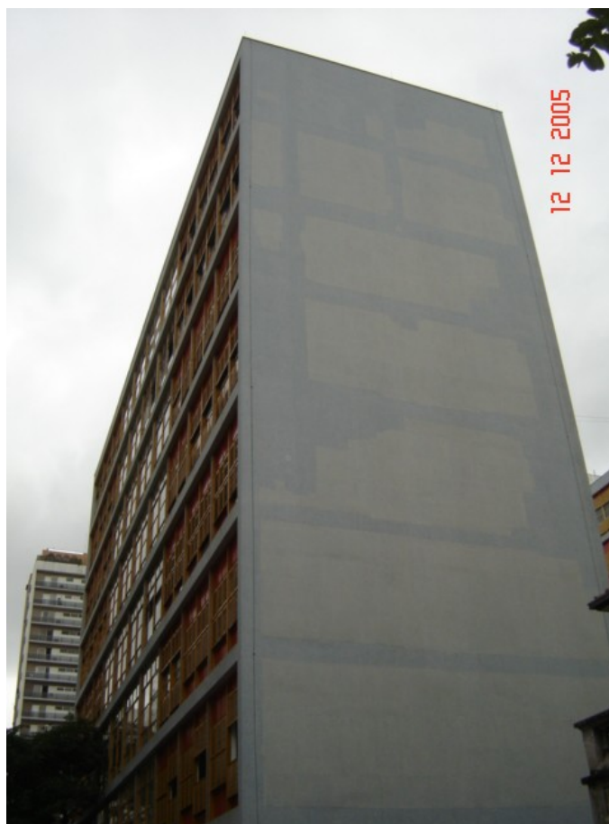
Foto 5.8.3. – Restauração deficiente dos revestimentos com pastilha cerâmica, localizado na empena posterior do Bloco A.
