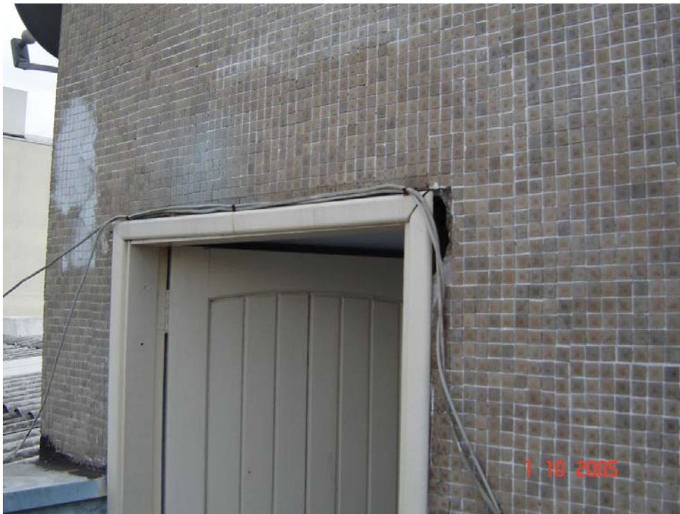
Foto 5.5.6. – Aspecto visual deficiente no volume da caixa d' água superior com a demolição parcial da alvenaria.
