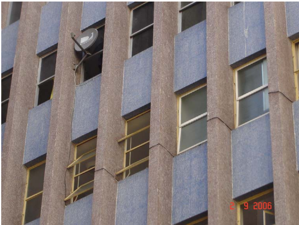
Foto 5.9.3 - Aspecto visual deficiente com a instalação de antena parabólica.
