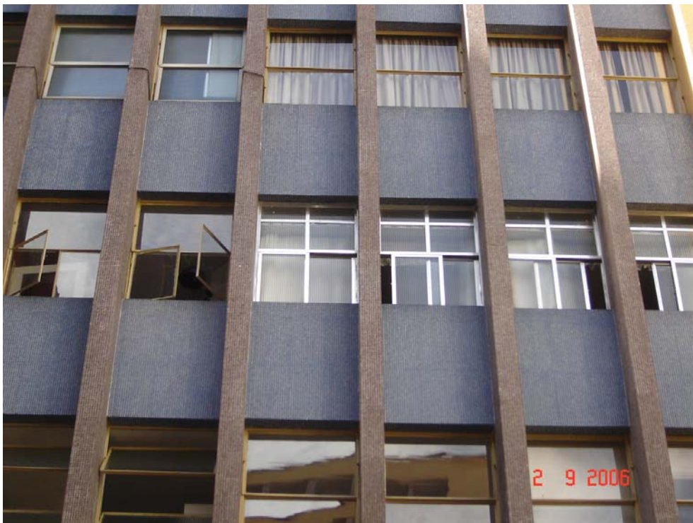
Foto 5.9.6 - Aspecto visual deficiente com as instalações elétricas aparente contornando os pilares.
