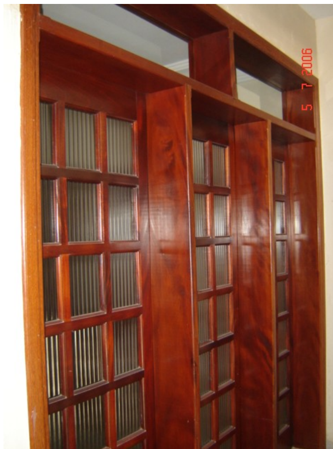
Foto 5.7.14 – Substituição de caixilharia por outra de material fora da especificação original do projeto.
