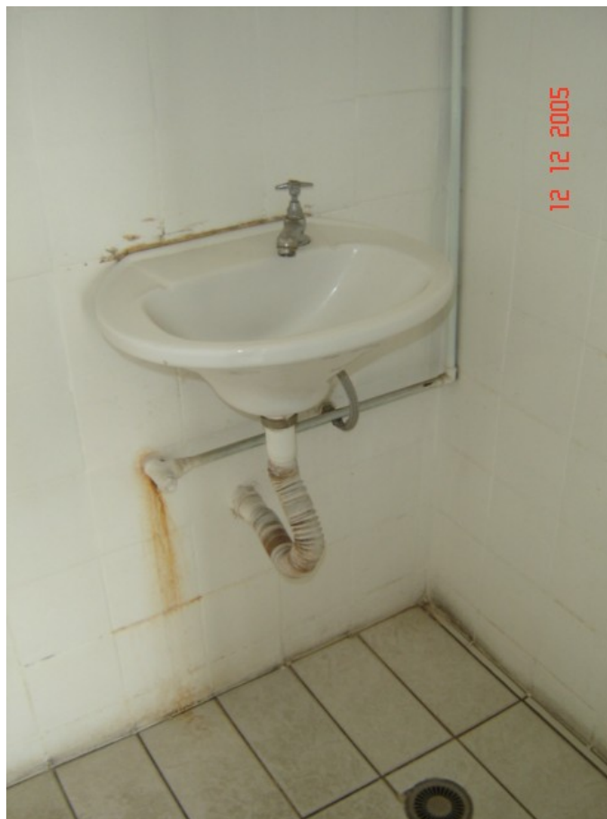
Foto 5.10.5. – Degradação dos metais sanitários.
