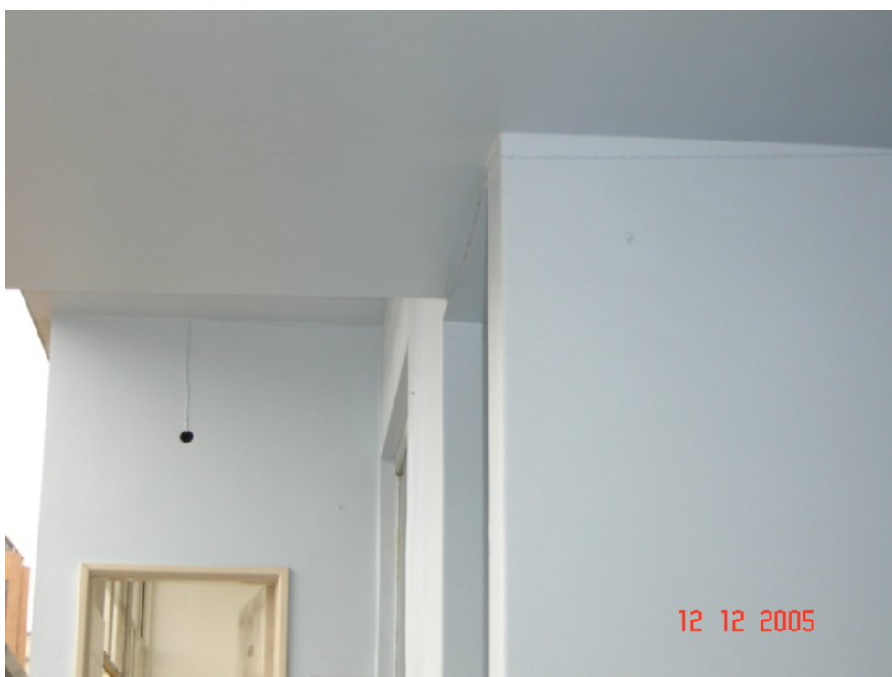
Foto 5.9.9. – Aspecto visual deficiente das instalações aparentes para interfonos.
