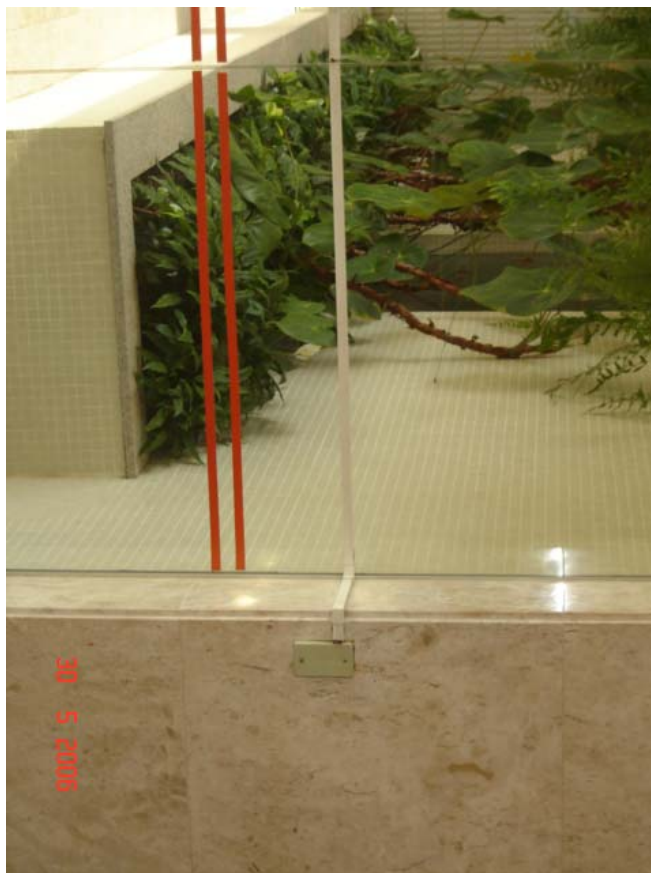
Foto 5.9.6 - Aspecto visual deficiente das instalações elétricas de acionamento da porta de acesso ao hall social.
