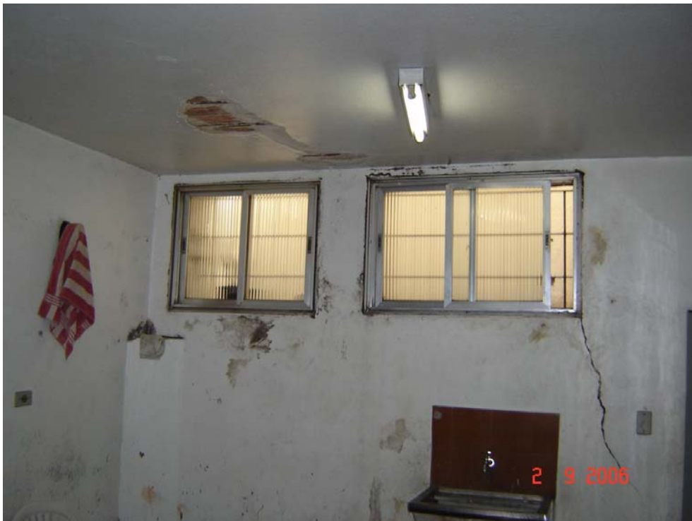
Foto 5.5.2 – Trincas nas paredes do vestiário de funcionários.
