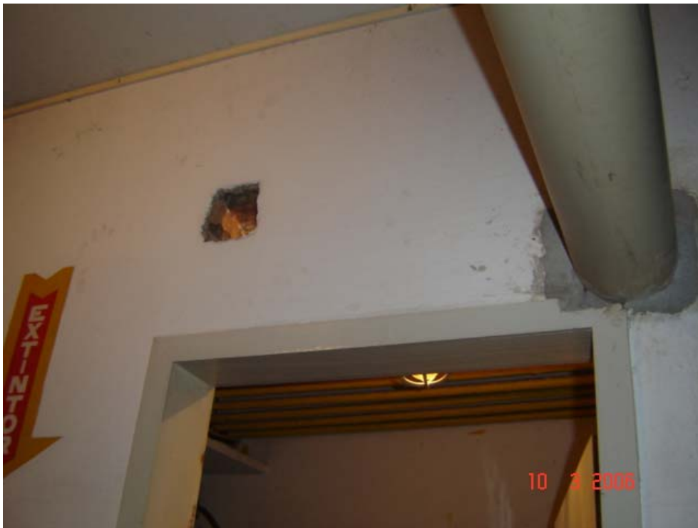
Foto 5.8.17 - Falta de preparação e acabamento final da pintura na parede da garagem localizada no subsolo.
