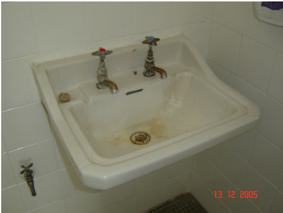
Foto 5.10.6. – Degradação (gretamento) das louças sanitárias.
