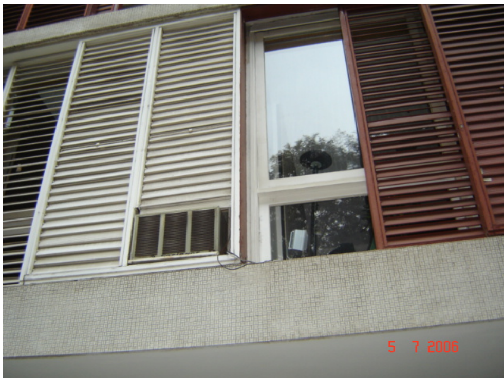
Foto 5.9.9 - Aspecto visual deficiente com a instalação de luminária sem respeitar os padrões do edifício com a fiação exposta na fachada principal.
