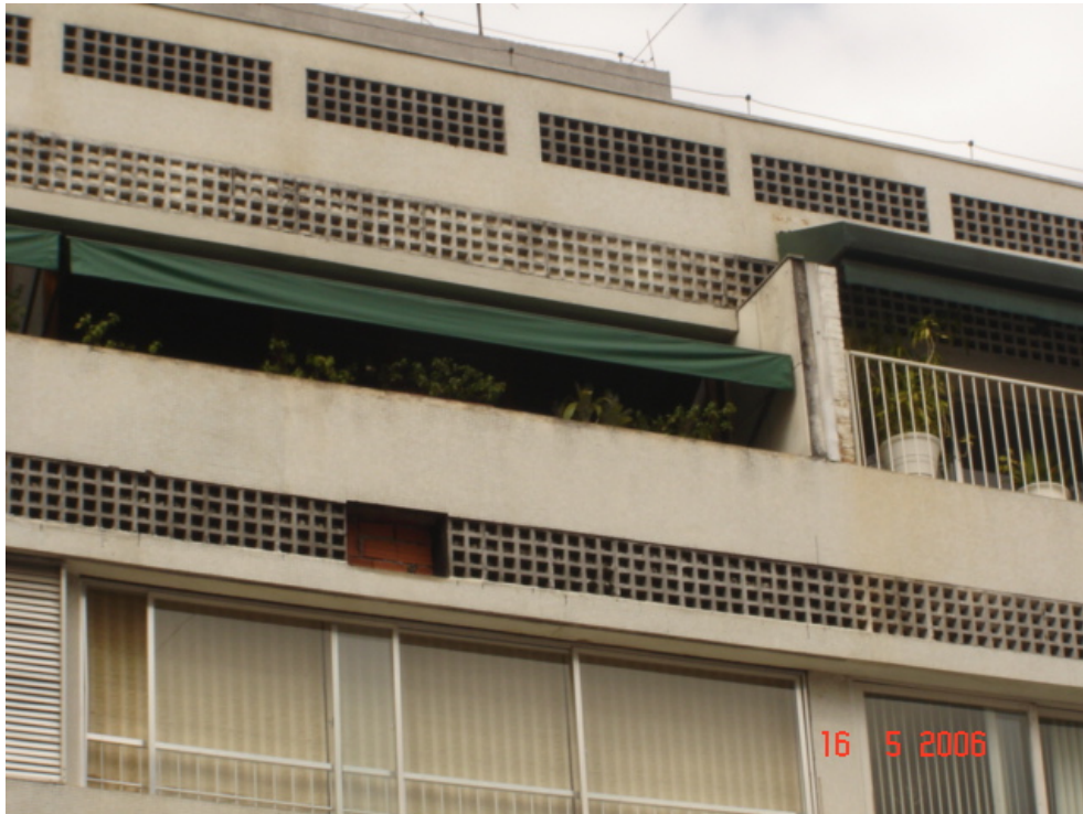
Foto 5.5.5 - Reconstrução inadequada do vedo de elemento vazado.
