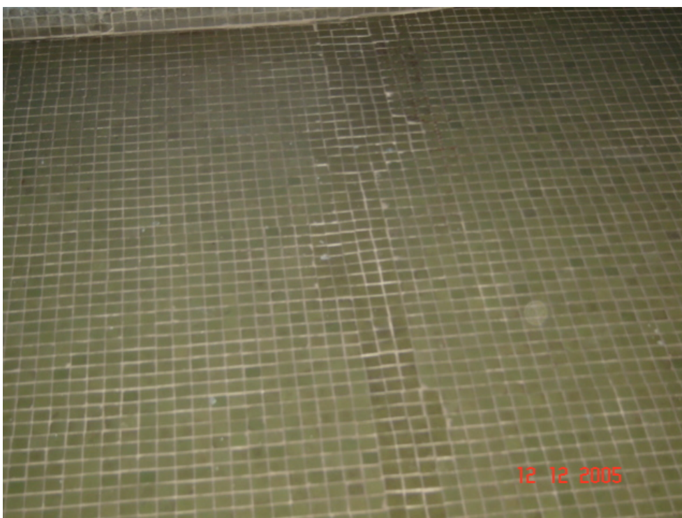
Foto 5.6.6. – Aspecto visual deficiente do piso tipo pastilha cerâmica localizado no hall social do pavimento térreo.
