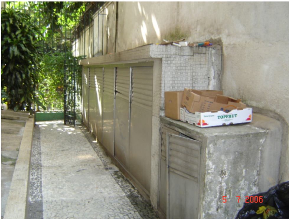
Foto 5.7.9 – Degradação da caixilharia de alumínio tipo veneziana.
