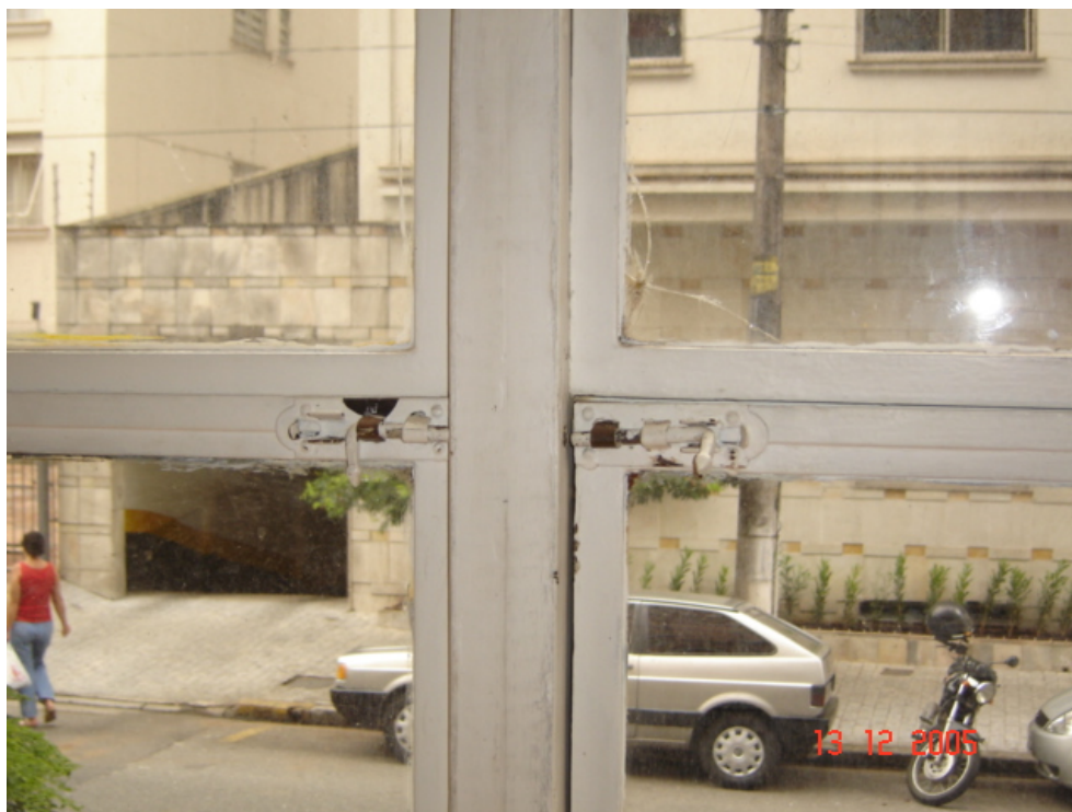
Foto 5.7.6. – Aspecto visual deficiente das esquadrias decorrente de adaptações de maneira generalizada de trincos nas folhas tipo guilhotina.
