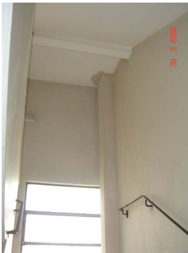
Foto 5.5.1 – Reconstrução inadequada da laje do patamar da escada.
