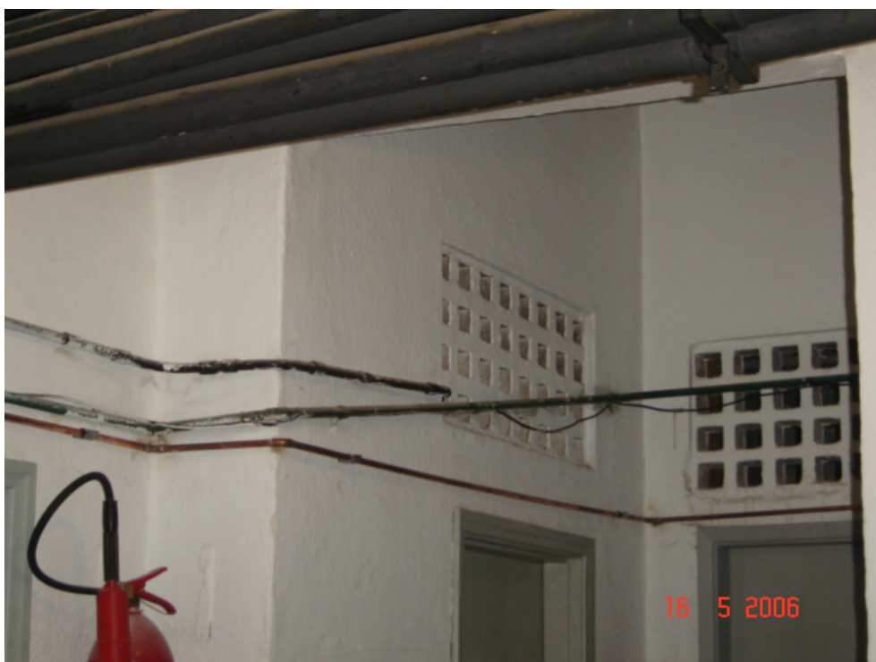
Foto 5.9.2 - Aspecto visual deficiente das instalações elétricas aparentes.
