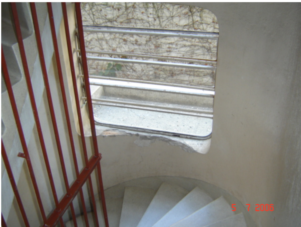
Foto 5.5.5 – Ausência de reconstrução de maneira generalizada do requadramento das janelas.
