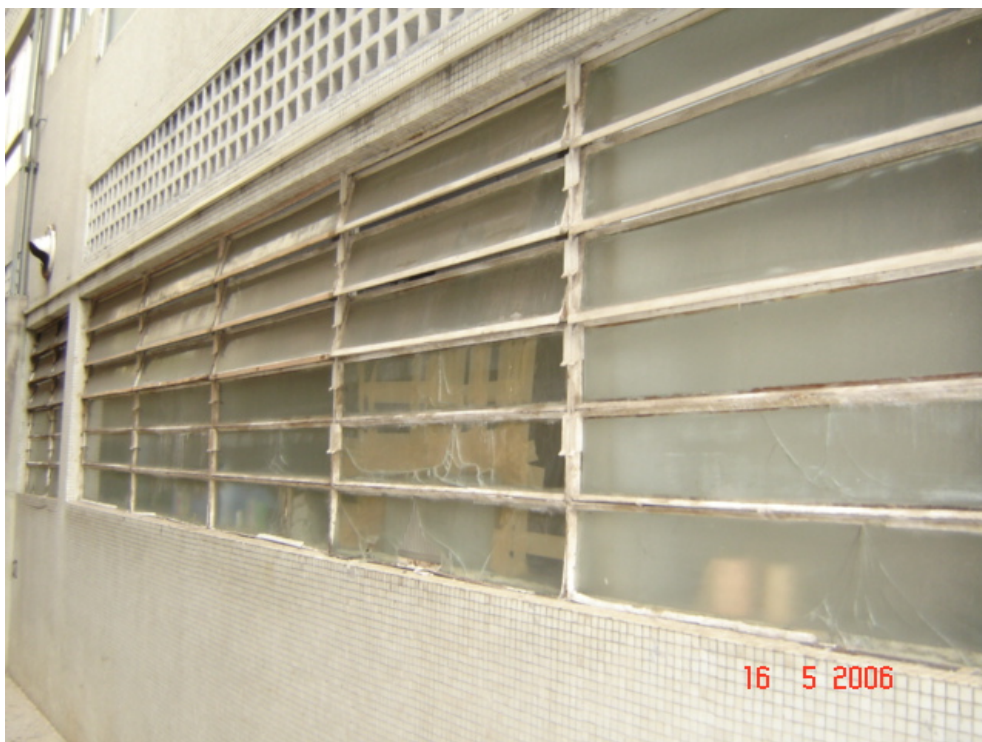
Foto 5.7.4 – Falta de substituição de vidros danificados.
