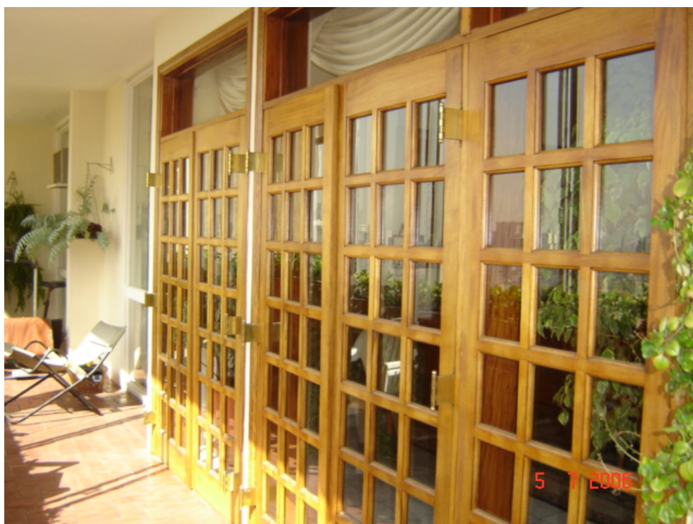
Foto 5.7.15 – Substituição da caixilharia por outra de material fora da especificação original do projeto.
