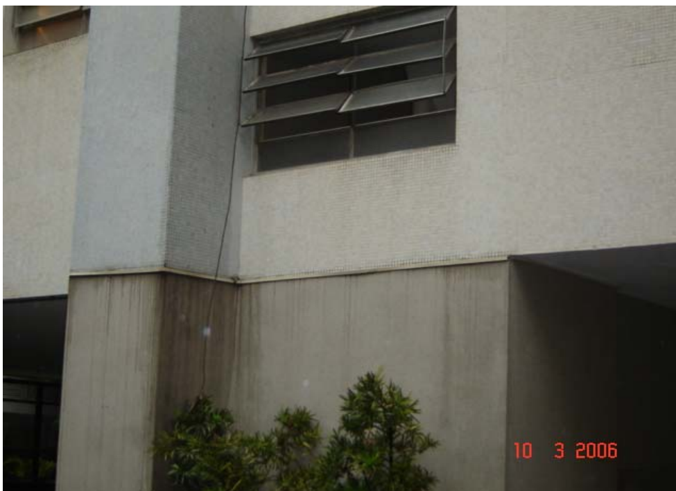
Foto 5.9.1 - Aspecto visual deficiente das instalações elétricas aparentes.
