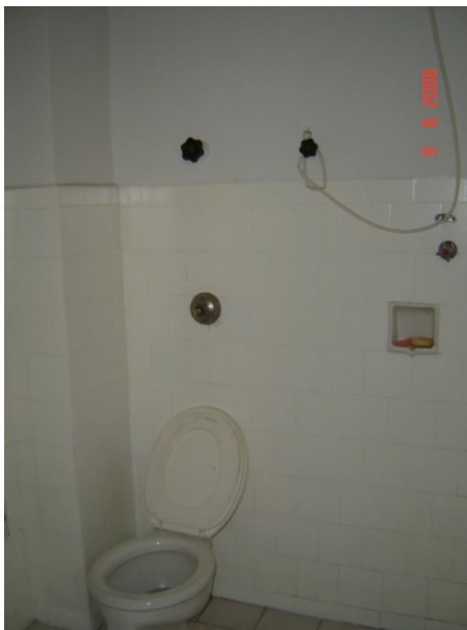
Foto 5.10.4 - Degradação dos metais sanitários dos sanitários.
