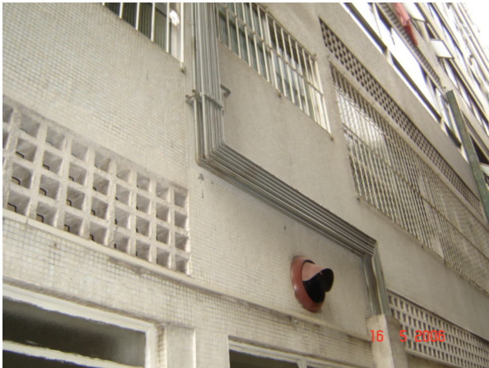
Foto 5.10.3 - Aspecto visual deficiente das instalações aparentes de gás.
