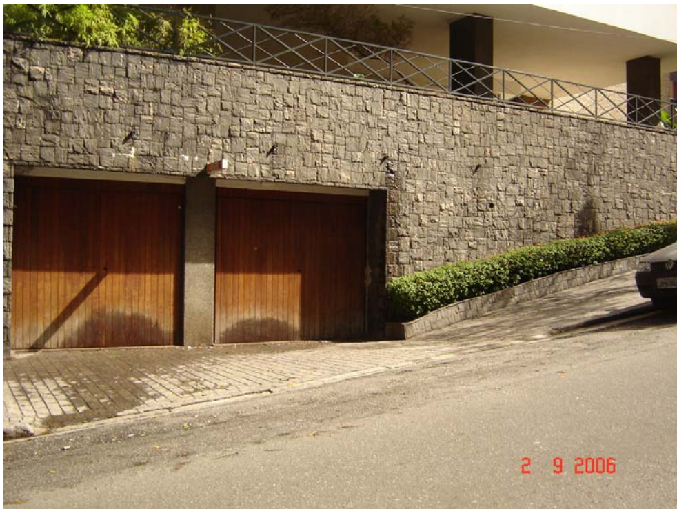
Foto 5.10.2 - Falta de sistema de drenagem interligando as floreiras localizadas no pavimento térreo.
