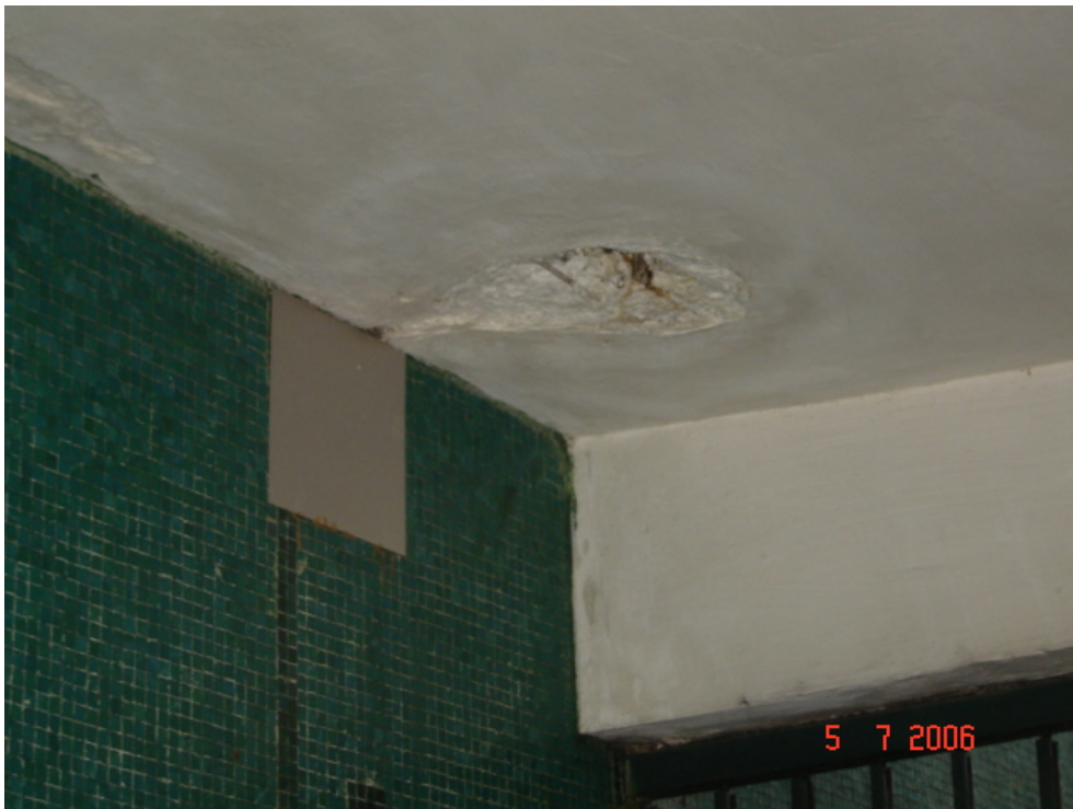
Foto 5.6.4 – Ausência de reconstrução da laje de piso localizada no pavimento subsolo.
