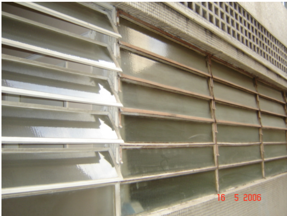
Foto 5.7.6 – Degradação da pintura da caixilharia.
