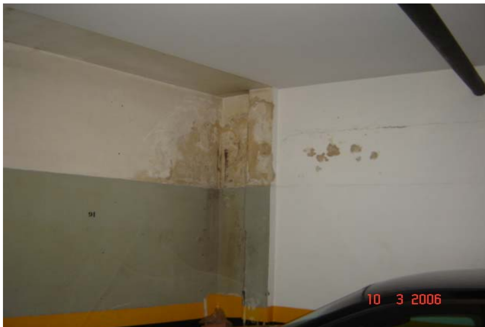
Foto 5.5.2 - Manchas nas paredes da garagem.
