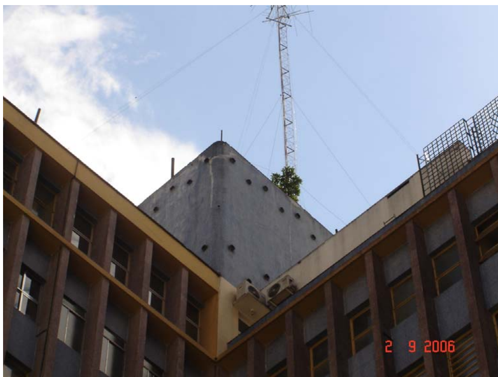
Foto 5.9.4 - Aspecto visual deficiente com a instalação de aparelho de ar condicionado.
