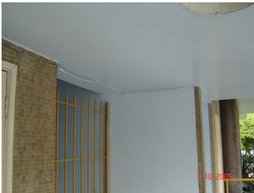
Foto 5.9.8. – Aspecto visual deficiente das instalações elétricas aparentes.
