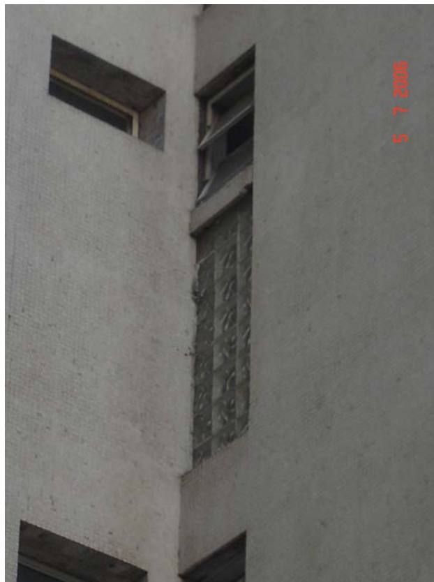
Foto 5.5.3 – Substituição do vedo de bloco de vidro sob a esquadria do sanitário do apartamento.
