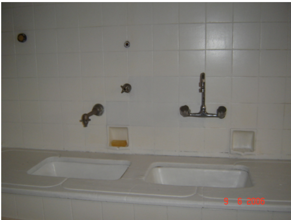
Foto 5.8.4 – Aspecto visual deficiente das paredes da cozinha.
