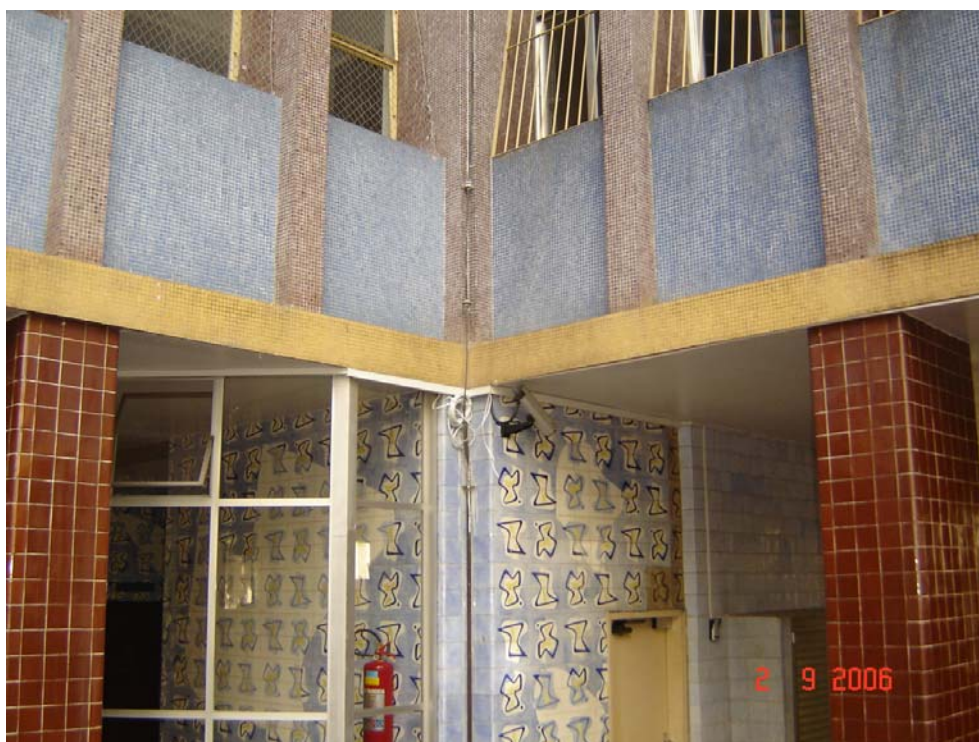
Foto 5.9.2 - Aspecto visual deficiente das instalações elétricas aparentes.
