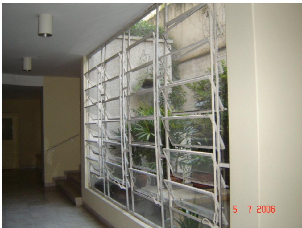
Foto 5.7.8 – Dificuldade de movimentação da caixilharia externa.
