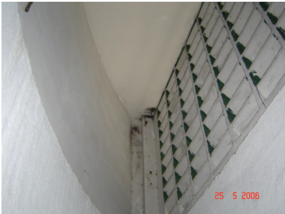
Foto 5.8.6 – Manchas nos tetos do sistema de ventilação da garagem.
