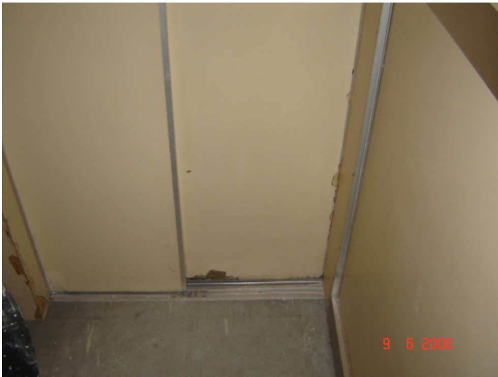
Foto 5.7.12 – Degradação do revestimento de laminado melamínico da porta do elevador de serviço.
