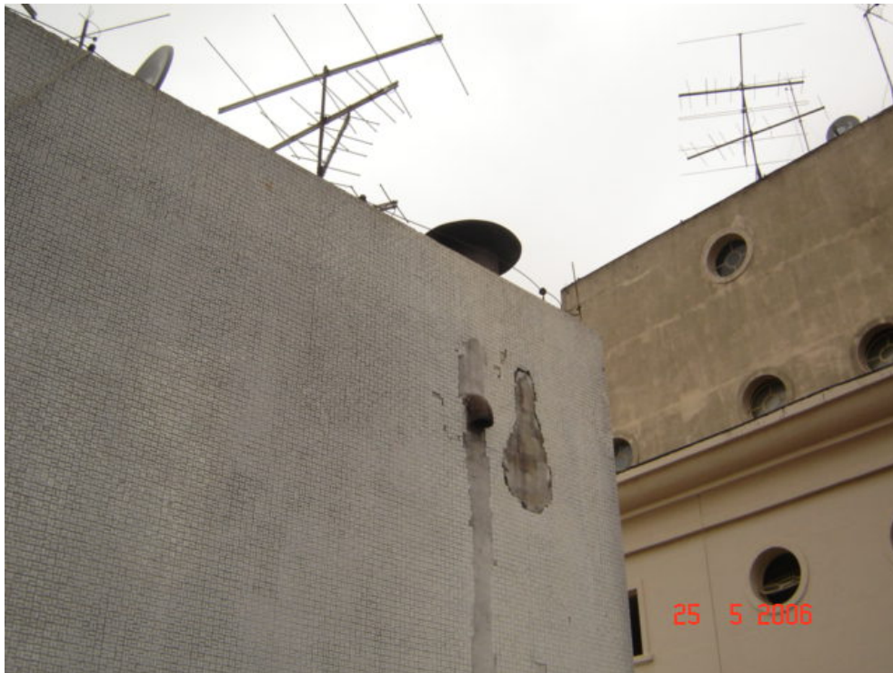
Foto 5.8.5 – Degradação dos revestimentos de pastilha cerâmica.
