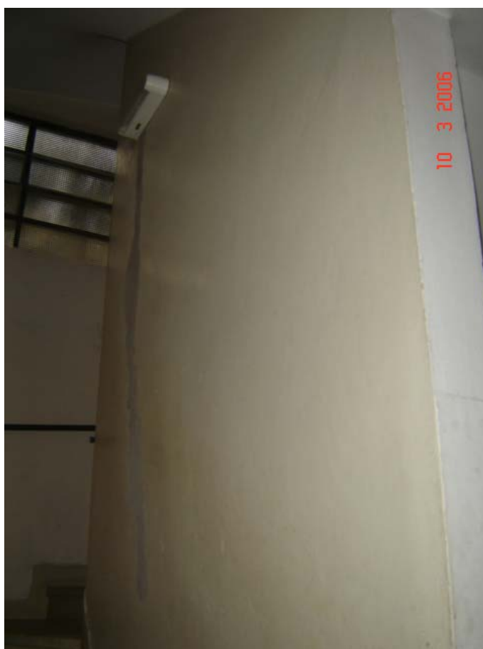
Foto 5.8.10 - Falta de acabamento final de preparação e pintura na parede da circulação vertical.
