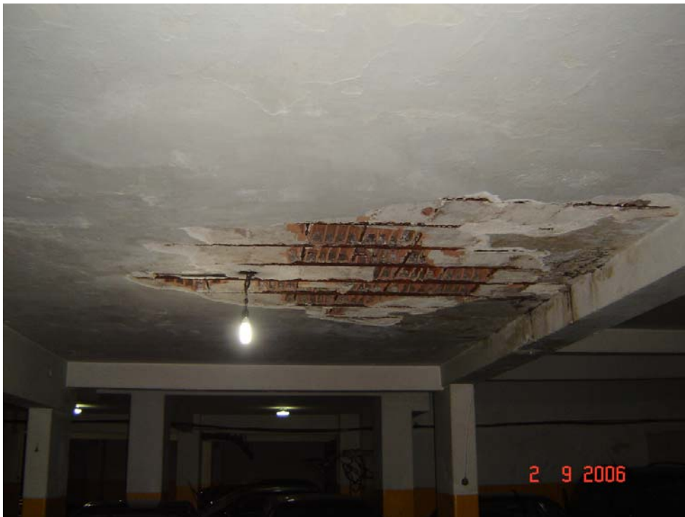
Foto 5.3.1 – Ausência de restauro da laje do estacionamento localizado no pavimento subsolo.
