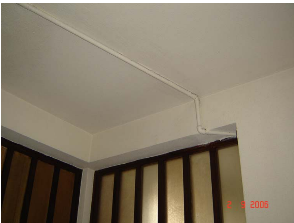
Foto 5.10.1 - Instalação aparente de tubulação de água fria no teto.
