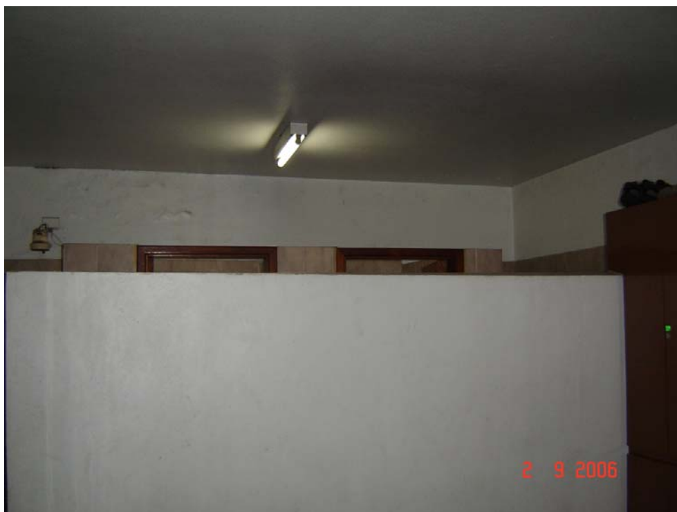
Foto 5.8.4 – Degradação da pintura Látex tipo PVA do sanitário de funcionários.
