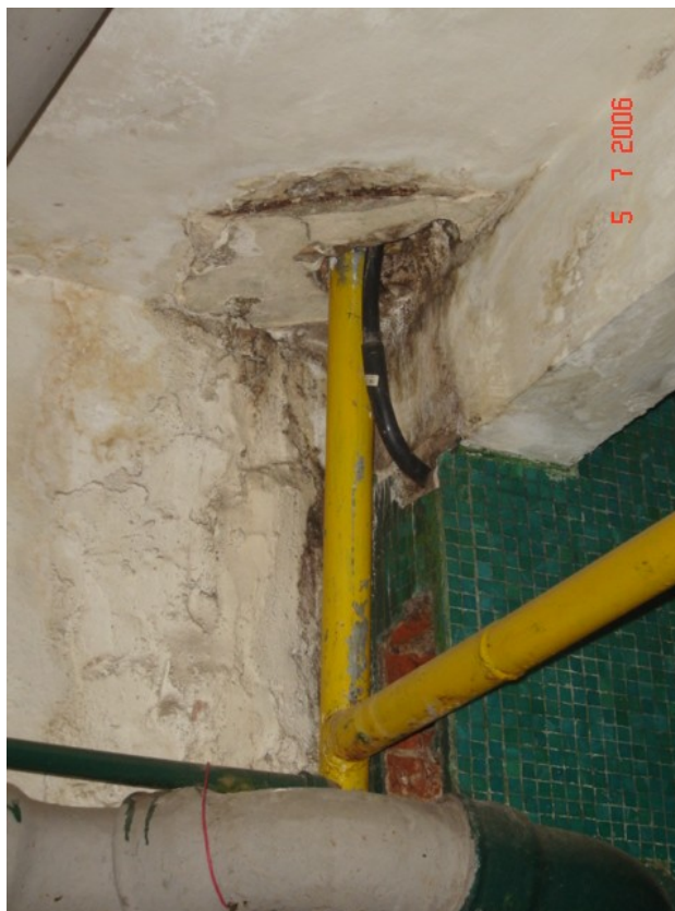
Foto 5.10.4 - Aspecto visual deficiente da tubulação de abastecimento de gás aparente localizada no teto da garagem do pavimento subsolo.
