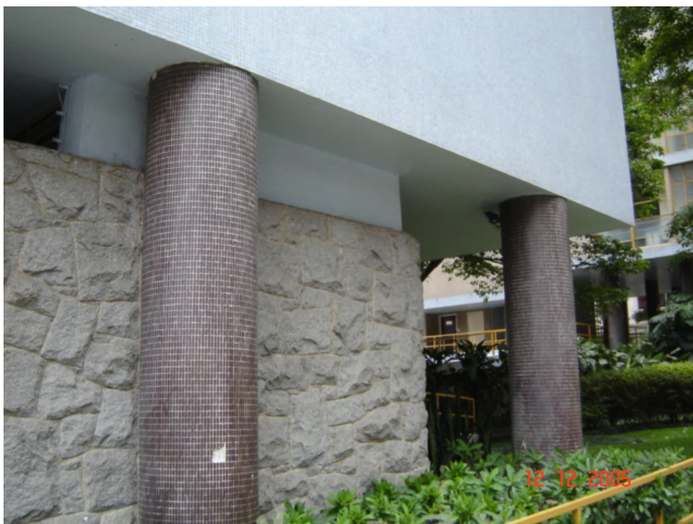
Foto 5.5.3. – Aspecto visual deficiente com a construção de alvenaria sobre a parede de pedra no pavimento térreo.
