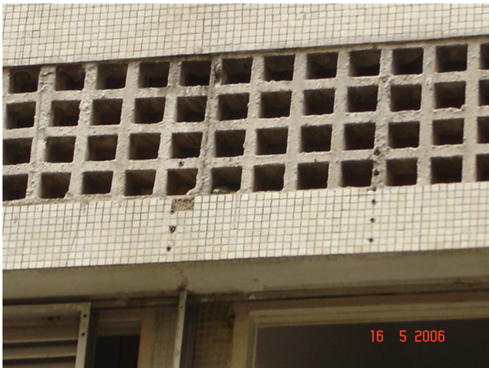
Foto 5.8.2 – Degradação dos revestimentos de pastilha cerâmica.
