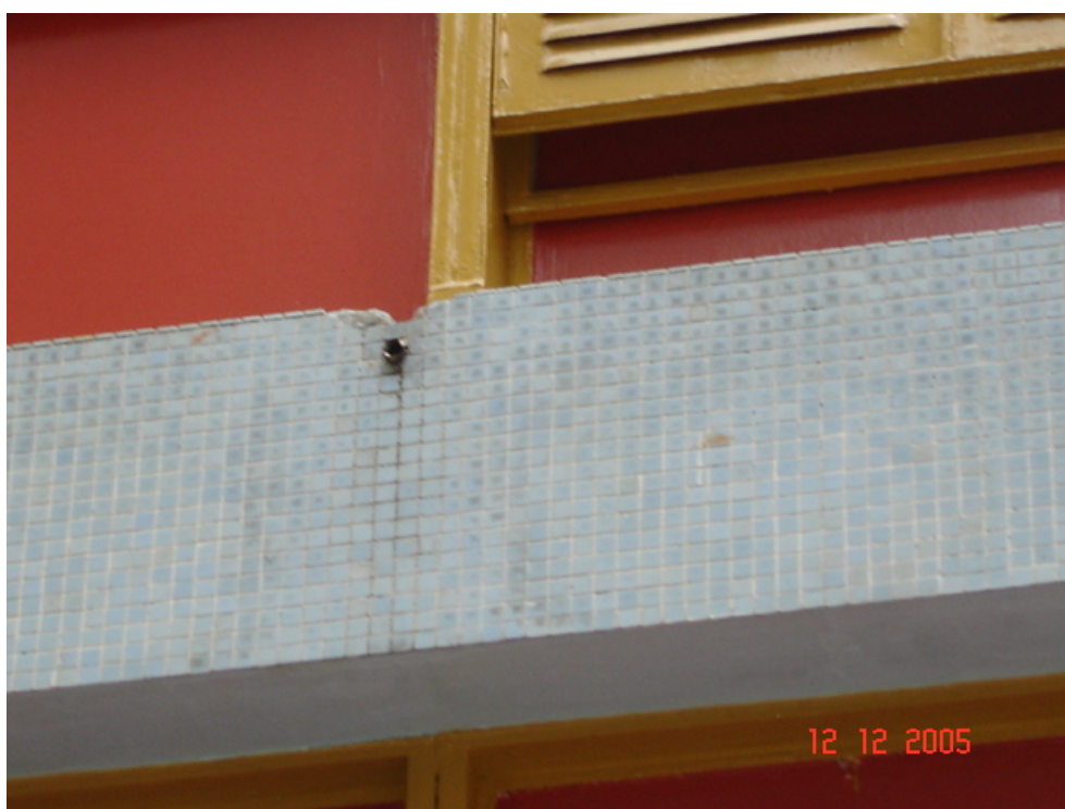
Foto 5.8.2. – Degradação pontual dos revestimentos externos localizados nas vigas de piso, acima do buzinode.
