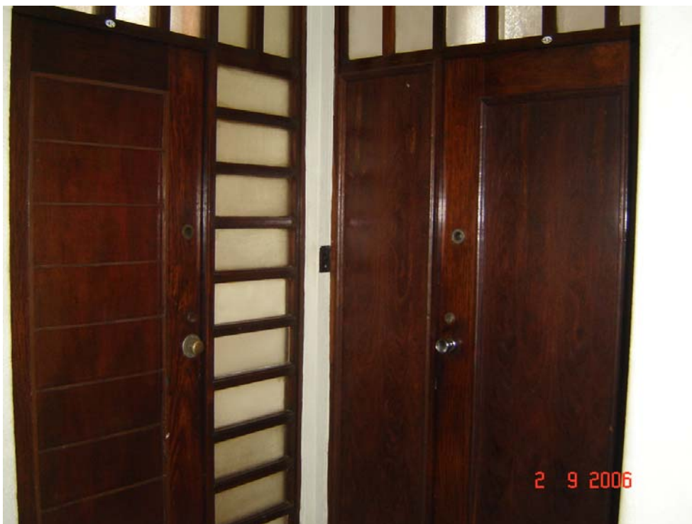
Foto 5.7.7 – Substituição de caixilharia de maneira generalizada por outra de material e desenho fora da especificação original do projeto.
