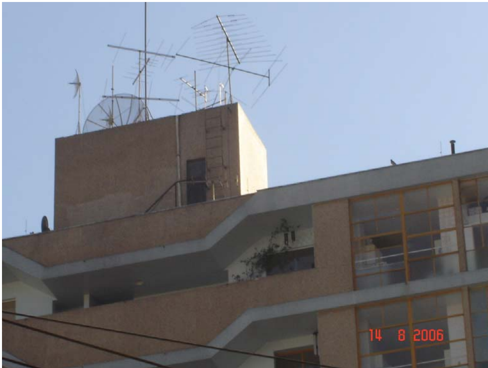
Foto 5.10.4. – Ausência de reservatório de água para incêndio.
