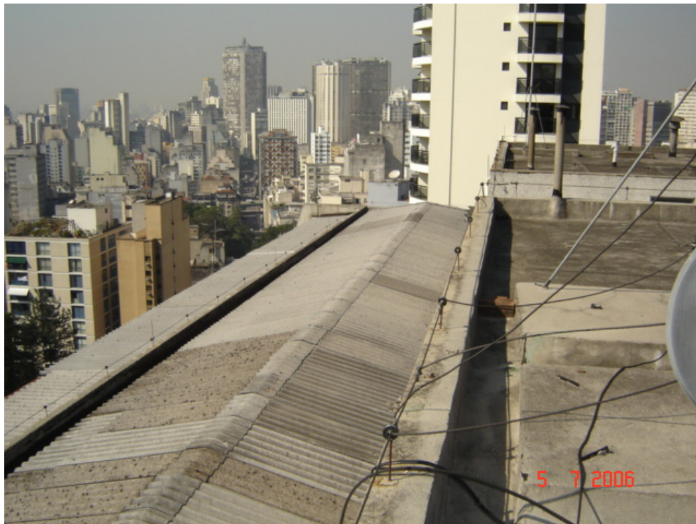
Foto 5.4.3 – Distribuição generalizada de cabos de televisão sobre as telhas, lajes, rufos e calhas.
