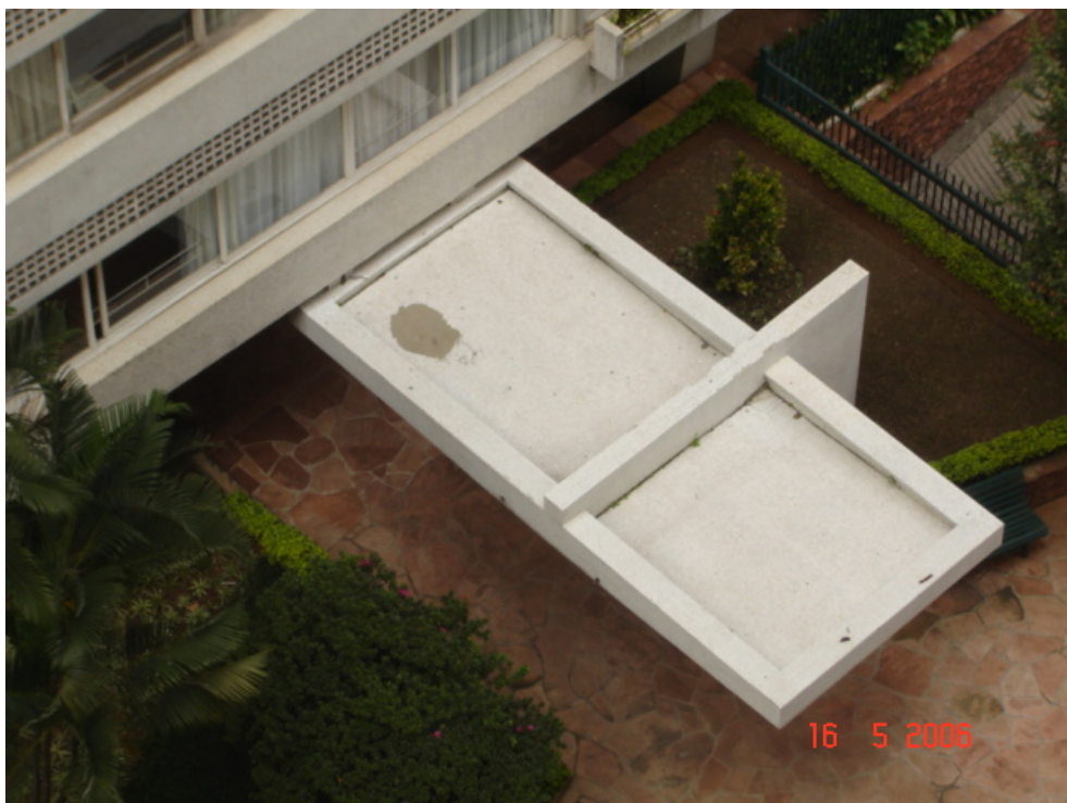
Foto 5.8.6 – Degradação dos revestimentos de pastilha cerâmica.
