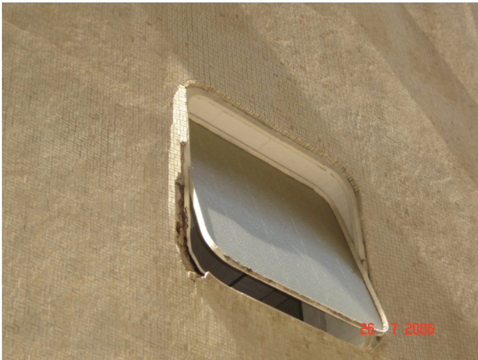
Foto 5.8.2 – Pastilha do contorno da janela do sanitário do apartamento Nº 44 em processo de descolamento.
