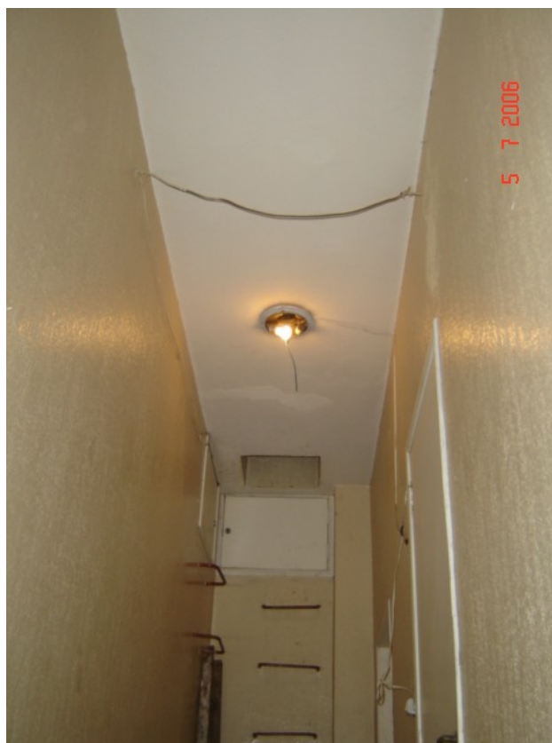
Foto 5.9.2 - Aspecto visual deficiente das instalações elétricas aparentes.
