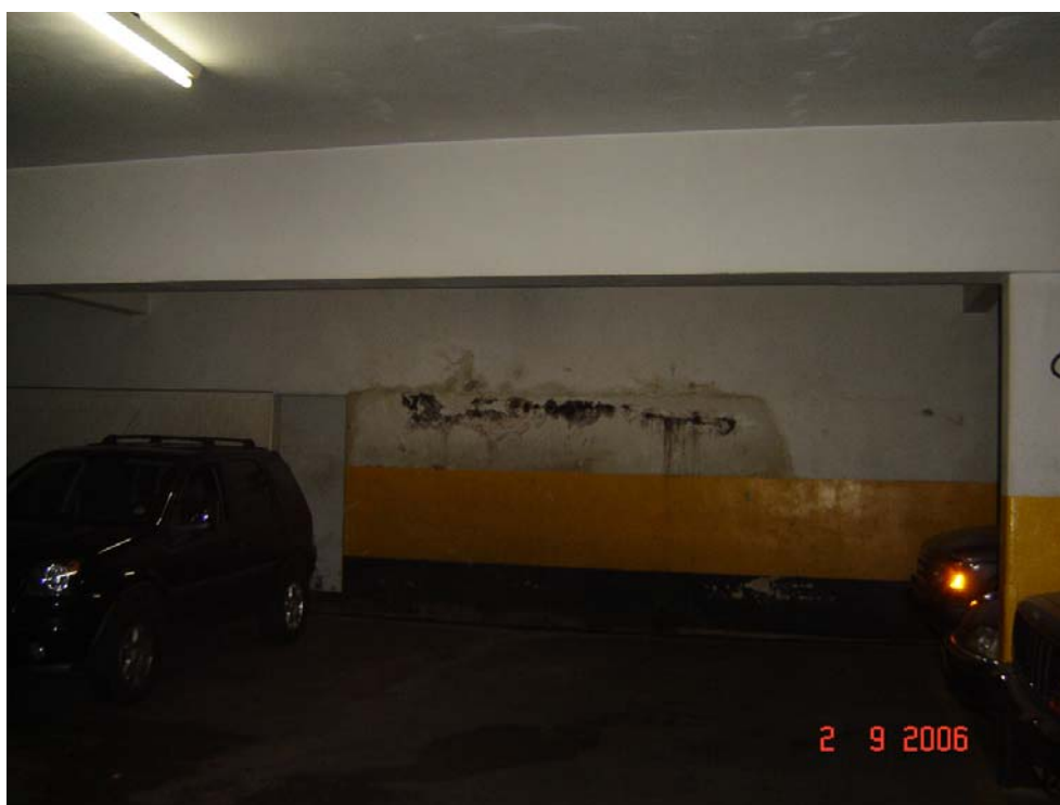
Foto 5.5.1 – Mancha nas paredes da garagem localizada no subsolo.
