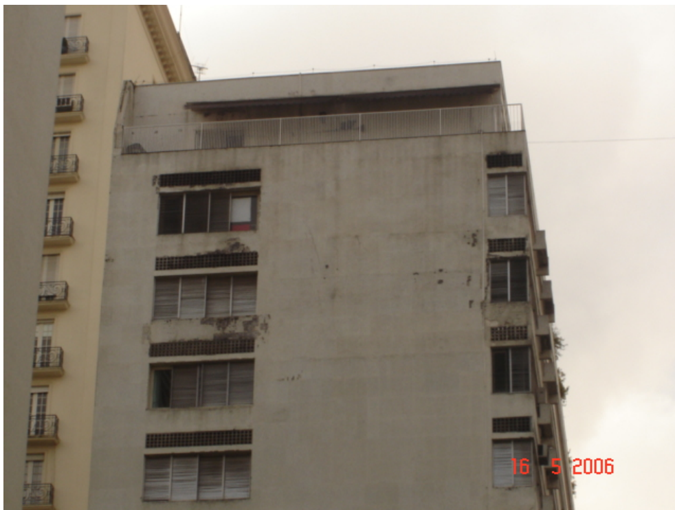
Foto 5.8.4 – Degradação dos revestimentos de pastilha cerâmica.
