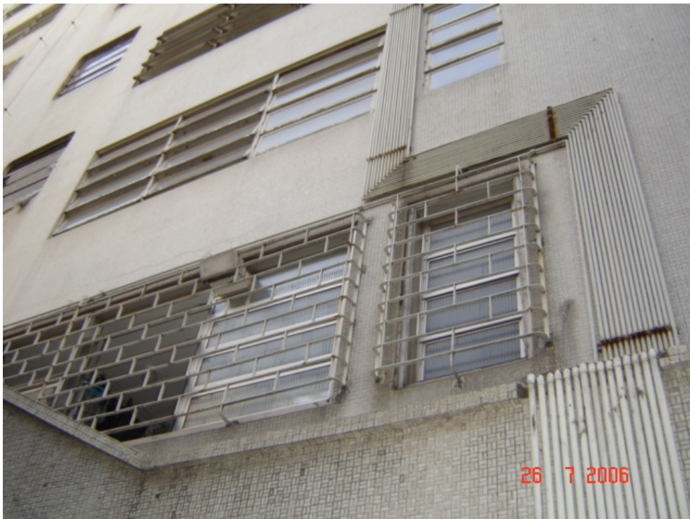
Foto 5.10.2 - Instalação aparente de sistema de distribuição de gás.
