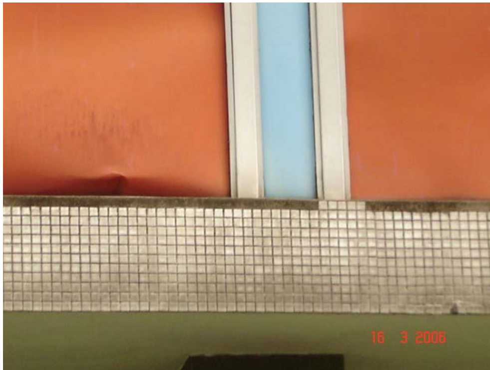
Foto 5.8.9 - Degradação do revestimento de pastilha cerâmica localizada na viga inferior que recebe a caixilharia da fachada nordeste.
