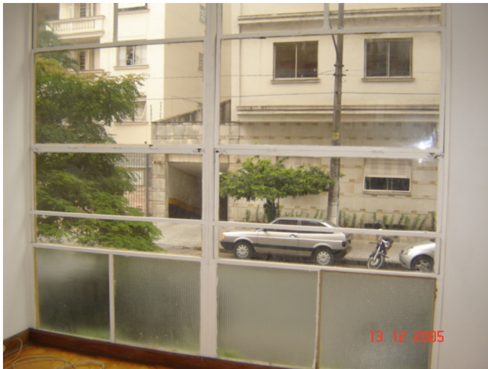
Foto 5.7.2. – Dificuldade de acionamento das partes móveis da caixilharia.
