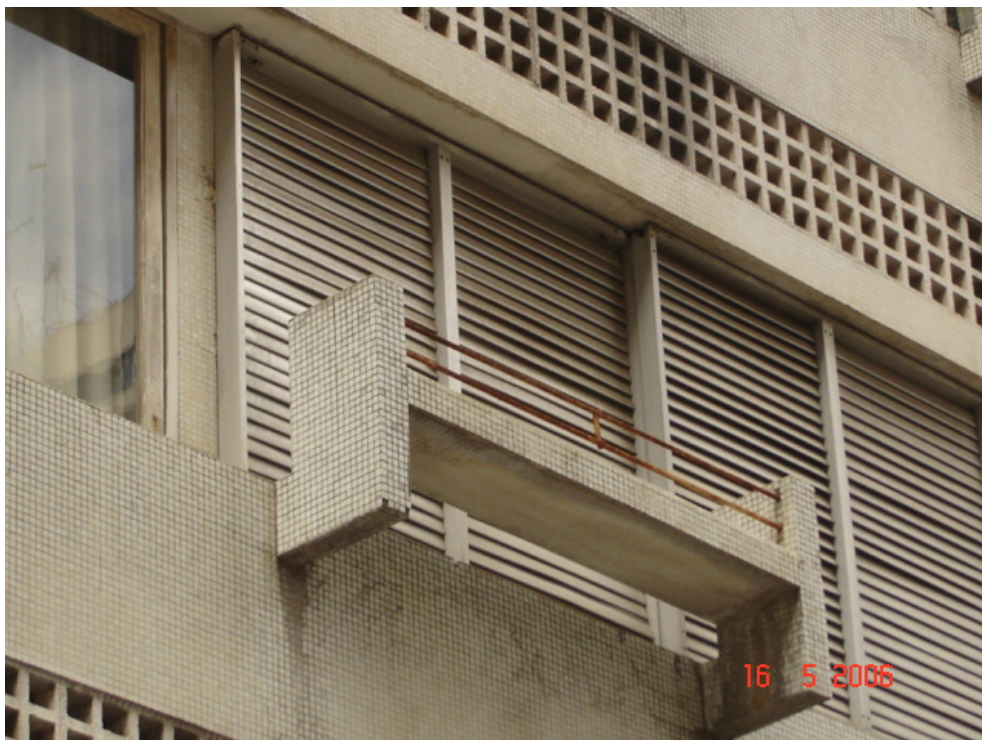
Foto 5.7.8 – Degradação de forma acentuada do gradil.
