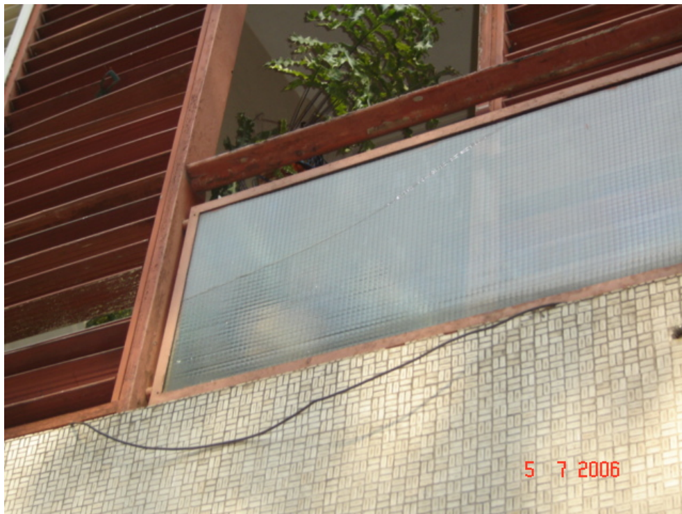
Foto 5.9.8 - Aspecto visual deficiente com a instalação elétrica aparente.
