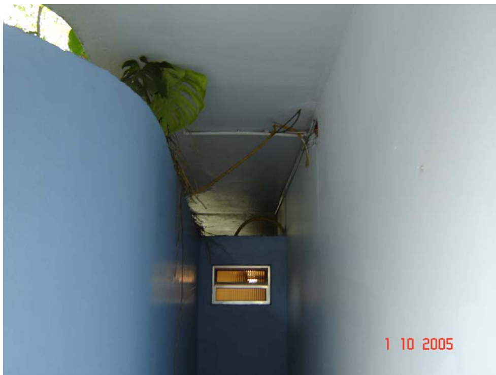
Foto 5.9.7. – Aspecto visual deficiente das instalações elétricas aparentes.
