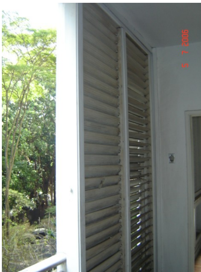
Foto 5.7.16 – Dificuldade de movimentação da caixilharia externa de madeira composta por grandes painéis de correr.
