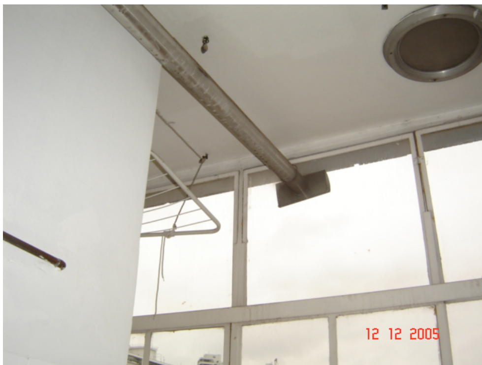
Foto 5.10.2. – Aspecto visual deficiente das esquadrias localizadas no estar social decorrente da eliminação das esquadrias do jardim de inverno.
