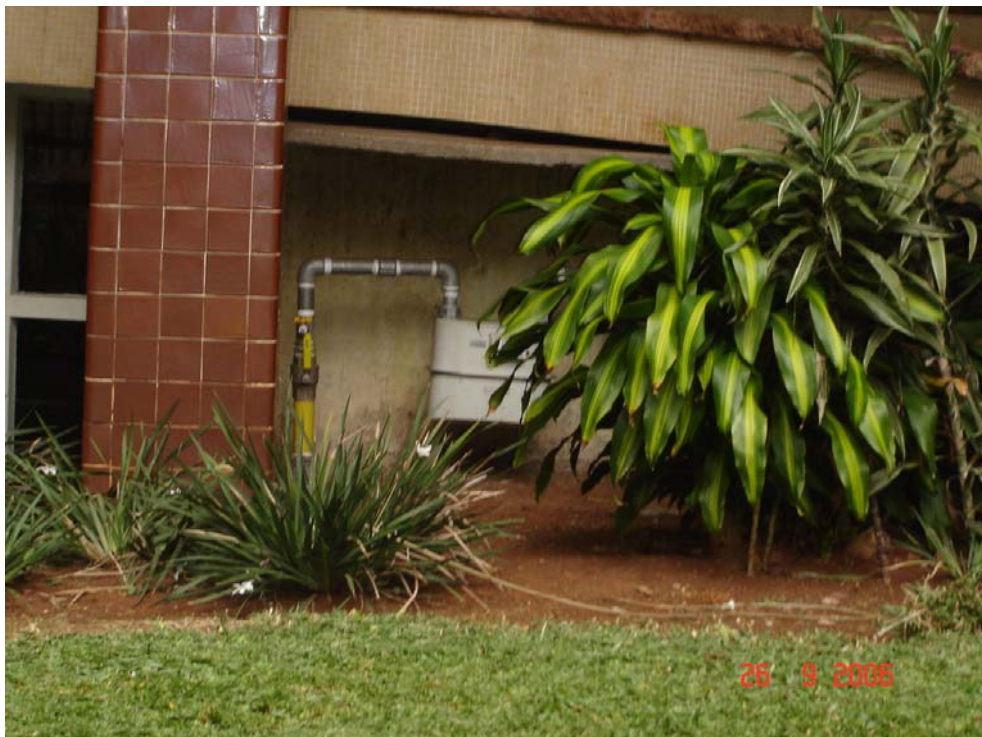
Foto 5.9.10 - Aspecto visual deficiente com a instalação de aparelho medidor de gás inclusive tubulação de forma aparente.
