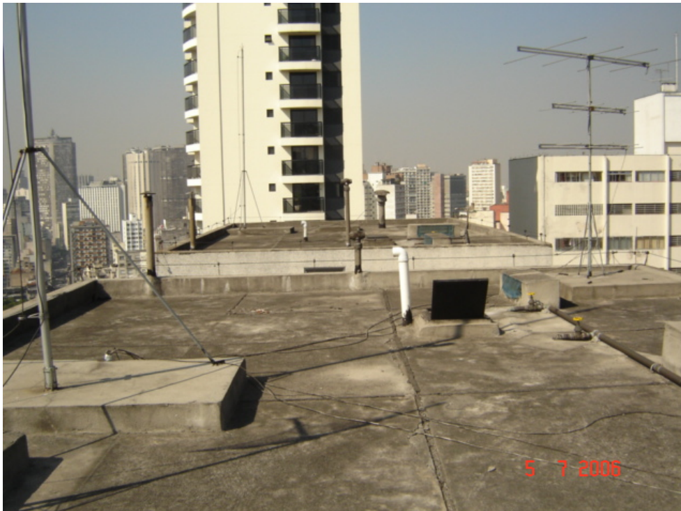
Foto 5.9.3 - Aspecto visual deficiente das instalações elétricas aparentes.
