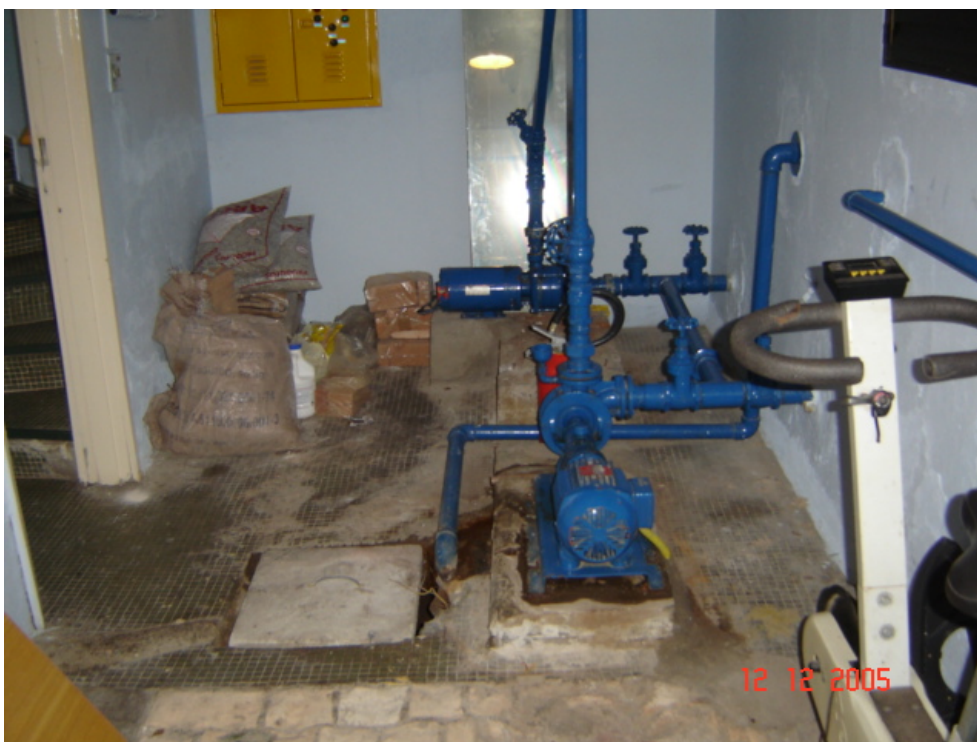
Foto 5.6.8. – Aspecto visual deficiente do piso tipo pastilha cerâmica da casa de bombas.
