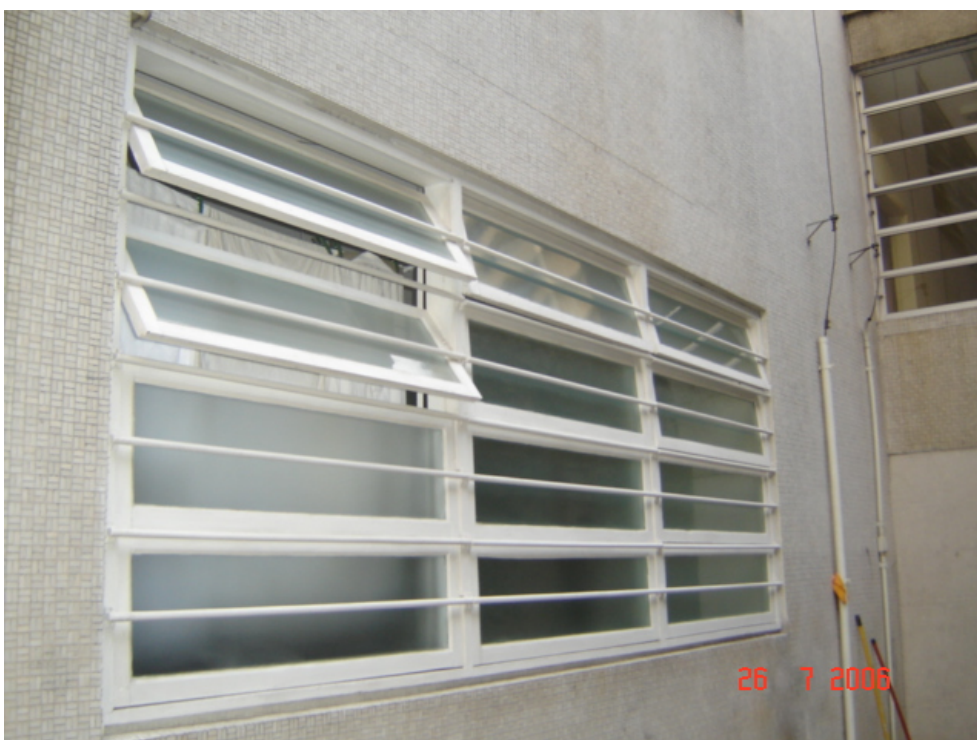
Foto 5.7.21 – Substituição de vidros sem respeitar a especificação original do projeto.
