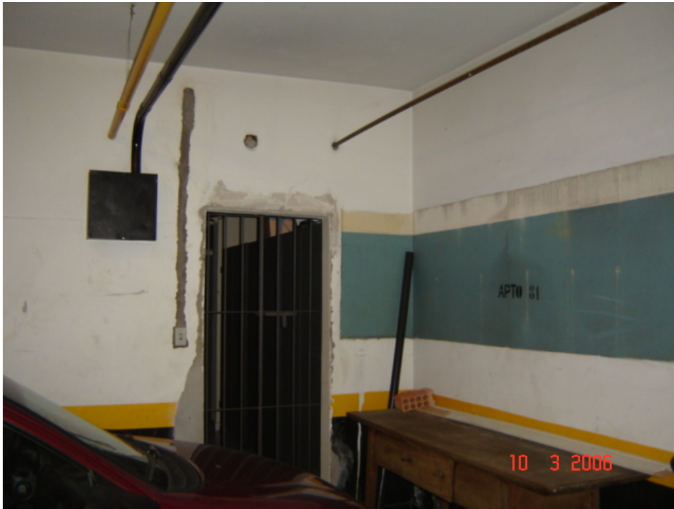
Foto 5.8.12 - Falta de preparação e acabamento final da pintura na parede da garagem para instalação de porta tipo grade.
