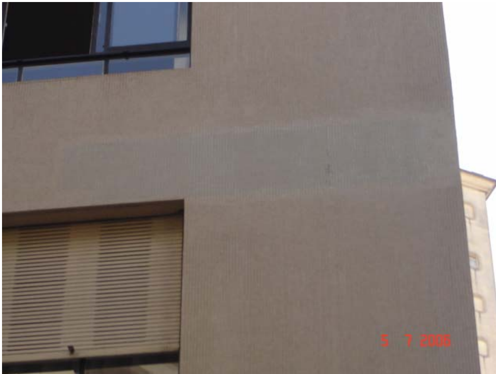
Foto 5.8.2 – Reposição de pastilha de coloração diferente da original na fachada lateral, voltada para a Rua Bahia.
