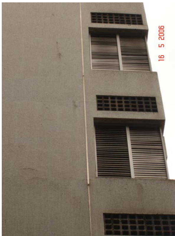
Foto 5.9.1 - Aspecto visual deficiente das instalações elétricas aparentes.
