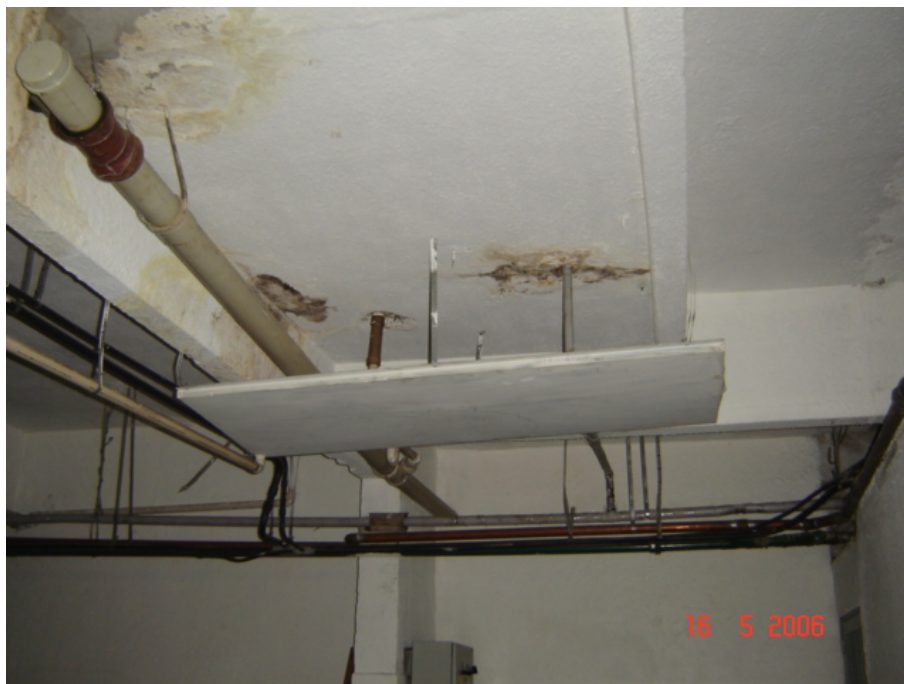
Foto 5.10.1 - Solução inadequada para resolver a coleta de águas proveniente de infiltrações do pavimento térreo.
