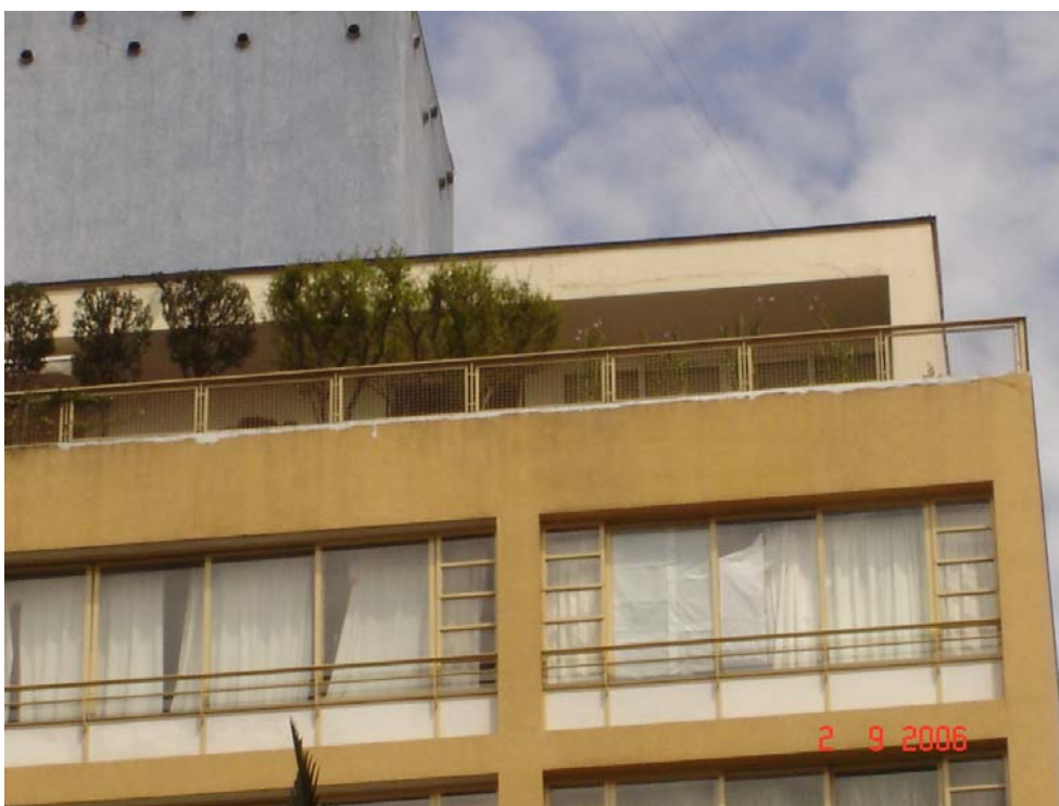
Foto 5.8.8 – Carência de reposição de pastilha cerâmica sobre a mureta dos apartamentos localizados no pavimento cobertura.
