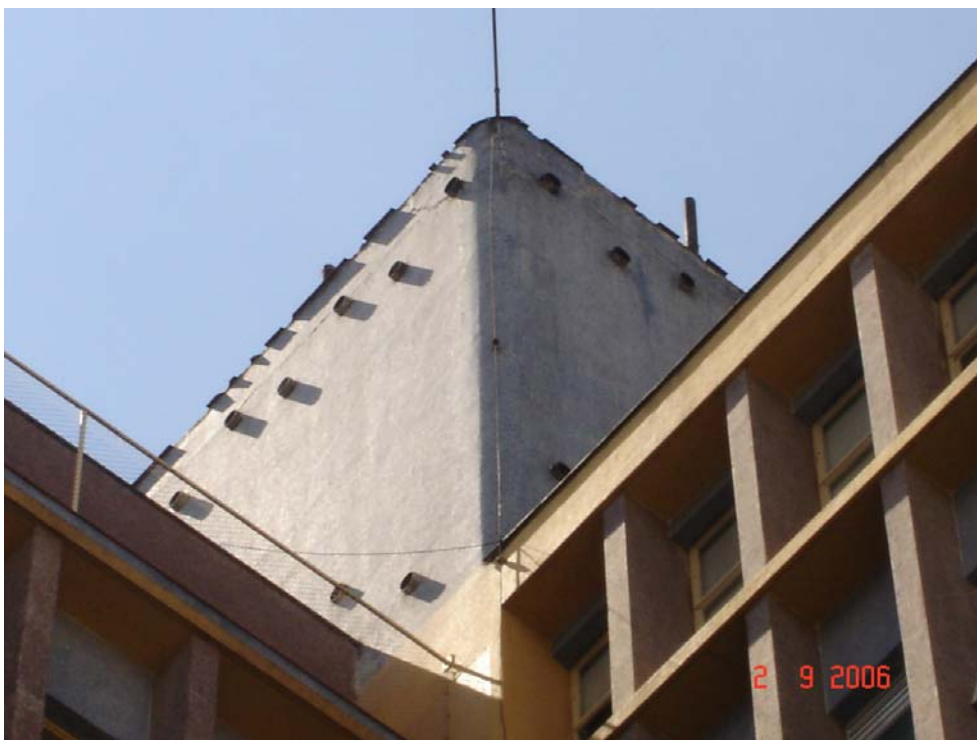
Foto 5.8.7 – Carência de reposição e restauro do revestimento tipo pastilha cerâmica do volume da caixa d'água.
