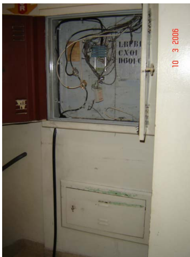
Foto 5.9.2 - Aspecto visual deficiente generalizado das instalações elétricas aparentes.
