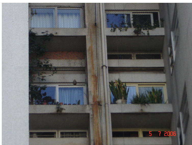
Foto 5.5.1 – Construção inadequada de alvenaria, sem acabamento final.
