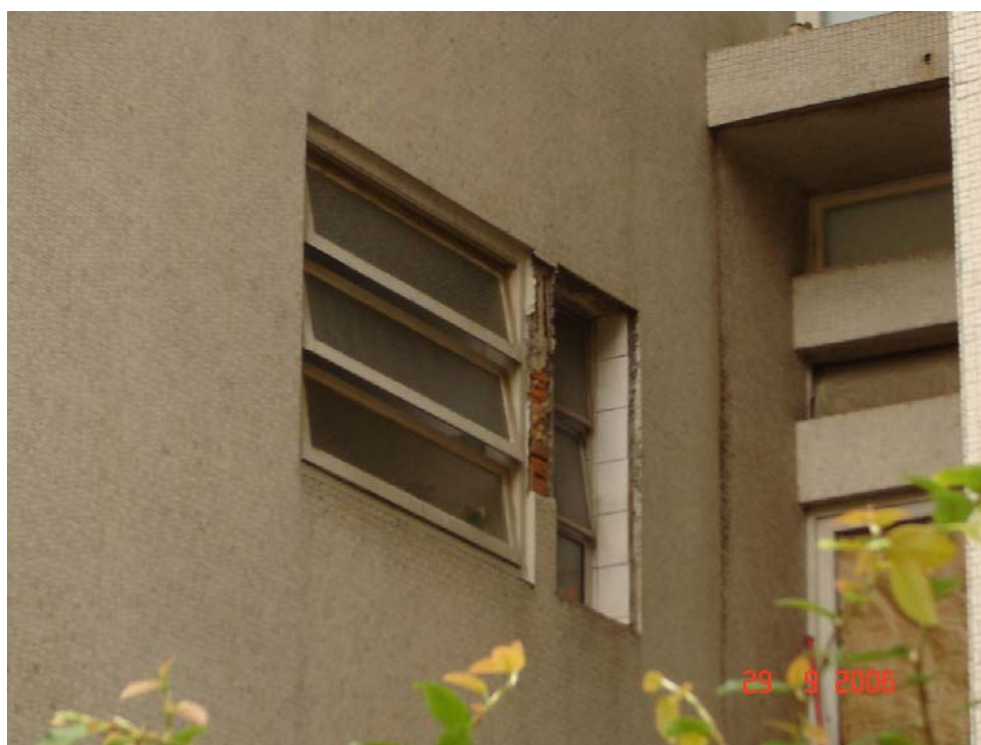
Foto 5.8.10 – Demolição indevida do revestimento com pastilha cerâmica, decorrente da transferência do caixilho para a face interna da parede do sanitário do apartamento Nº 33.
