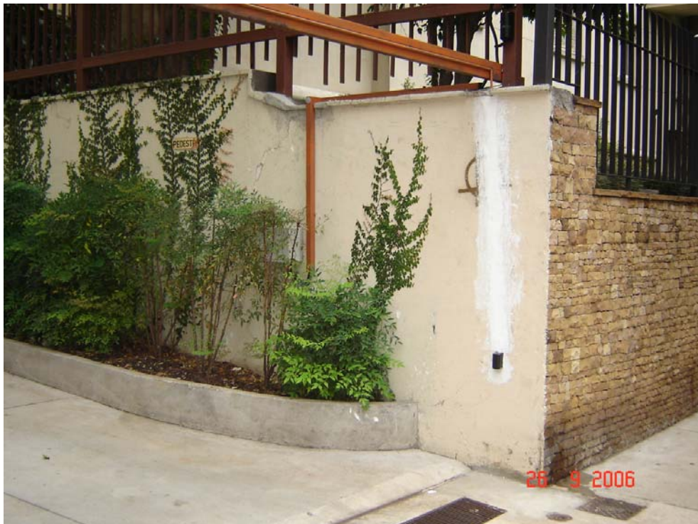
Foto 5.8.10 – Muro da divisa carente de finalização do acabamento final.
