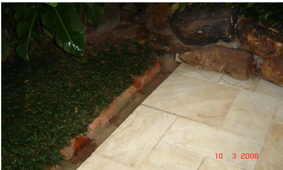
Foto 5.1.2 - Calha improvisada com telha de barro.
