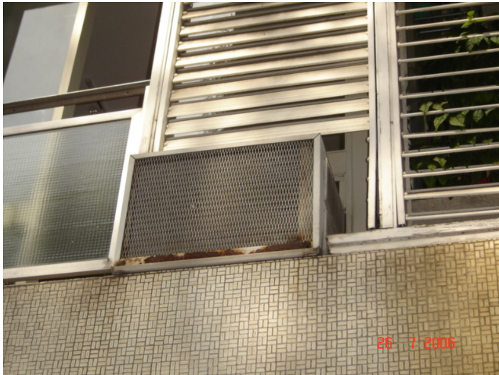
Foto 5.9.6 - Aspecto visual deficiente com a instalação de aparelho de ar condicionado diretamente na esquadria.
