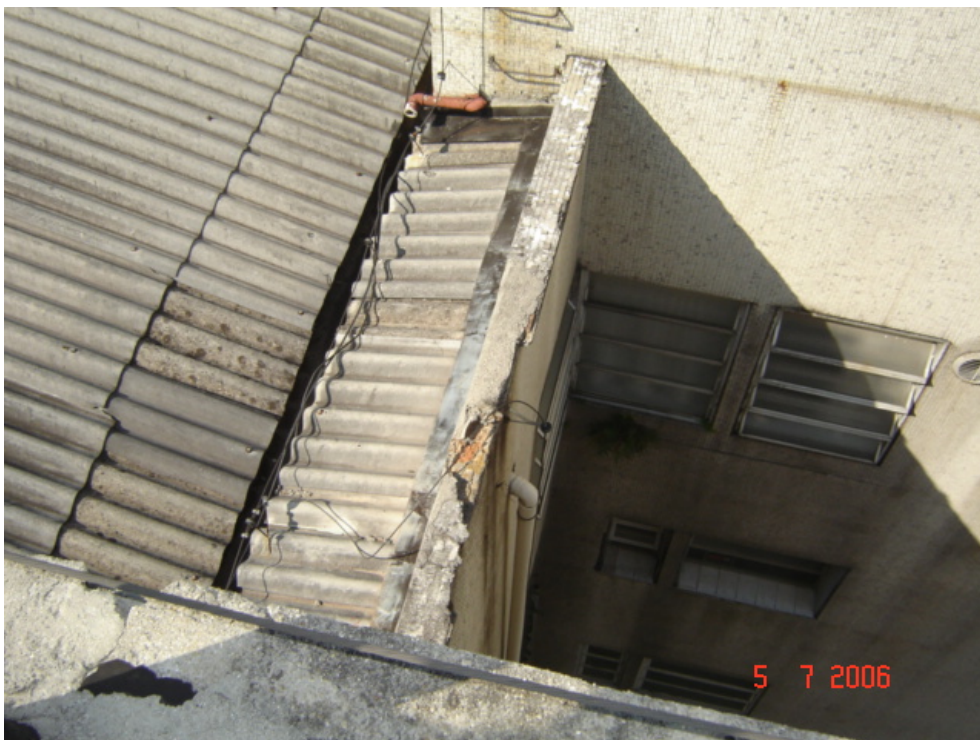
Foto 5.5.4 – Ausência de reconstrução das platibandas.
