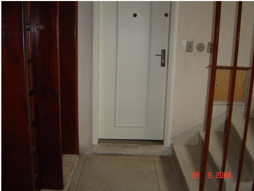
Foto 5.6.6 – Piso elevado da cozinha do apartamento Nº 153, com alteração do projeto original.
