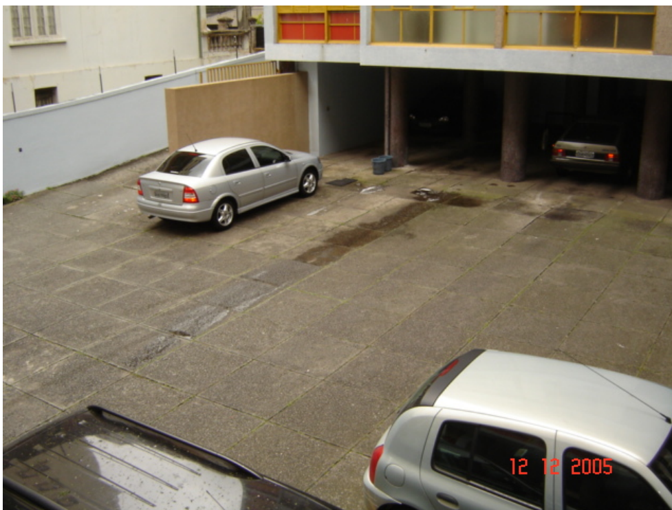
Foto 5.6.4. – Degradação das placas de concreto armado do estacionamento.
