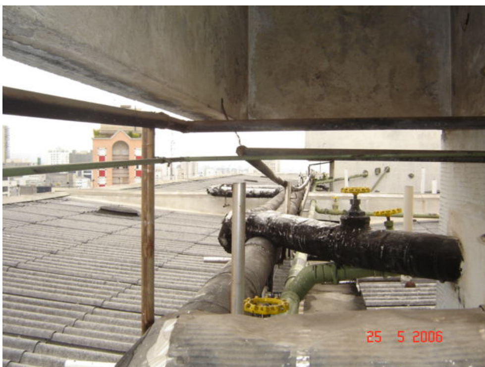
Foto 5.10.2 - Aspecto visual deficiente das instalações hidráulicas.
