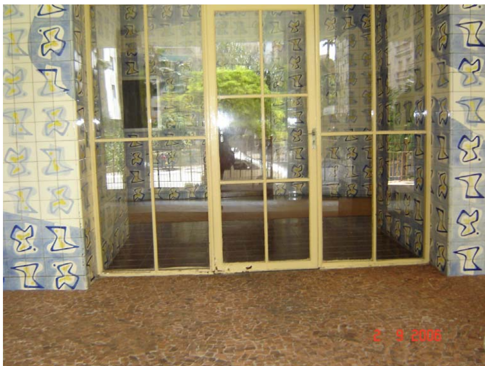
Foto 5.7.8 – Degradação de maneira generalizada da pintura de esmalte sintético da caixilharia de chapa de ferro.
