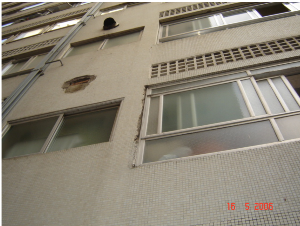
Foto 5.5.7 – Construção inadequada da alvenaria.
