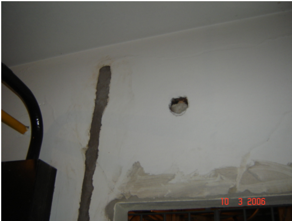
Foto 5.8.11 - Falta de preparação e acabamento finais de pintura da parede da garagem para instalação de interruptor elétrico de iluminação.
