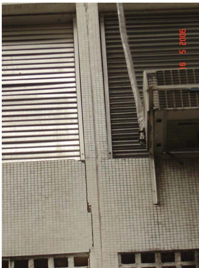
Foto 5.9.4 - Aspecto visual deficiente das instalações elétricas aparentes.
