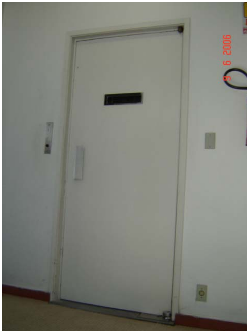
Foto 5.8.3 – Degradação da pintura Látex tipo PVA do hall de serviço.
