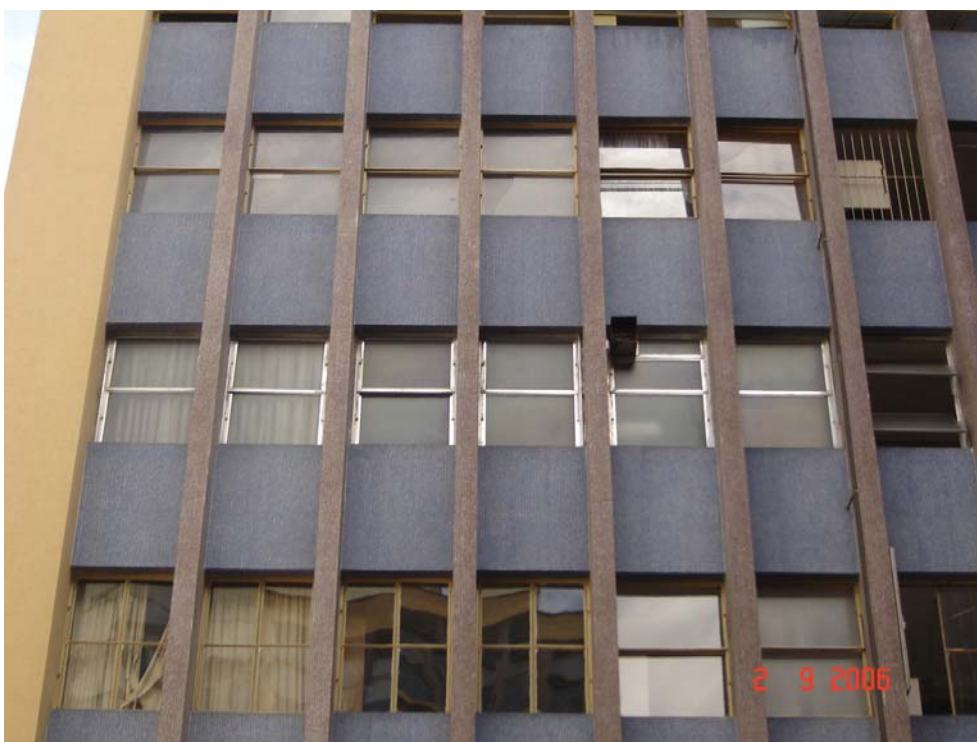
Foto 5.7.3 Substituição de caixilharia por outra de material fora da especificação original do projeto.
