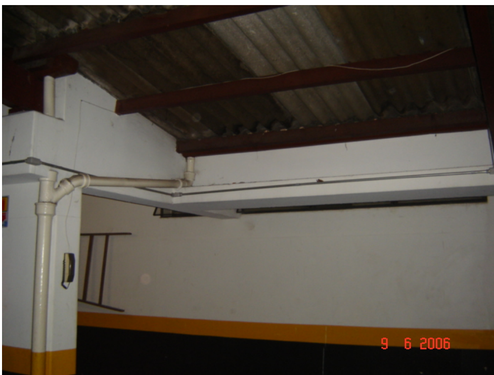
Foto 5.9.5 - Aspecto visual deficiente com a instalação de interfonos.
