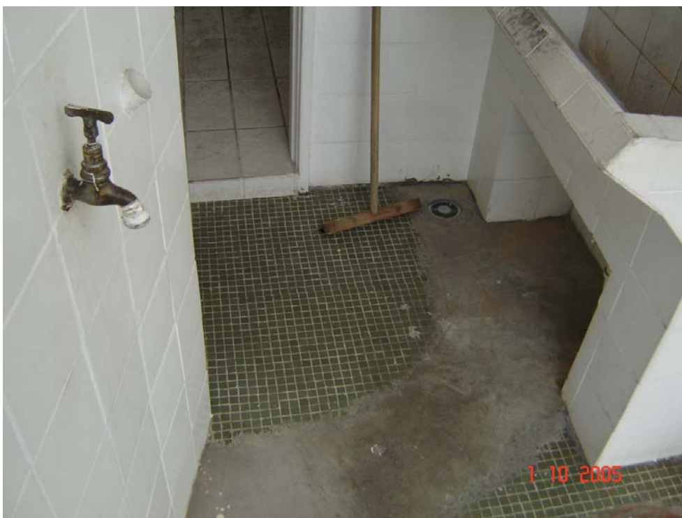
Foto 5.6.3. – Aspecto visual deficiente do piso da lavanderia para reparos da tubulação do ralo.
