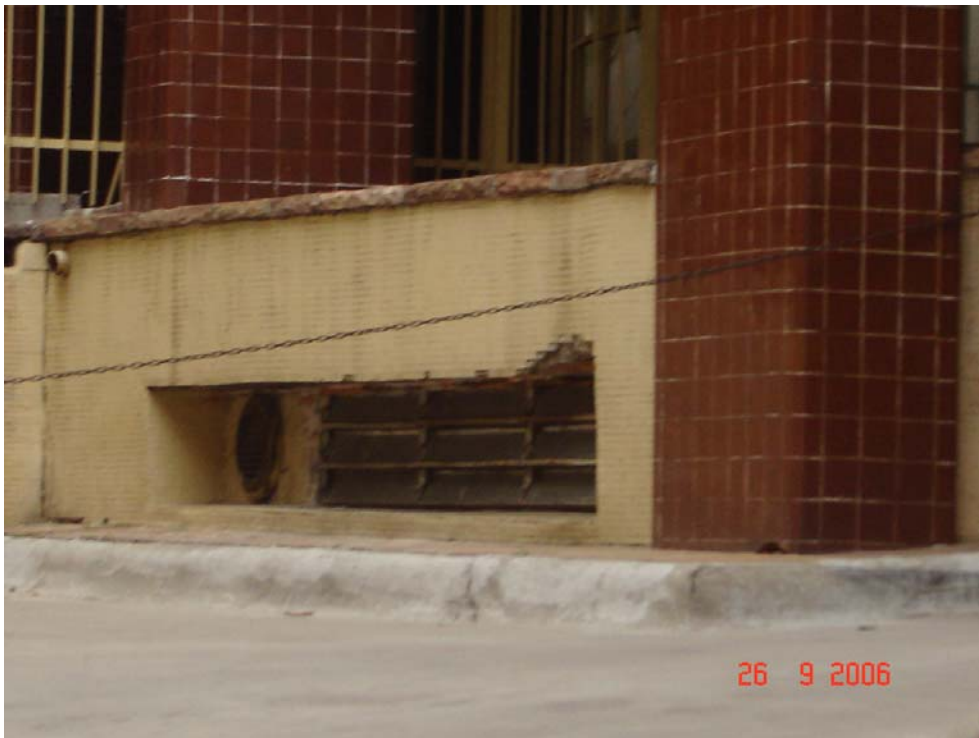
Foto 5.5.5 – Ausência de reconstrução da alvenaria e conseqüente aplicação de revestimento.
