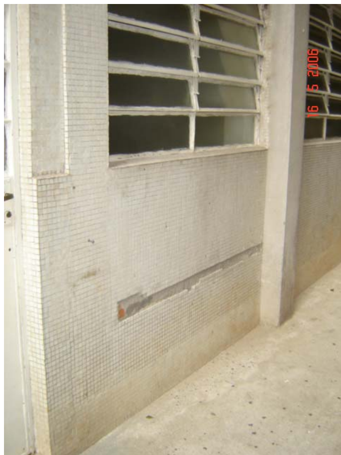
Foto 5.8.3 – Degradação dos revestimentos de pastilha cerâmica.
