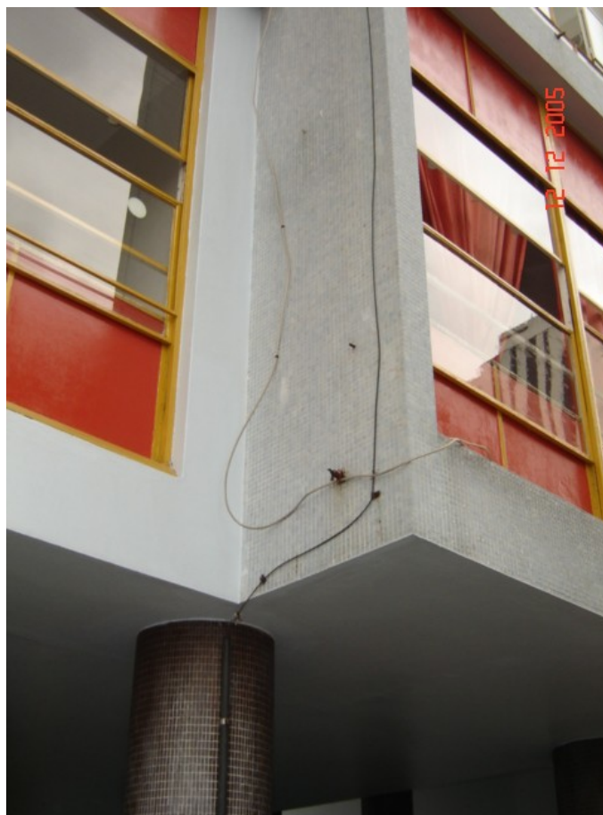
Foto 5.8.4. – Degradação pontual dos revestimentos externos tipo pastilha cerâmica, para instalação de cabos de televisão.
