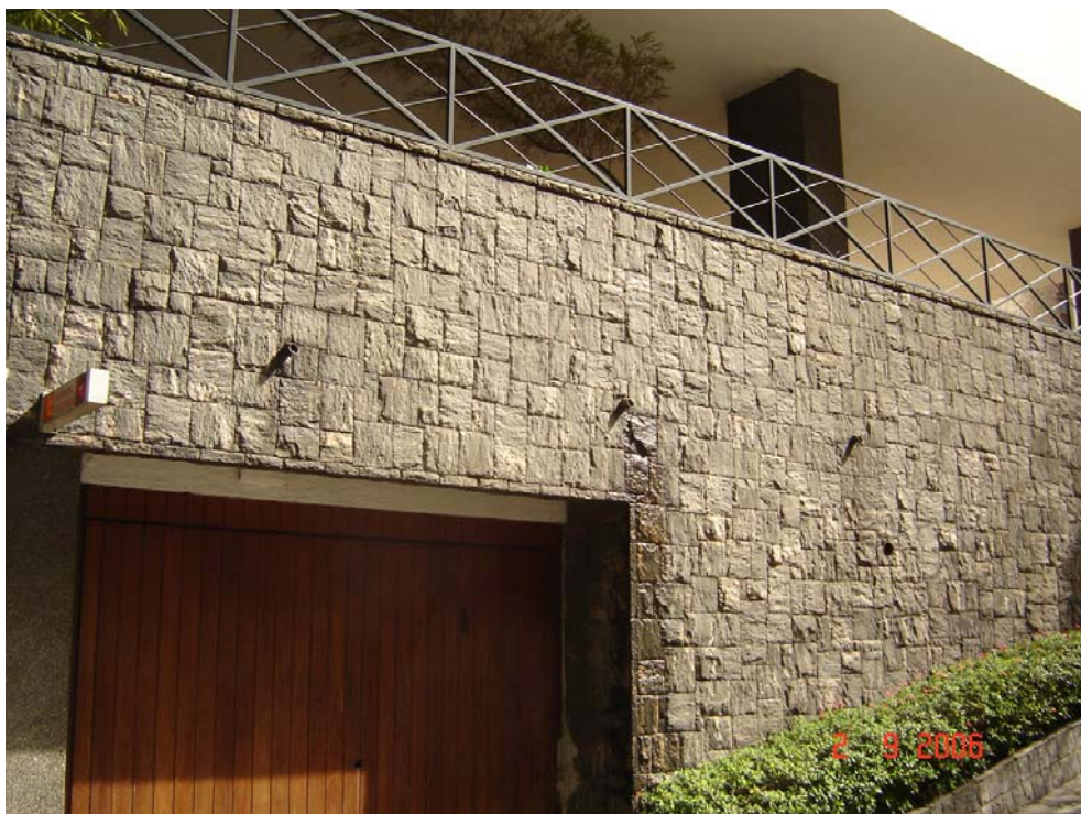
Foto 5.10.3 - Drenagem das floreiras localizadas ao longo da rua Aracajú através de buzinetes despejando água sobre a calçada.
