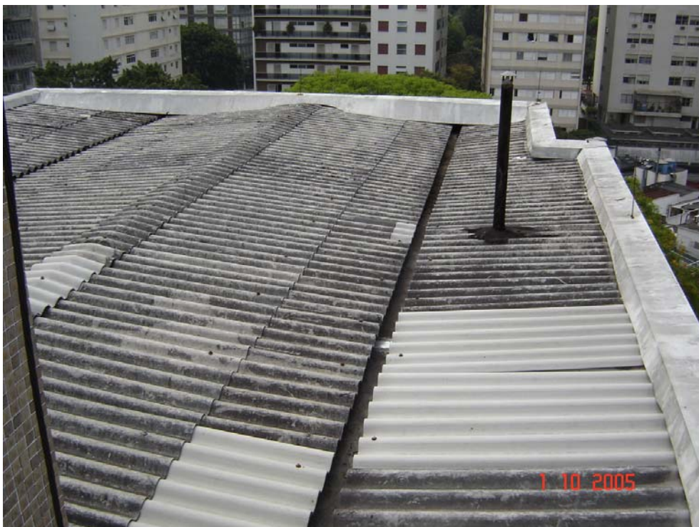
Foto 5.4.3. – Telha com recobrimento insuficiente sobre a calha.
