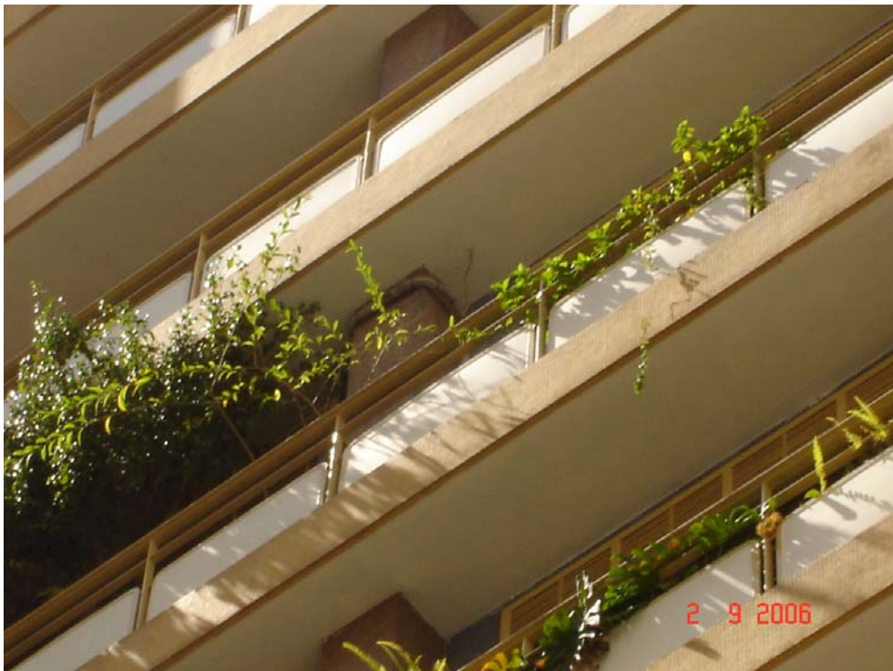
Foto 5.9.7 - Aspecto visual deficiente das instalações elétricas aparentes envolvendo o pilar localizado no terraço.
