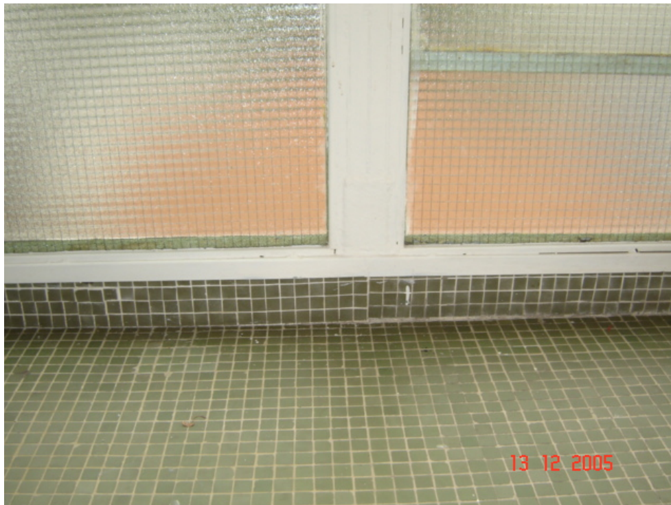
Foto 5.8.5. – Redução da caixilharia da cozinha e área de serviço para eliminar o contato da mesma com o piso.
