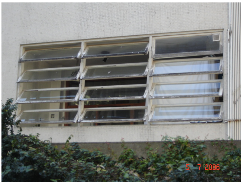
Foto 5.7.4 – Degradação da caixilharia de madeira localizada na cozinha do apartamento Nº 21.
