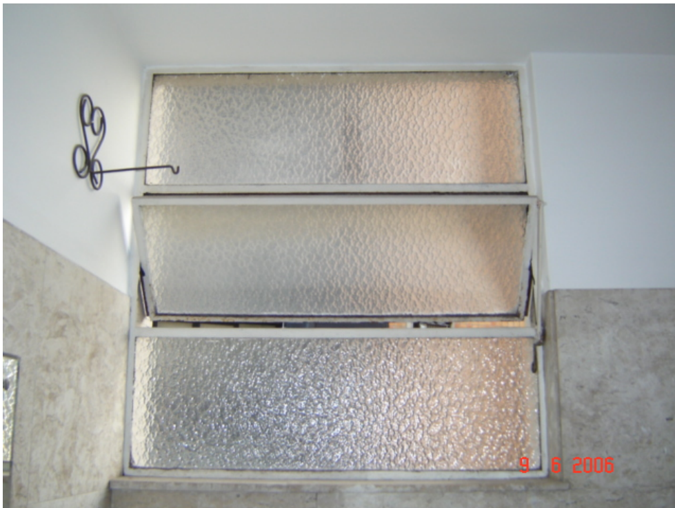
Foto 5.7.4 – Degradação da caixilharia de chapa de ferro dobrada.
