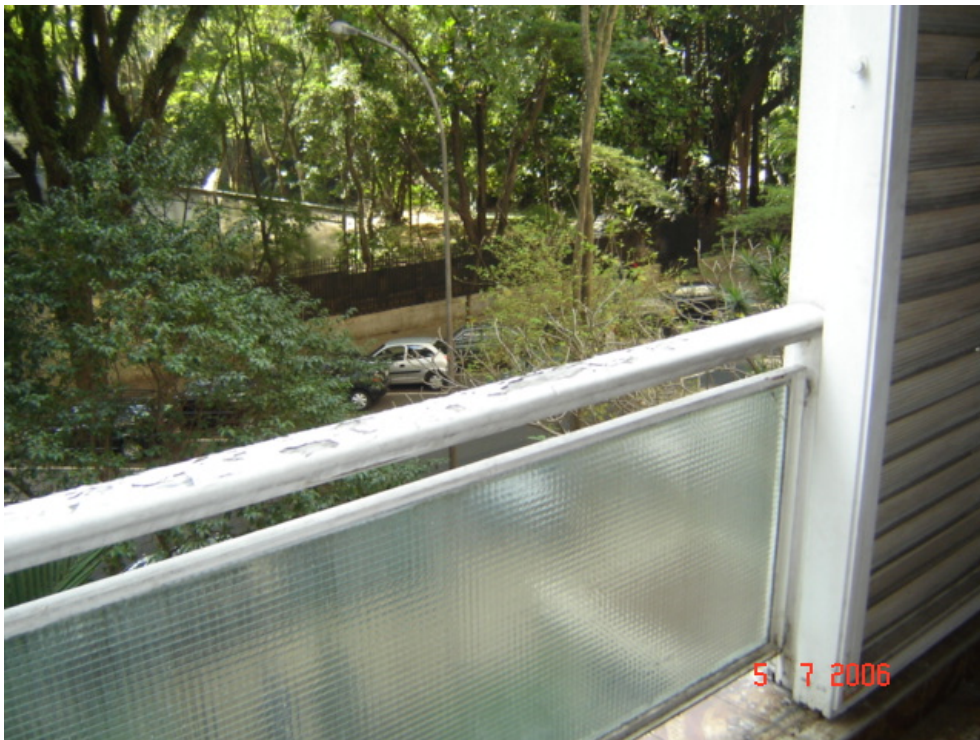
Foto 5.7.19 – Degradação da pintura de esmalte sintético da caixilharia de madeira.
