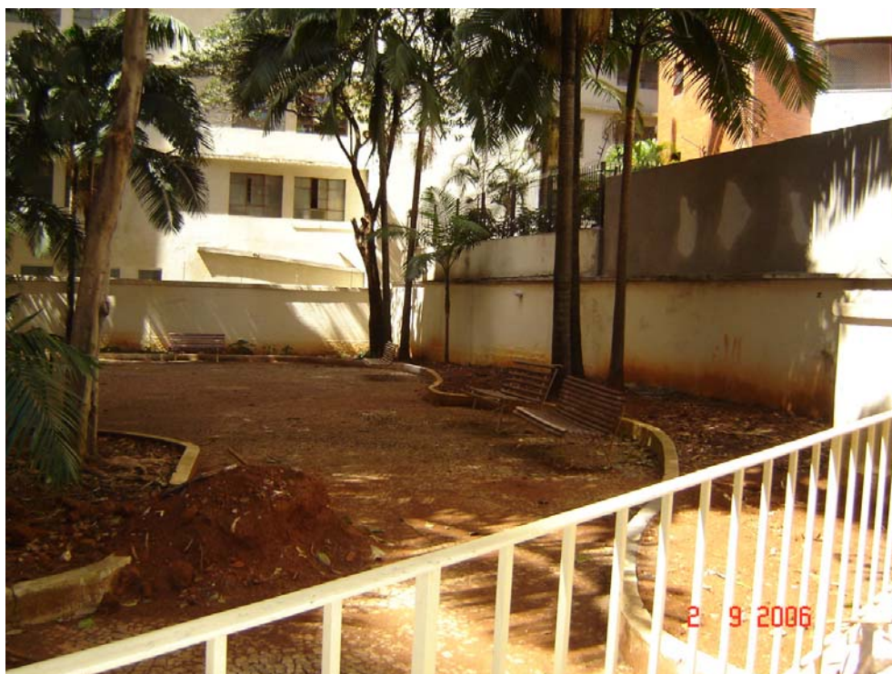
Foto 5.8.3 – Degradação da pintura Látex tipo PVA dos muros de fechamento do terreno.
