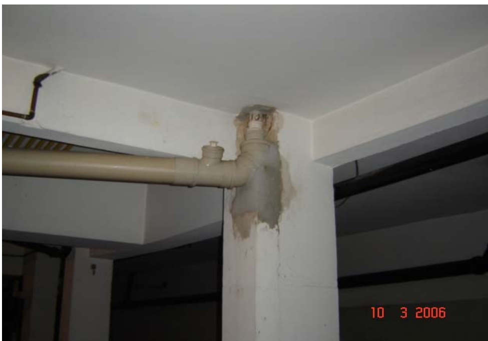
Foto 5.3.1 - Destruição parcial da extremidade superior do pilar.
