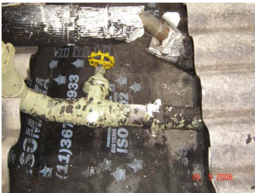
Foto 5.4.1 – Restauro inacabado da calha central impermeabilizada.
