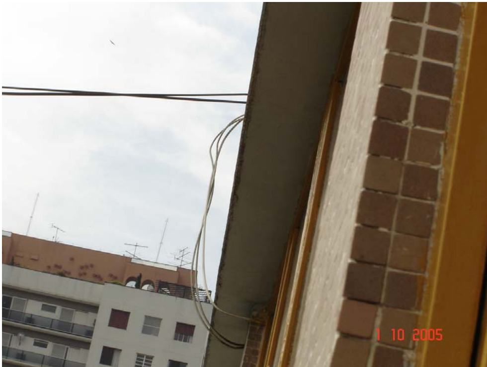
Foto 5.9.1. – Fiação de antena coletiva aérea do bloco B para o bloco A.
