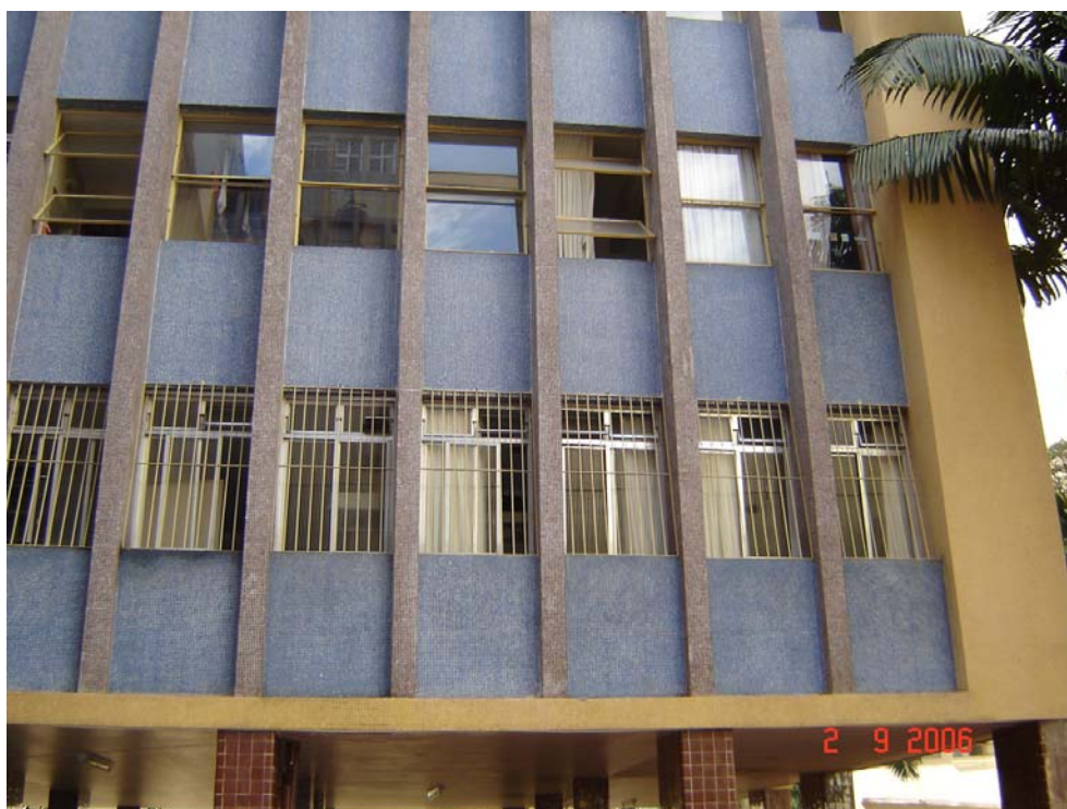
Foto 5.7.2 – Substituição de caixilharia por outra de material e desenho fora da especificação original do projeto.
