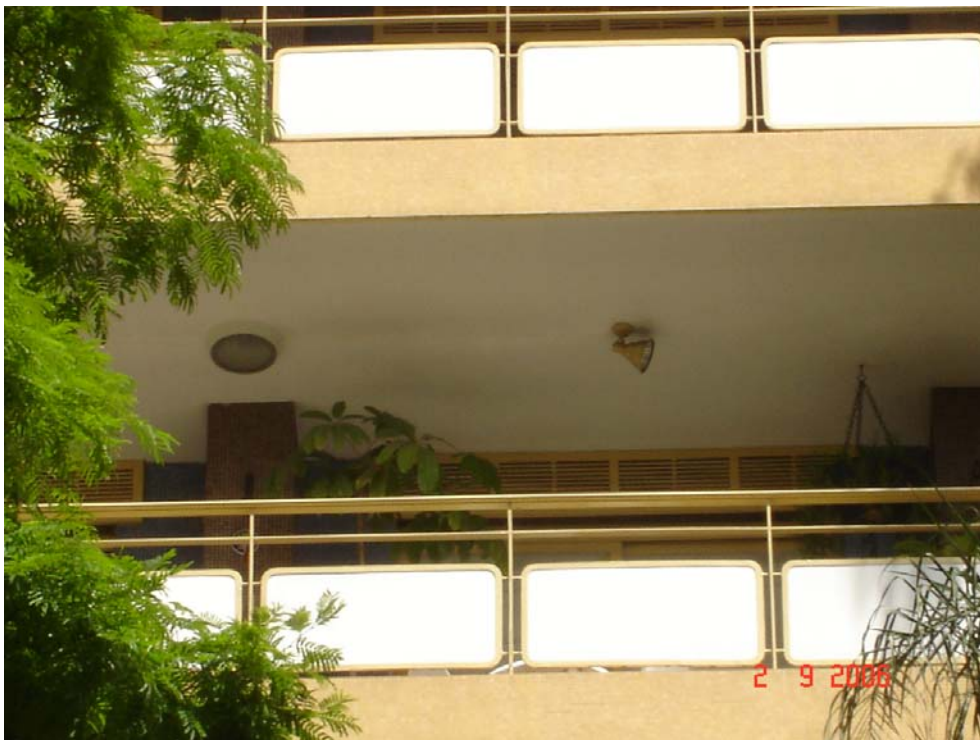
Foto 5.9.8 - Aspecto visual deficiente com a instalação de luminária sem respeitar as especificações de projeto.
