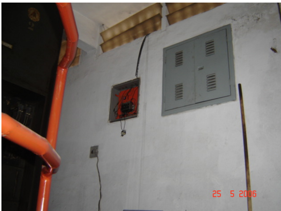
Foto 5.9.3 - Aspecto visual deficiente das instalações elétricas aparentes.
