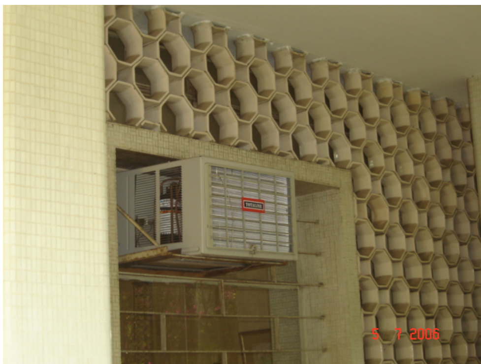
Foto 5.9.7 - Aspecto visual deficiente com a instalação de aparelho de ar condicionado diretamente na grade de segurança.
