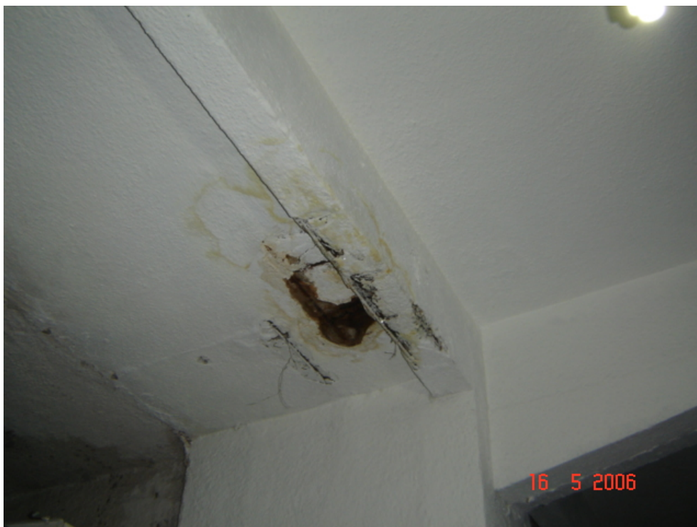
Foto 5.3.1 – Ferragem exposta em viga localizada no subsolo.
