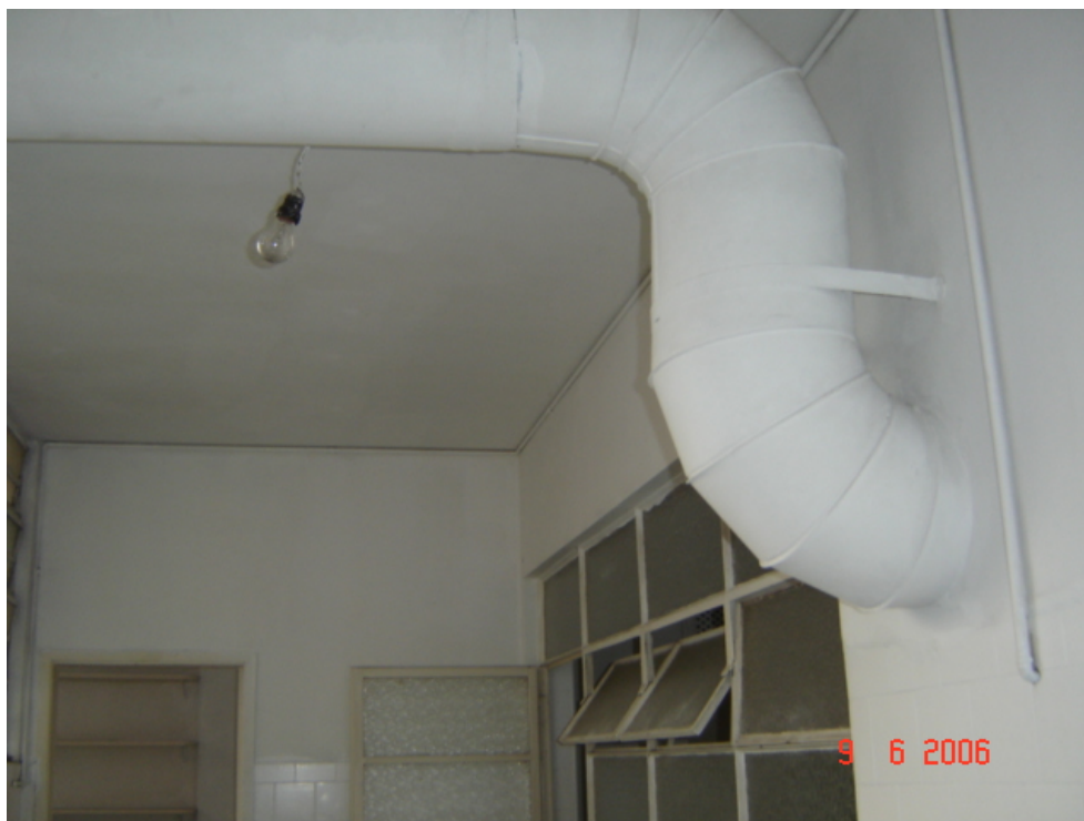
Foto 5.9.4 - Aspecto visual deficiente das instalações para exaustão da cozinha.
