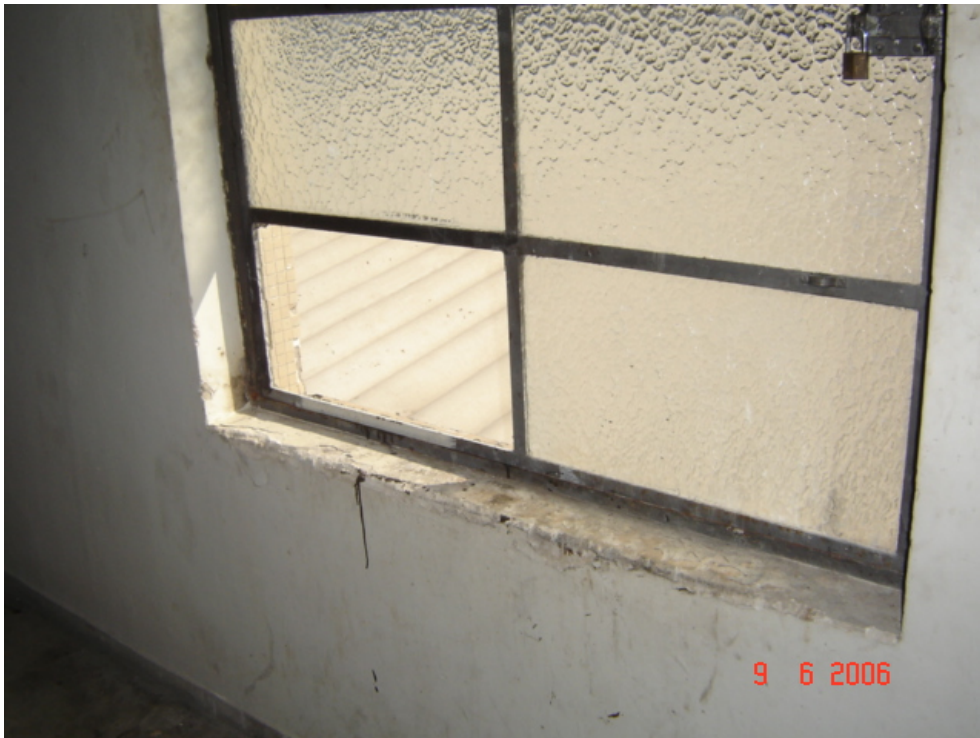
Foto 5.7.10 – Degradação da pintura da caixilharia de chapa de ferro dobrada.
