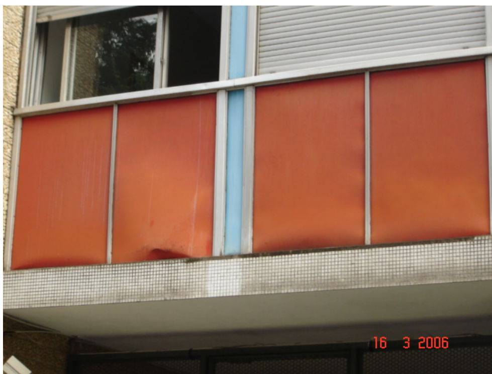
Foto 5.7.5 - Degradação dos painéis metálicos de composição da caixilharia referente à fachada dos dormitórios.
