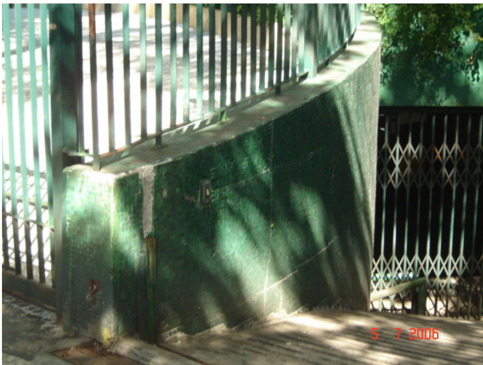
Foto 5.8.2 – Ausência de pastilha cerâmica nas muretas que definem as floreiras e as rampas para automóveis.
