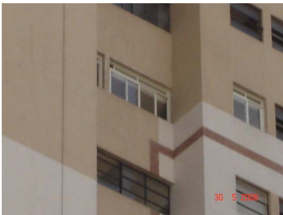
Foto 5.5.4 – Construção indevida de alvenaria interferindo no projeto original da fachada Sudeste.
