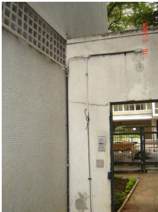
Foto 5.8.1 – Fixação generalizada de eletrodutos de instalações elétricas sobre as alvenarias revestidas com pastilha cerâmica.
