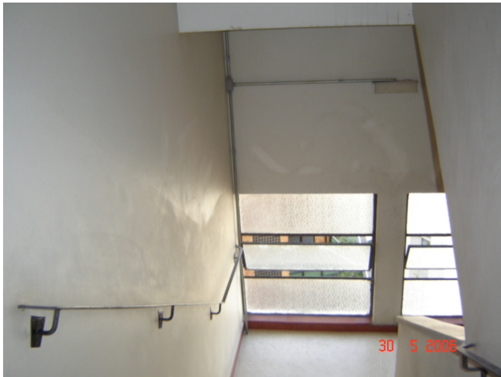
Foto 5.9.1 - Aspecto visual deficiente das instalações elétricas aparentes.
