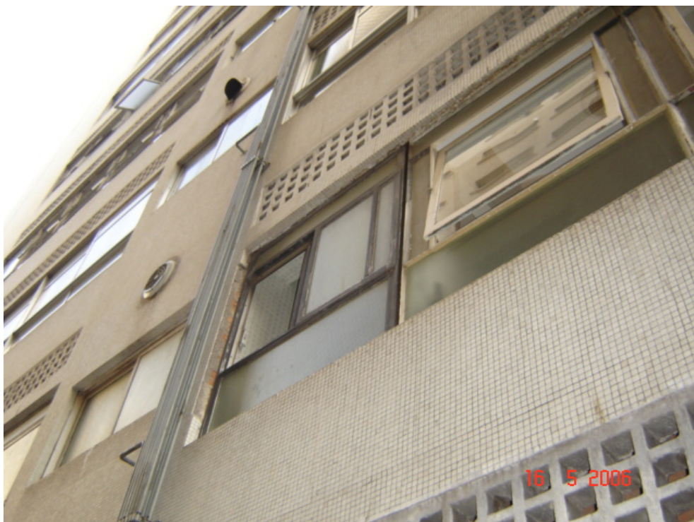
Foto 5.5.6 - Ausência de reconstrução da alvenaria.
