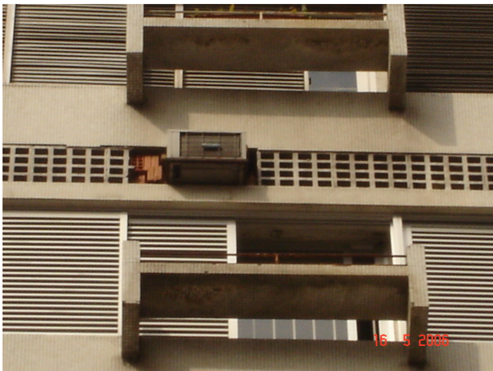
Foto 5.5.4 - Reconstrução inadequada do vedo de elemento vazado.
