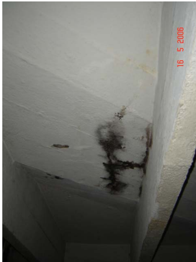
Foto 5.3.1 – Infiltrações generalizadas nas lajes do pavimento térreo.
