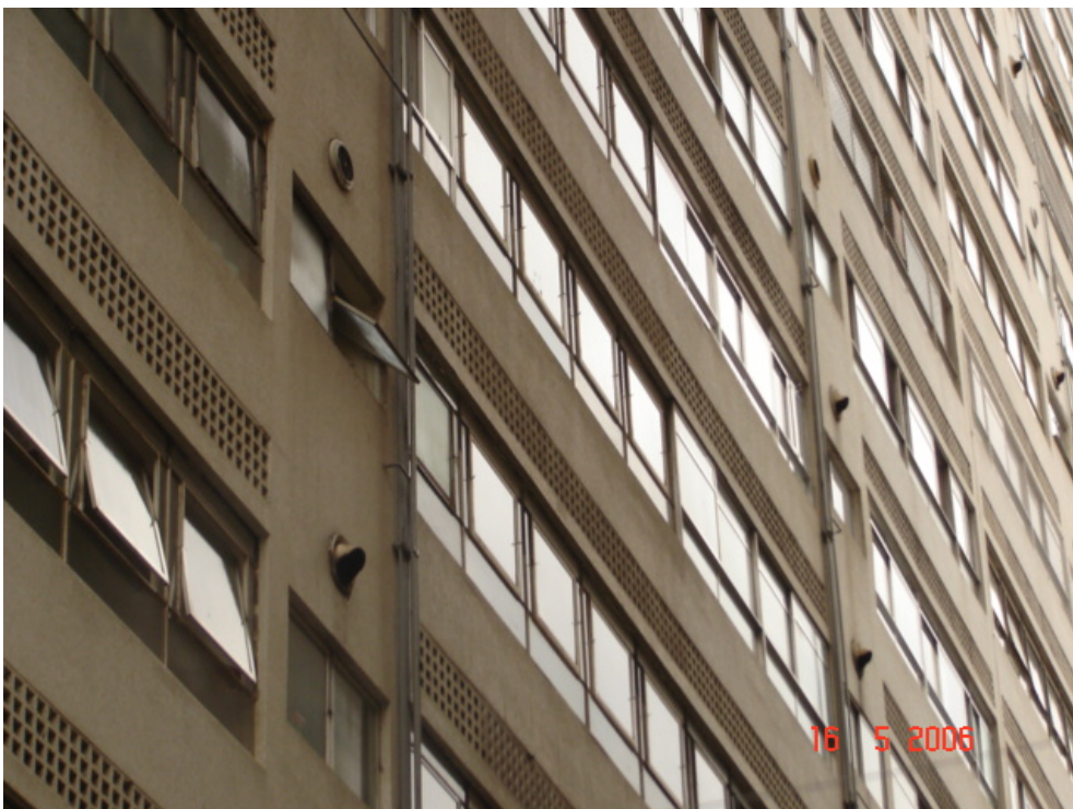
Foto 5.9.8 - Ausência de padronização dos dutos de exaustão para coifa de fogão.
