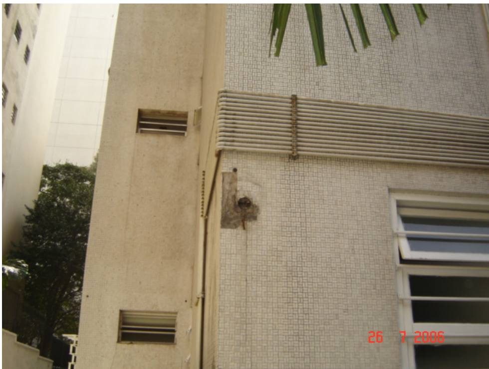
Foto 5.8.6 – Carência de restauro e reposição de pastilha cerâmica.
