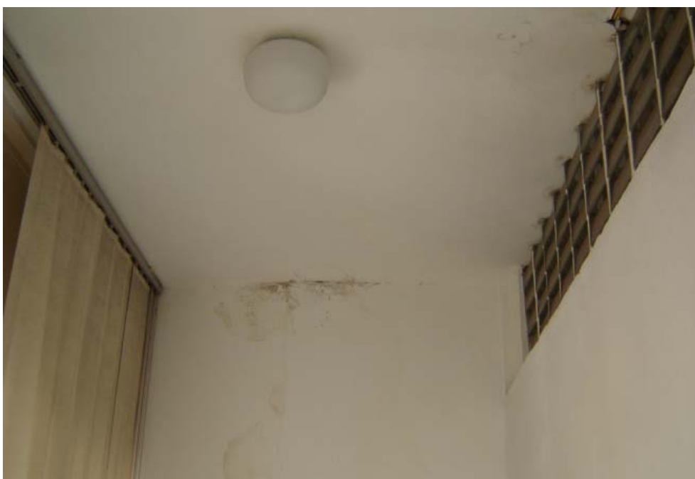
Foto 5.8.6. – Degradação localizada da pintura nas paredes e tetos dos apartamentos abaixo da cobertura.
