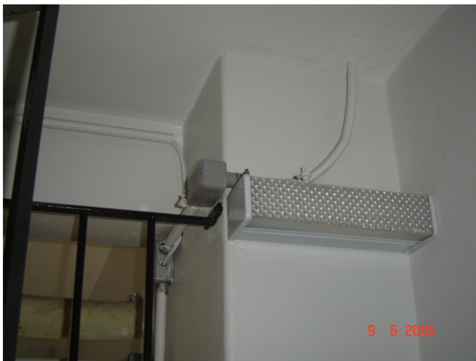
Foto 5.9.2 - Aspecto visual deficiente das instalações elétricas aparentes.
