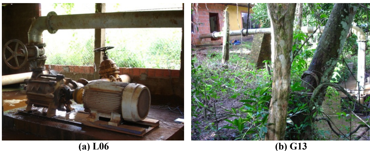
Figura 5.8. – Tubulação de sucção dos pivôs L06 (a) e G13 (b) do Assentamento Itamarati I
