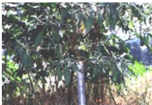
Foto 7 – Planta vegetando sobre dreno de gás
