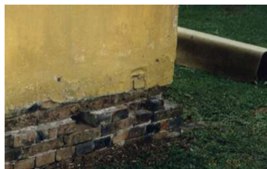
Fig. 56 : Alicerce contínuo, de alvenaria de tijolos, ao longo de todo o perímetro da casa. Antigo Curtume. Rio Negro.
