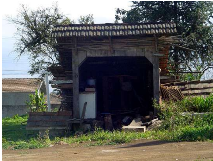
Fig. 122: Só o que restou da construção antiga foi um velho paiol, que ainda encontra-se aos fundos do terreno.
