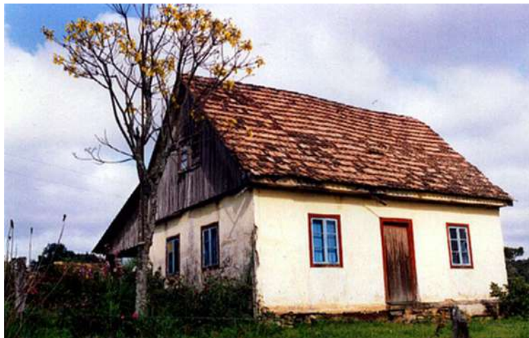
Fig.33: Casa abandonada em Mafra. Abril, 2001.
