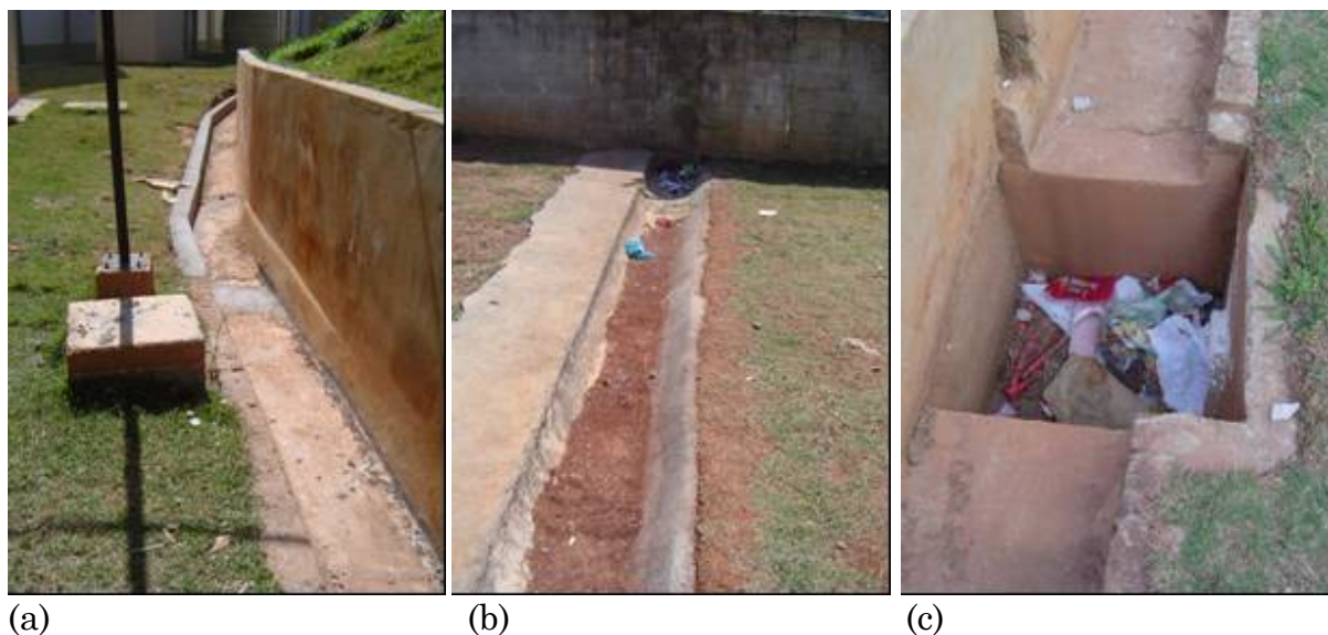
Figura 26 [Pc 1.1] – Obstrução e assoreamento das canaletas e caixas do sistema de drenagem externo
