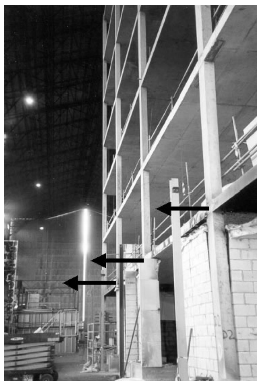
Figura 2.5.2 Deslocamento lateral das colunas externas observado em um ensaio de uma estrutura de concreto em Cardington, UK (Bailey, 2002).
