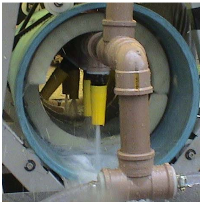
Figura 6.14 – Aspecto do funcionamento dos esguichos de limpeza.
