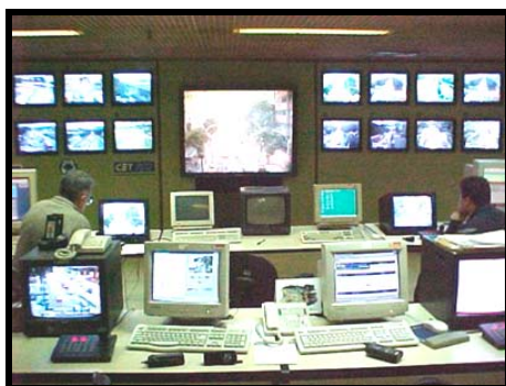
Figura 3.2. Sala do Centro de Controle de Tráfego por Área.
