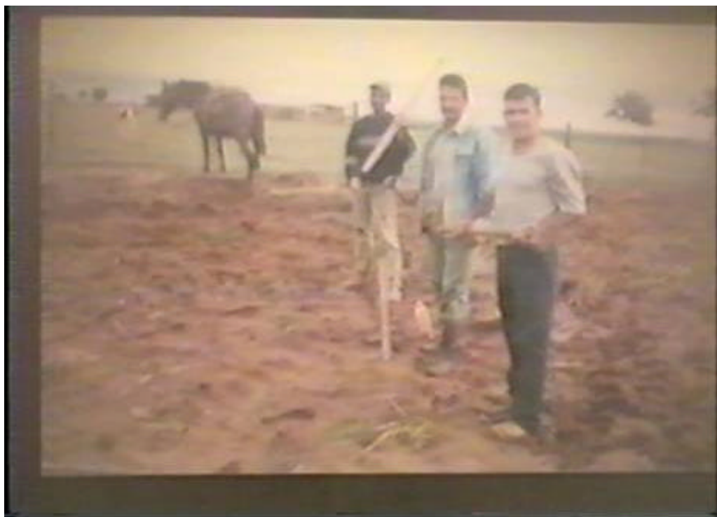
(ordem da direita para a esquerda: Gerson, Sidnei, Gustavo: medindo o terreno para a construção da congregação “Monte Sião”)
