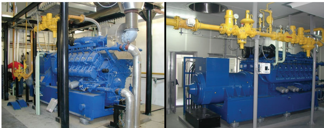
Figura 3.4: Fotos de um motor a gás operando num sistema de cogeração.
