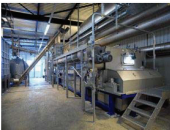
Instalação BDS em Wohlen, Suíça
