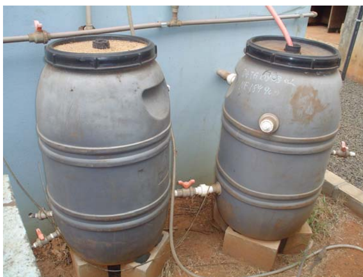
Figura 4.3: Fotografia do reservatório intermediário
