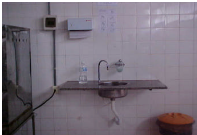
Figura 6: Lavatório exclusivo para a higiene das mãos instalado com a obra finalizada em 2005 na UAN do CEFET-Urutaí-GO.
