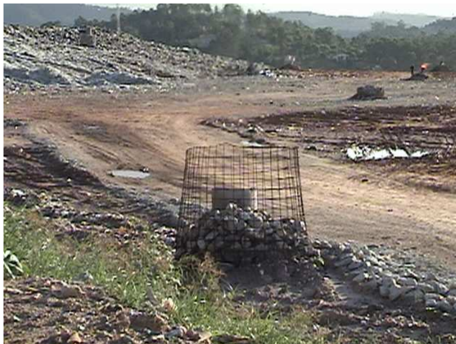
Figura 3.7 – Sistema de captação de metano. Aterro Bandeirantes.
