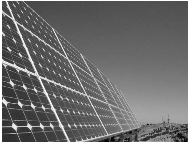
Figura B.8: Painel FV em operação.
