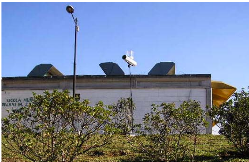
FOTO 44 – TRIPÉ NO LOCAL DA MEDIÇÃO DA TEMPERATURA AMBIENTE . FONTE: AUTORIA PRÓPRIA (2007)
