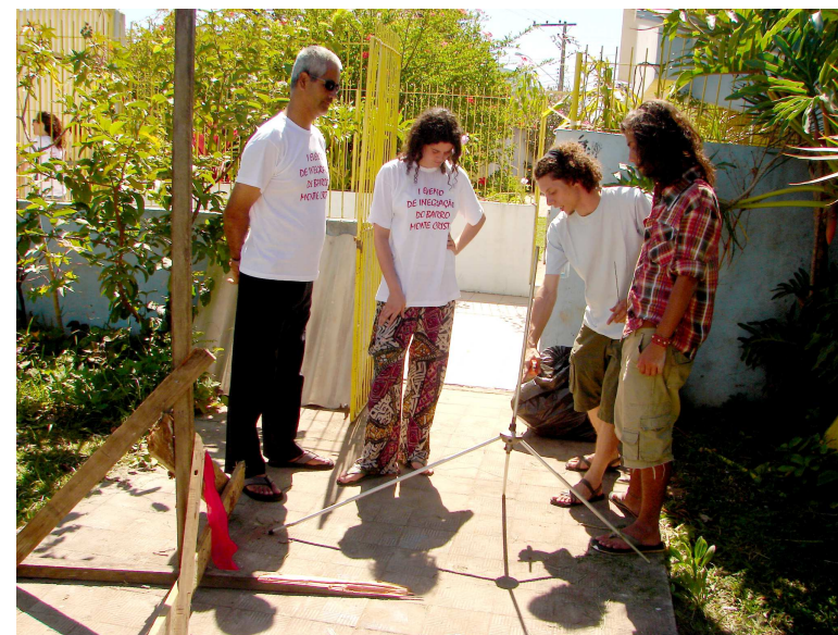
Imagem 31: Montando a antena de transmissão, ao lado da estrutura de madeira construída naquele momento.
